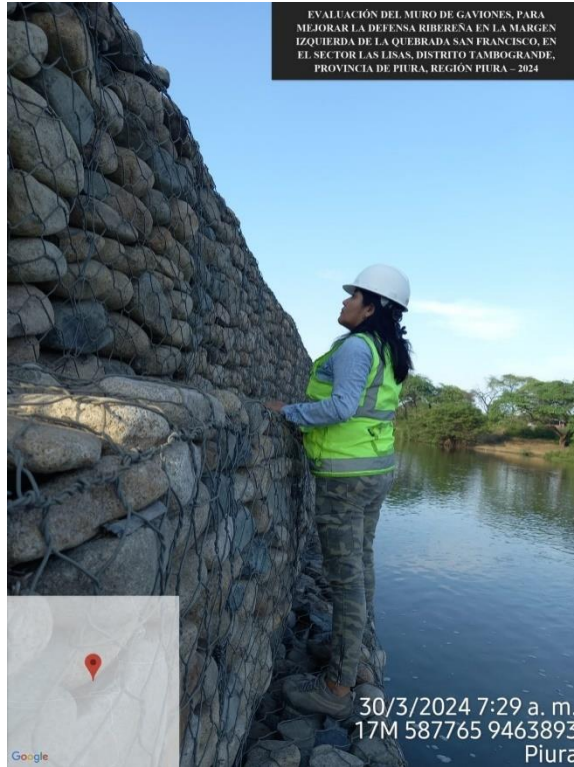
Figura 24: Realizando observaciones en función al estado del muro de gaviones, elaboración propia, 2024.
