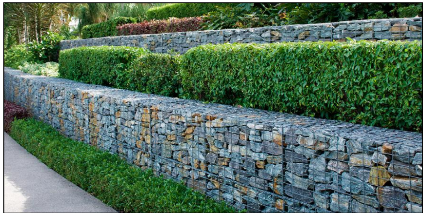
Figura 1: Muro de gaviones
