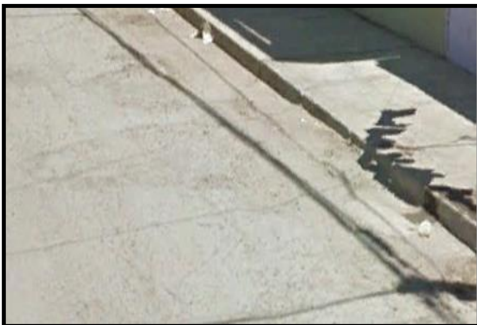
Gráfico N° 65: Calzada con falla de parches, peladura, corrugación y baches. Fuente: Propia.
