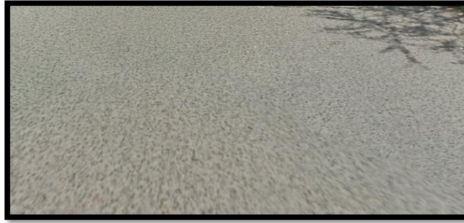
Gráfico N° 28: Peladura por intemperismo y desprendimientos de agregados.
