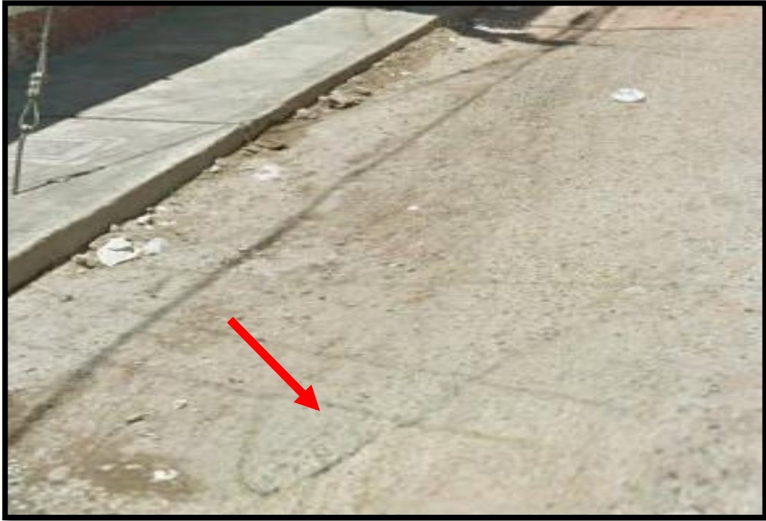
Grafico N° 43: Presentación de fisura parabólica o por deslizamiento de severidad alta. Fuente: Propia.
