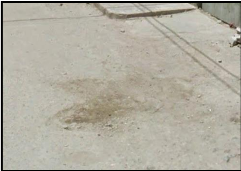
Gráfico N° 67: Calzada con falla de baches. Fuente: Propia.
