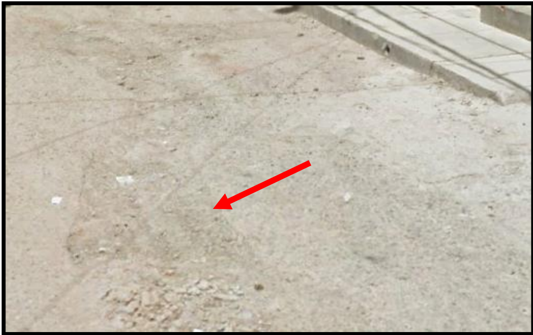
Grafico N° 44: Presentación de fisura bache de severidad alta. Fuente: Propia.
