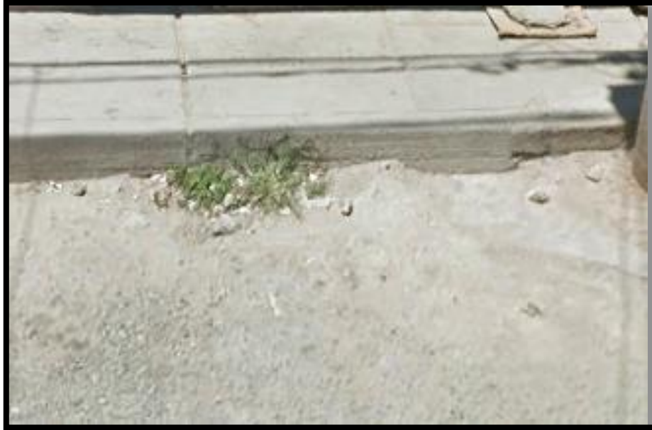
Gráfico N° 62: Calzada con falla de baches, corrugación.
