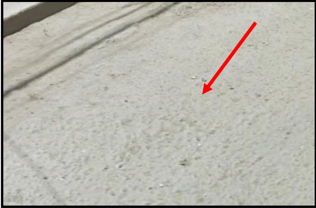
Grafico N° 35: Presentación de peladura por intemperismo de severidad media. Fuente: Propia.
