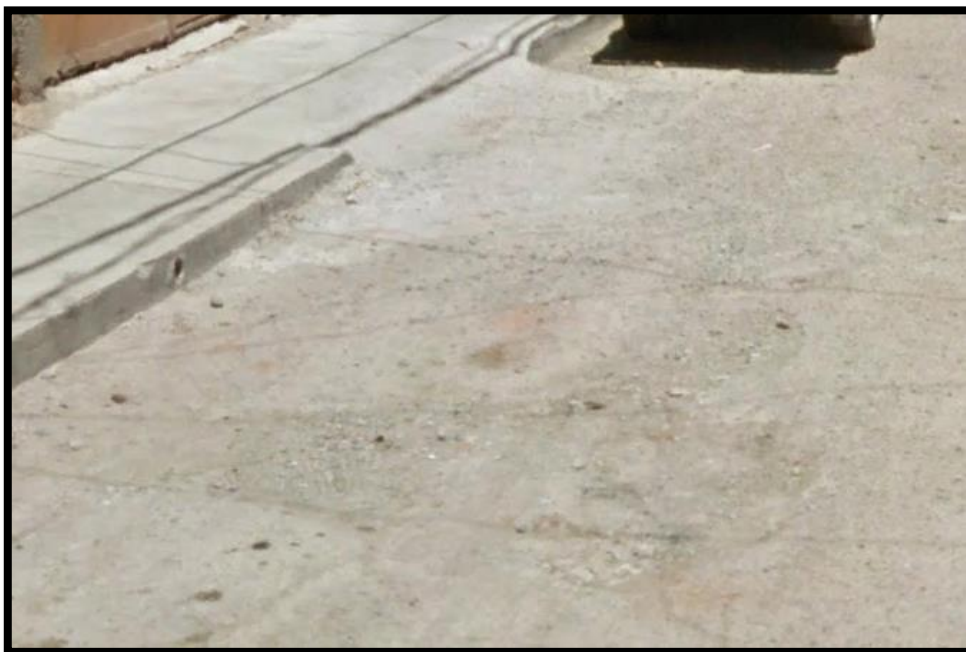
Gráfico N° 64: Calzada con falla de peladura y baches. Fuente: Propia.
