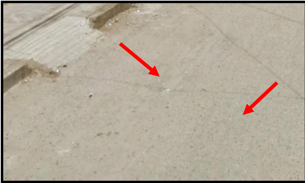
Grafico N° 56: Presentación de bache y peladura de media severidad.
