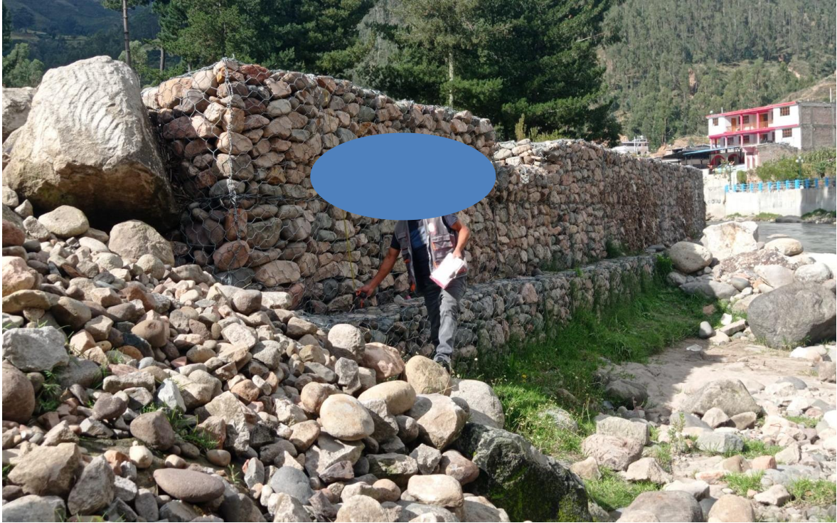
Figura 17: Deslizamiento de gaviones y rocas
