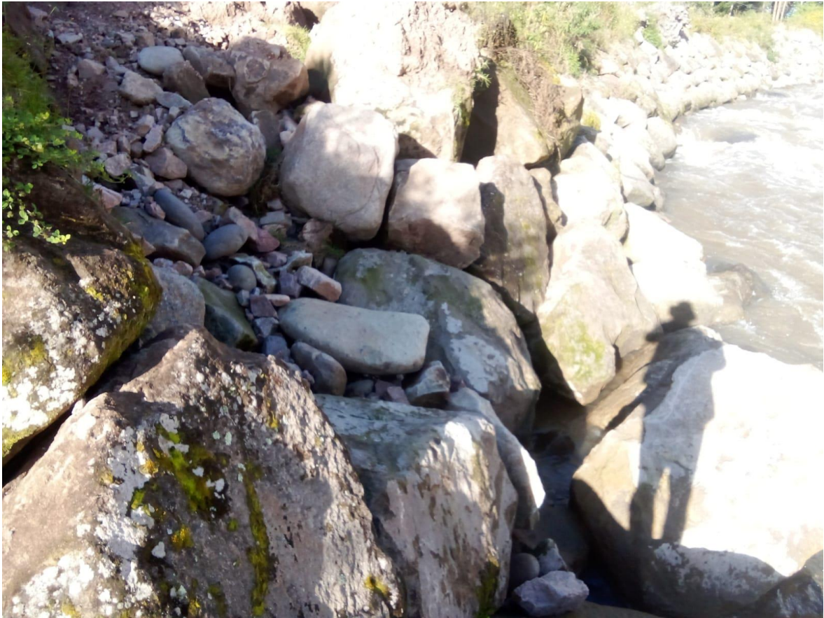
Figura 10: Rocas desordenadas producto del aumento de caudal
