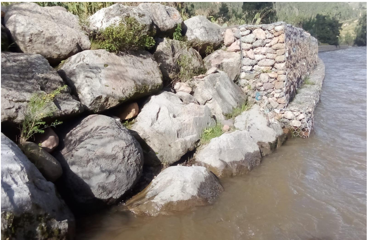
Figura 14: Enrocado y defensa tipo caja
