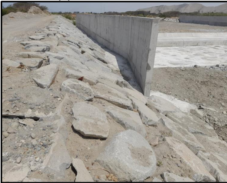
Figura 69: Enrocado sin recubrimiento de concreto Fuente: Elaboración propia
