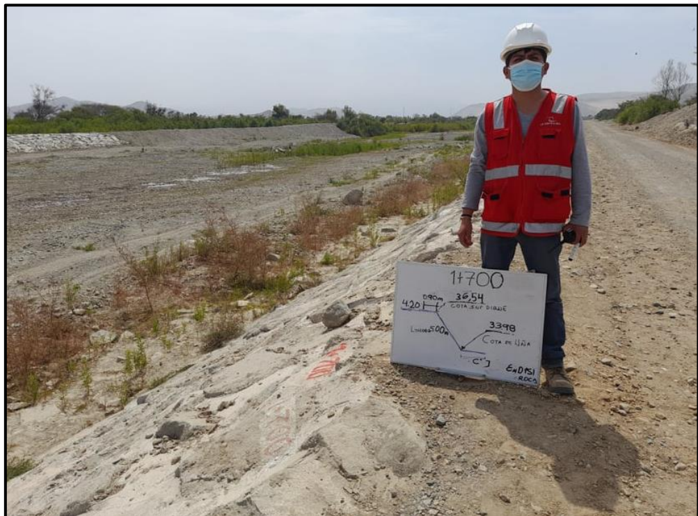
Figura 35: Evaluación del terraplén
