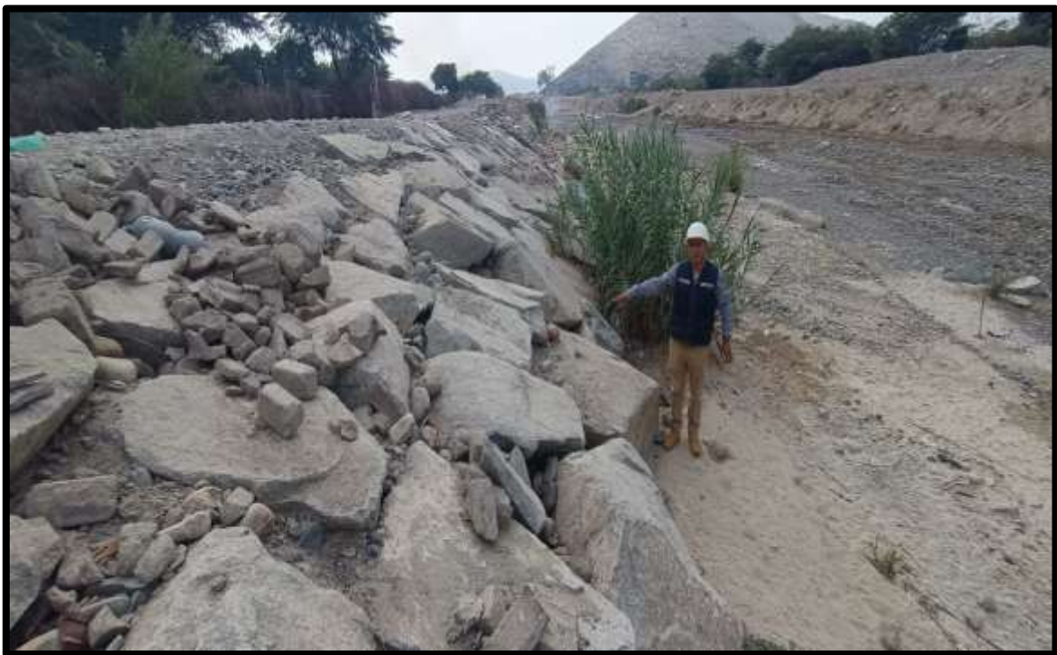
Figura 16: Se aprecia ausencia de rocas en la parte superior entre la progresiva 0+540 hasta 0+580.
