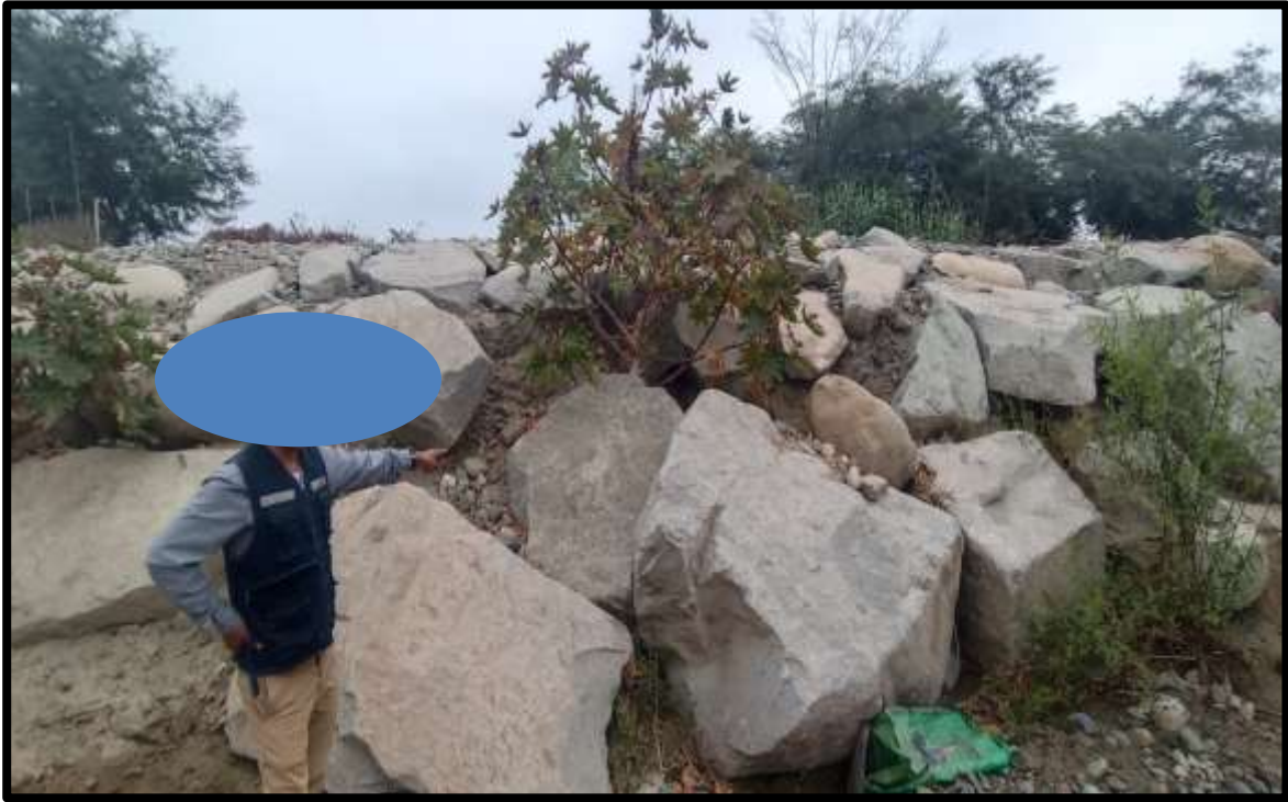
Figura 9: Se aprecia presencia de arbustos de grandes tamaños entre la progresiva 0+250 hasta 0+255.
