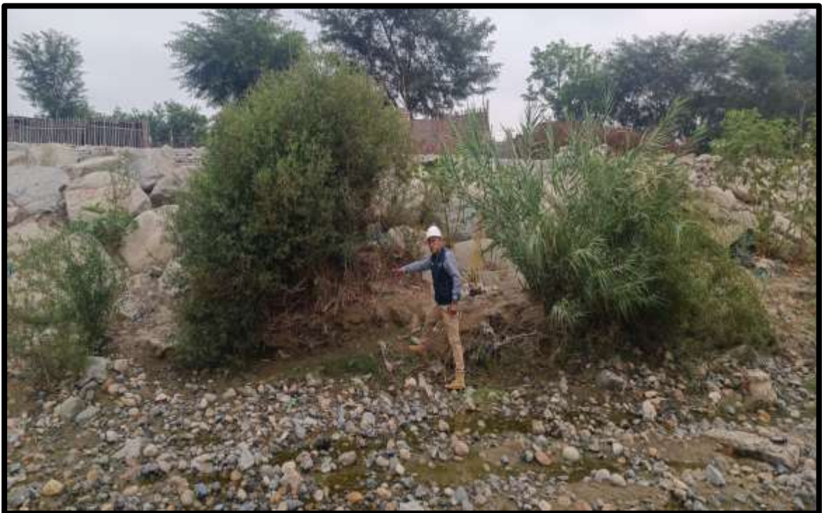
Figura 10: Se aprecia presencia de arbustos creciendo en la base ya erosionada entre la progresiva 0+300 hasta 0+305.
