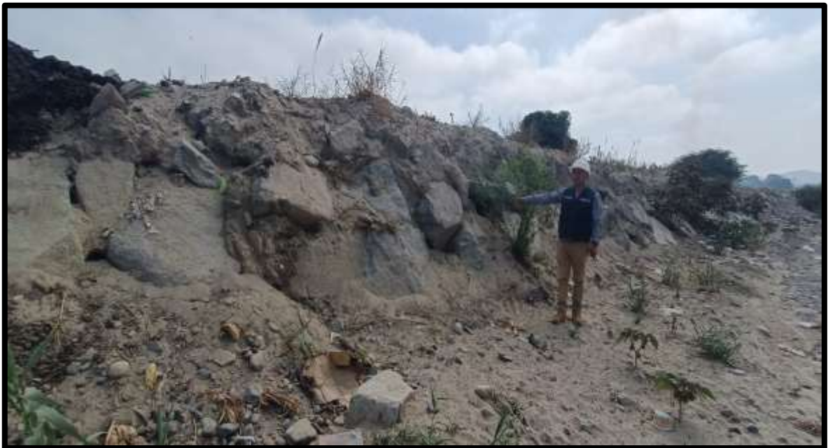
Figura 12: Se aprecia socavación en el talud del dique donde se colocó el enrocado entre la progresiva 0+330 hasta 0+340.
