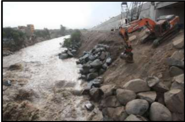
Figura 1. Estabilidad geotécnica del enrocado.
