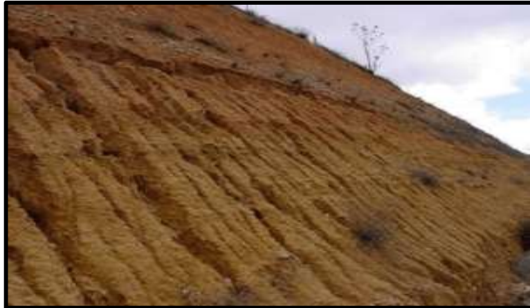
Figura 4. Erosión en un talud.
