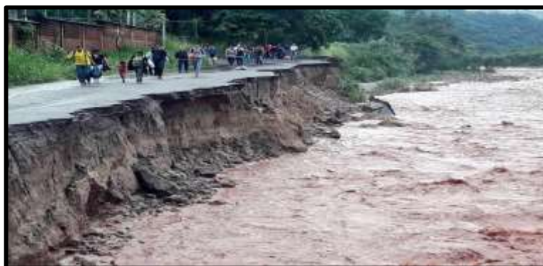
Figura 5. Socavación del terreno.
