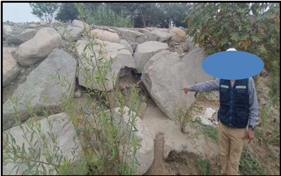
Figura 8: Se aprecia espaciamentos de gran tamaño en las juntas por rocas ya desprendidas entre la progresiva 0+220 hasta 0+230.
