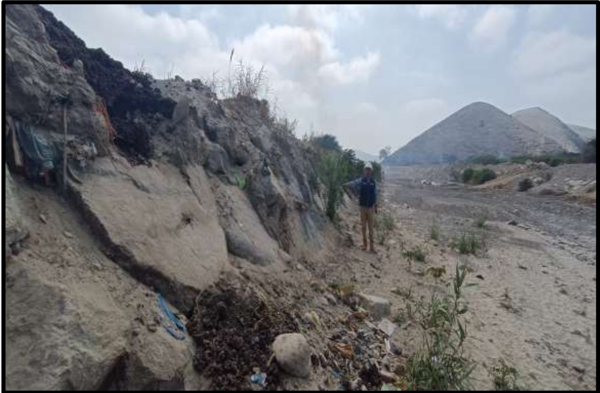
Figura 11: Se aprecia socavación en el talud del dique donde se colocó el enrocado entre la progresiva 0+320 hasta 0+330.
