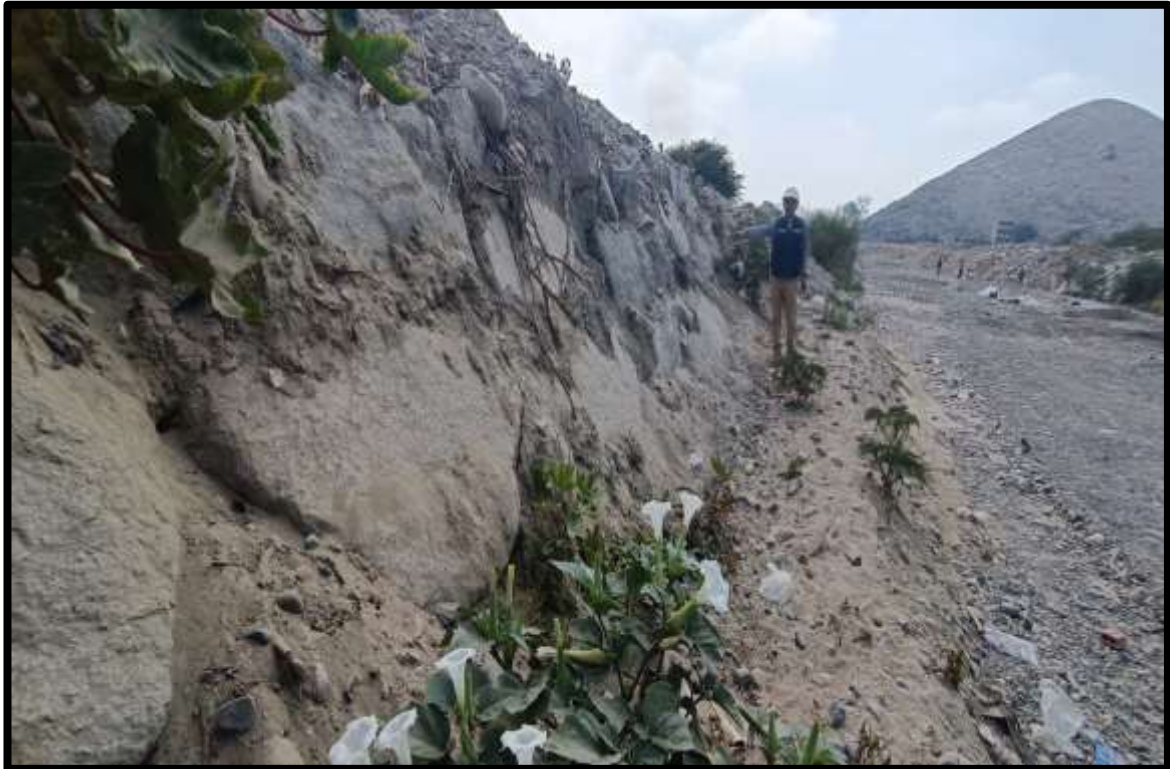
Figura 13: Se aprecia socavación en el talud del dique donde se colocó el enrocado entre la progresiva 0+340 hasta 0+350.
