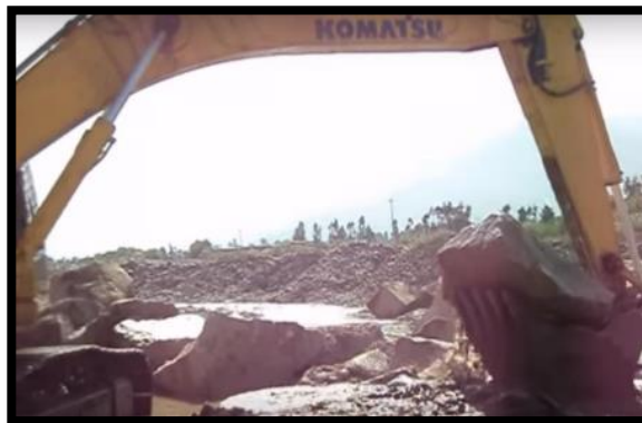
Figura 12: Defensa ribereña enrocados
