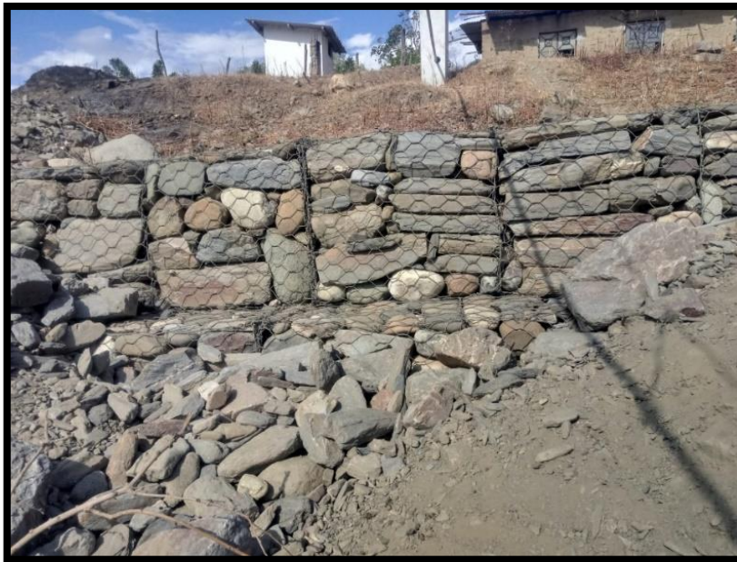
Figura 18: Muro de gavion- estado malo
