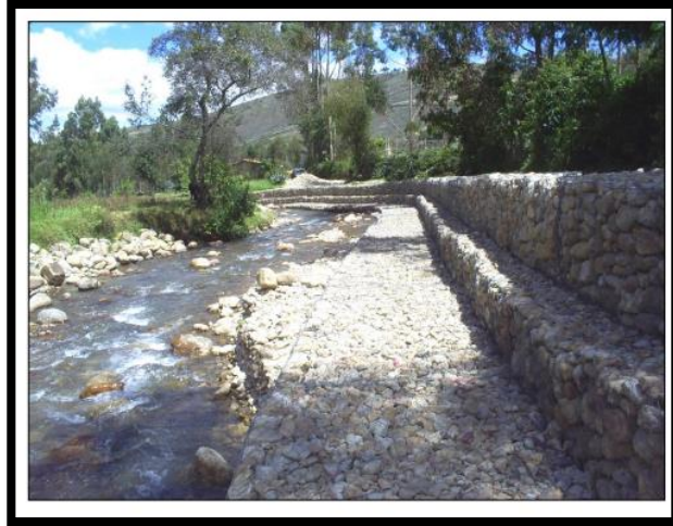
Figura 8: Defensas ribereñas gaviones
