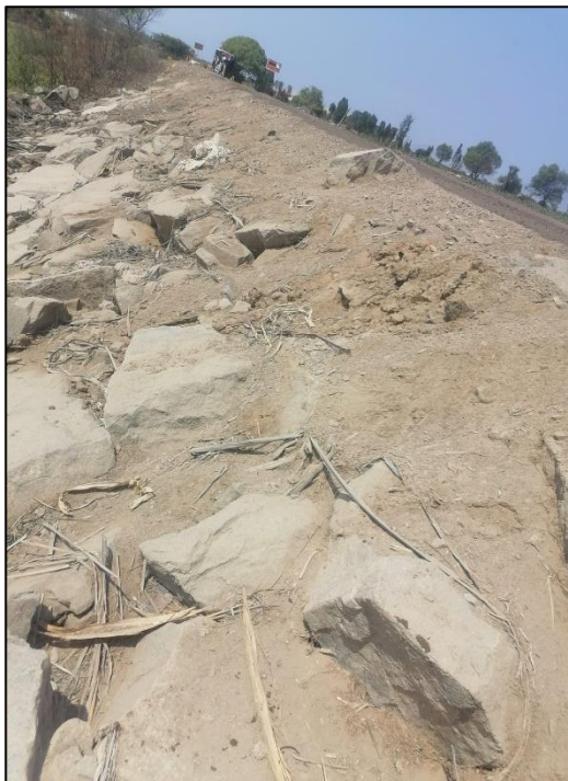
Figura 24. Desprendimiento del enrocado en el margen derecho del río Lacramarca
