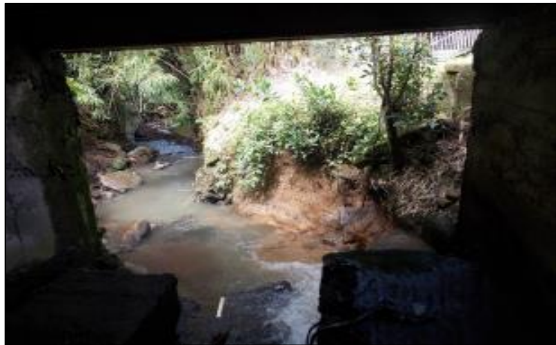
Figura 11. Socavación general por contracción en quebrada Latina
