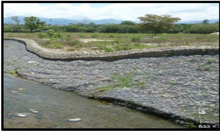
Figura 17: Erosión de los gaviones. Fuente: Extraído del libro de Vasquez, et al (28).
