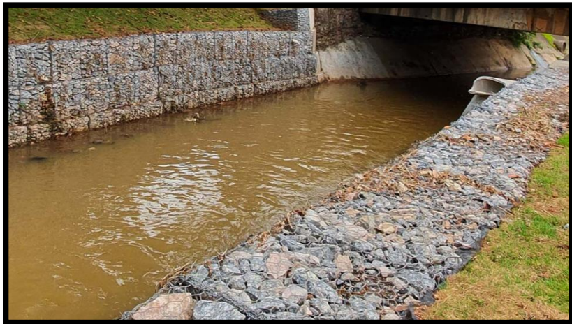
Figura 18: Corrosión de los gaviones. Fuente: Extraído del libro de Vasquez, et al (28).
