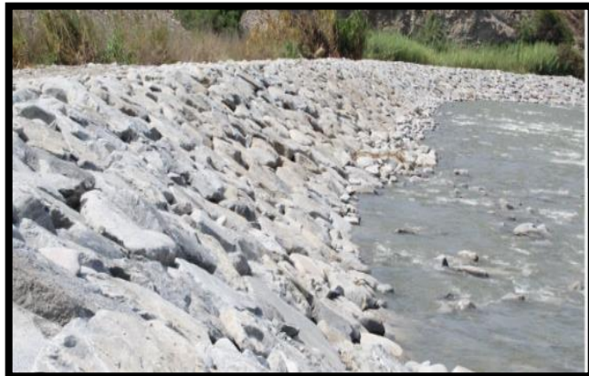
Figura 15: Defensa Ribereña Enrocado.
