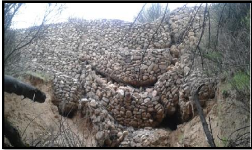
Figura 19: Pérdida de material de los gaviones. Fuente: Extraído del libro de Vasquez, et al (28).
