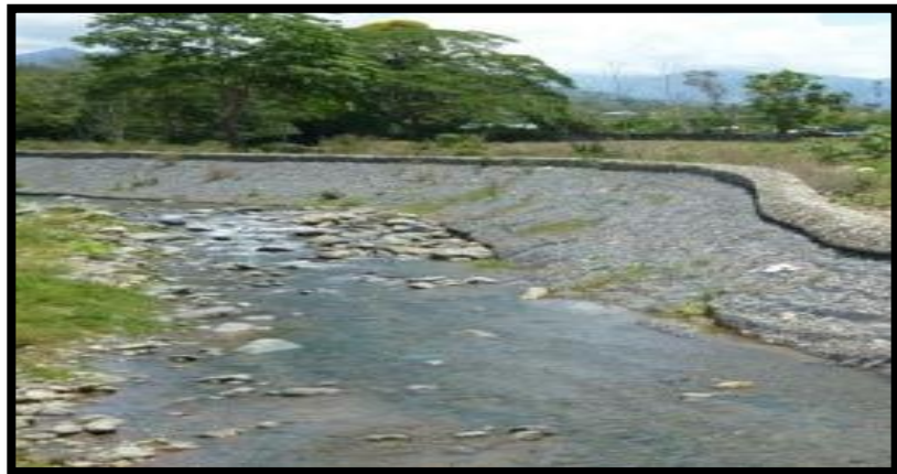
Figura 16: Colmatación de gaviones.
