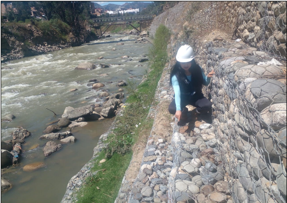
Figura 19: Se observa la vegetación y escombros en el muro del gavión.
