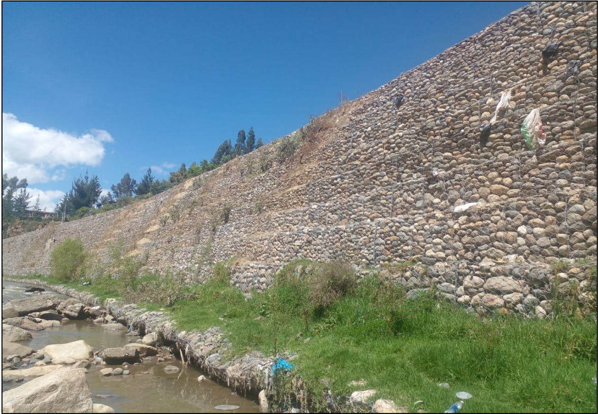
Figura 22: Vista de la socavación de colchón reno.
