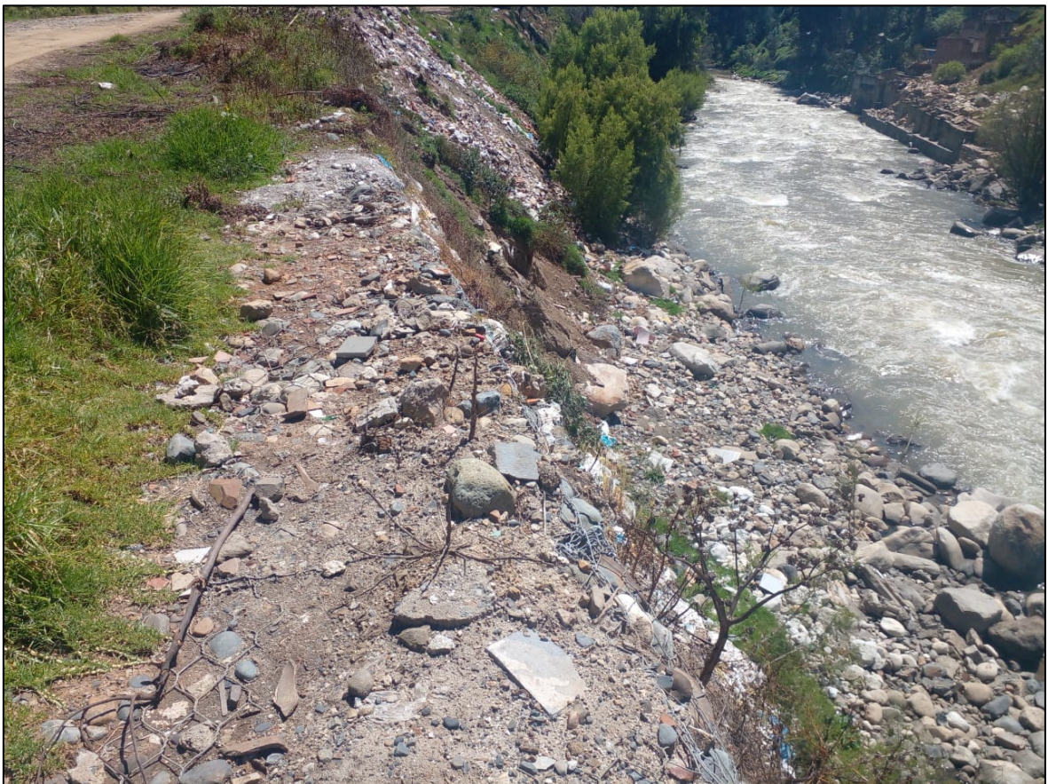
Figura 15: Vista del escombros de 10m al final del tramo del muro de gavión.
