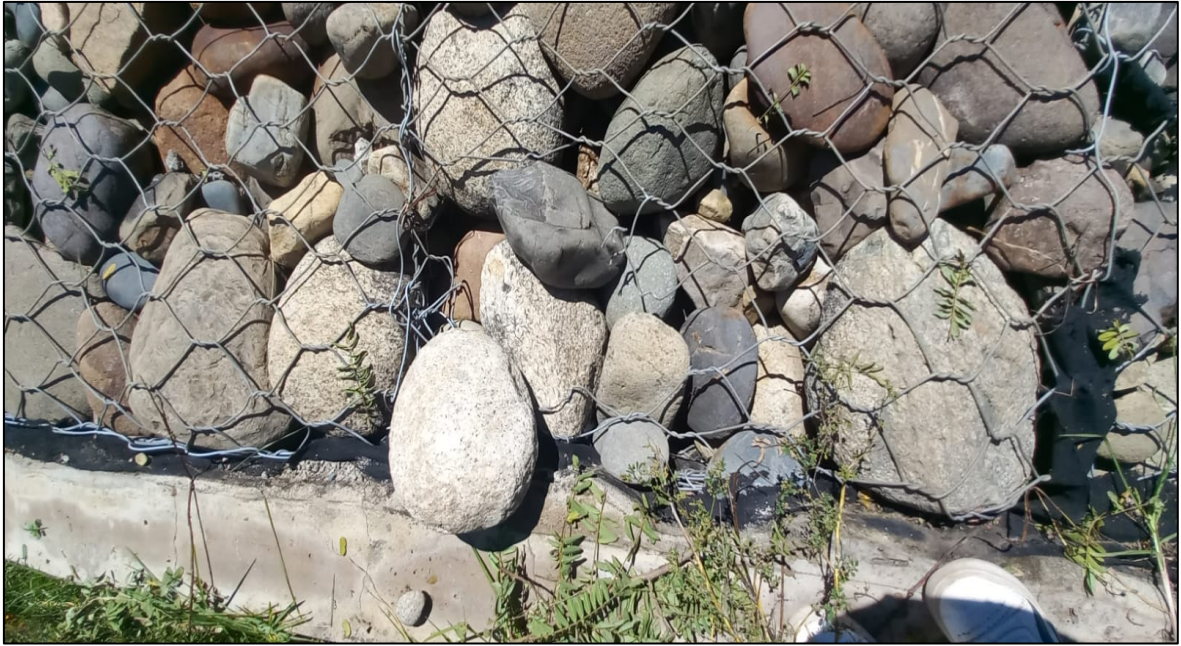
Figura 14: Rotura de la malla de la corona del muro de gaviones.
