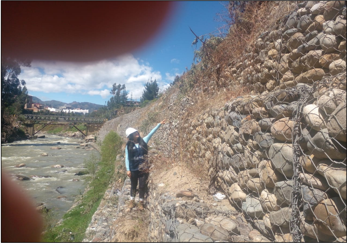
Figura 18: Escombros en el muro del gavión.
