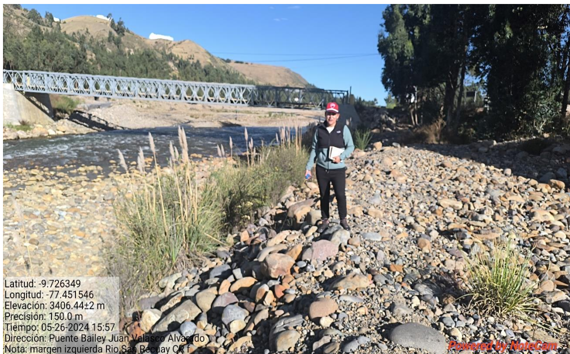
Figura N° 14: zona N° 02, Progresiva 0+023 a 0+062, no cuenta con muro de gaviones
