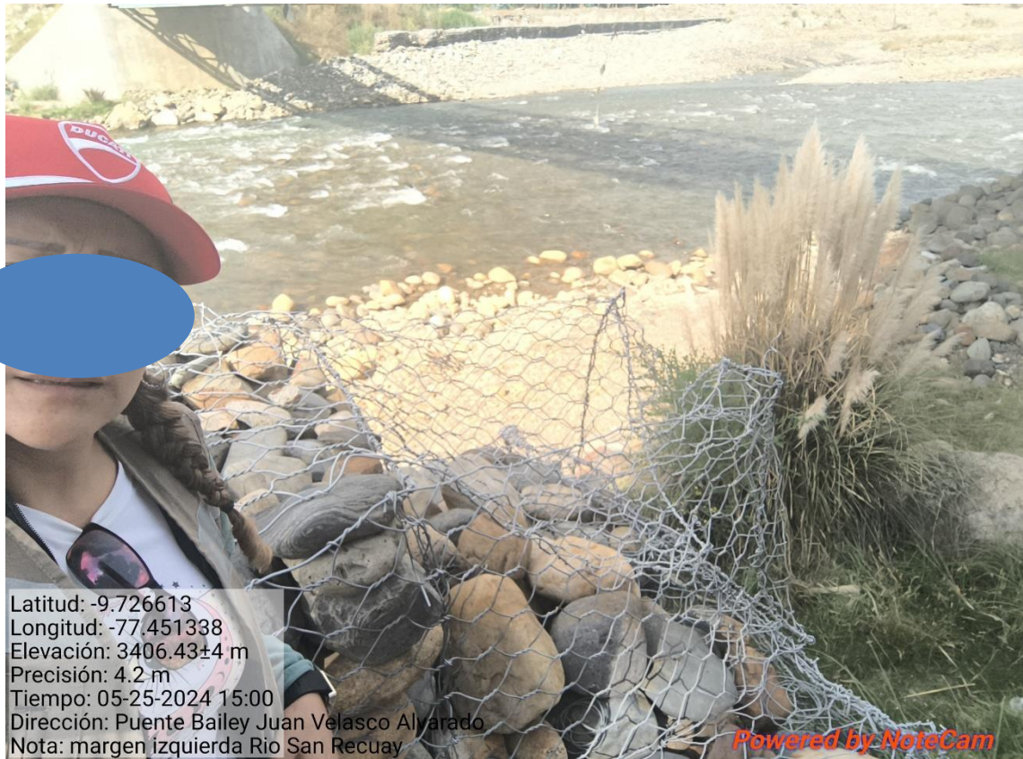
Figura N° 13: Gavión sin relleno en corona, progresiva 0+008
