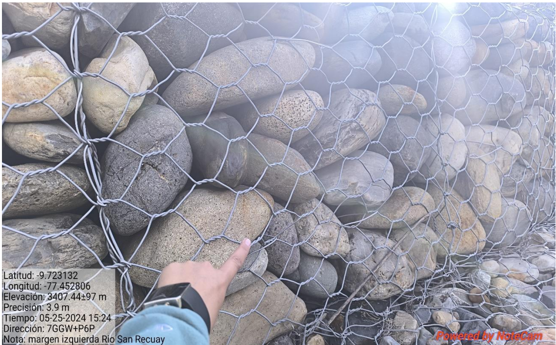
Figura N° 32: Evaluación del tejido d malla del muro de gavión N° 05 (horizontal)
