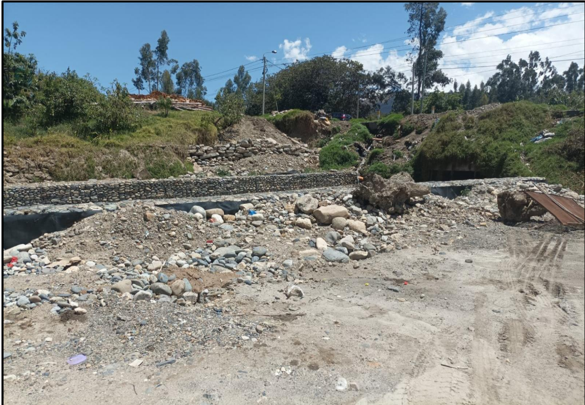
Figura 30: apoyo de agregados contra el muro de gaviones Fuente: Elaboración del autor-2024
