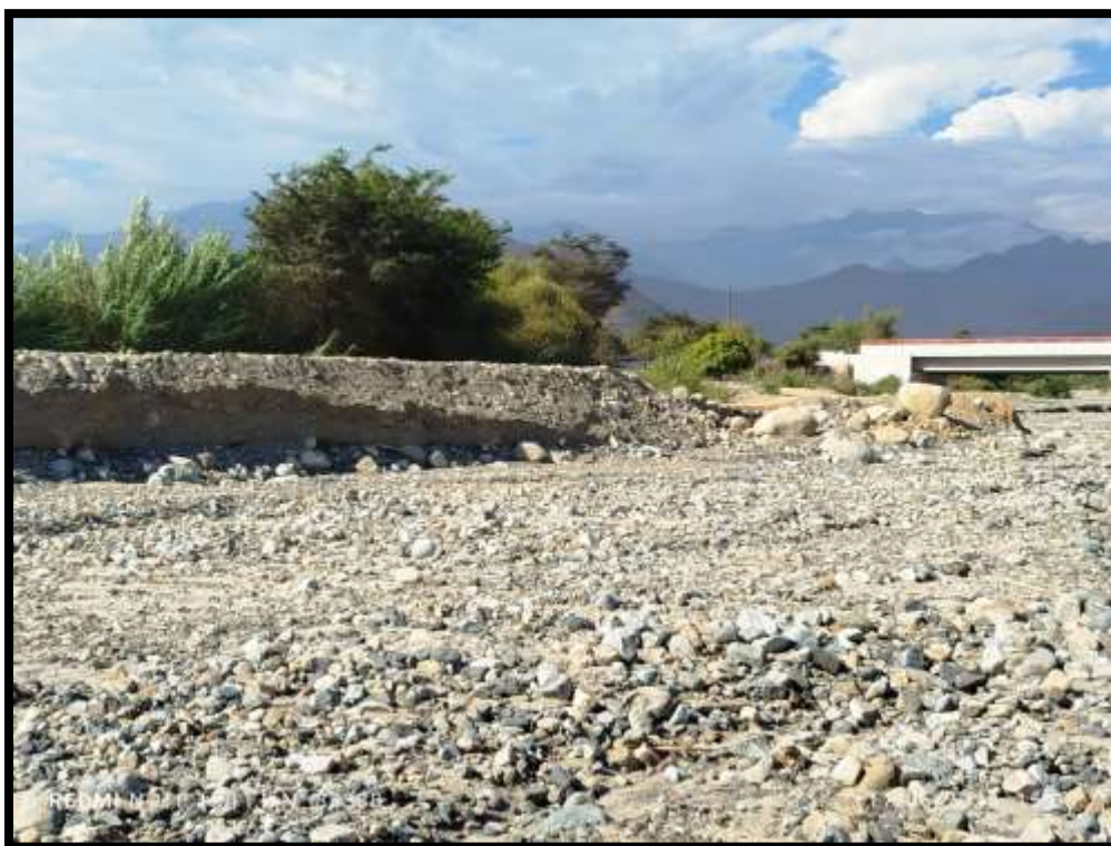
Figura N° 13: Se observa que en margen derecho no existe enrocado
