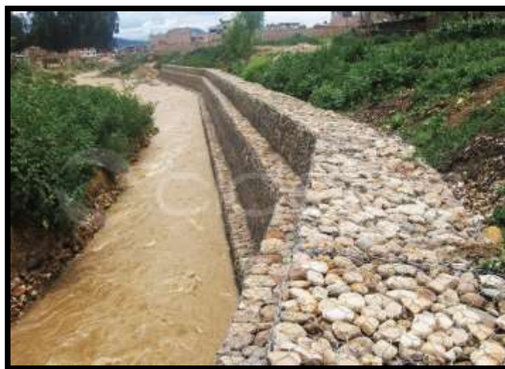
Figura N° 04: Defensas ribereñas gaviones
