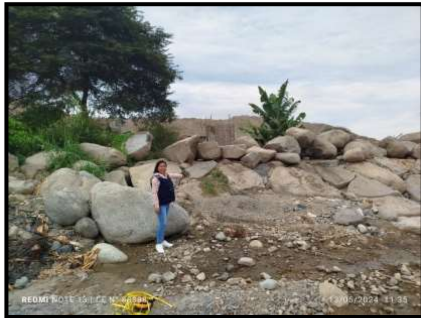
Figura N° 10: identificación del asentamiento del enrocado
