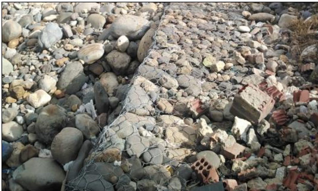
Fotografía 12: Evidencia de contaminación con desmote procedente de construcciones aledañas.
