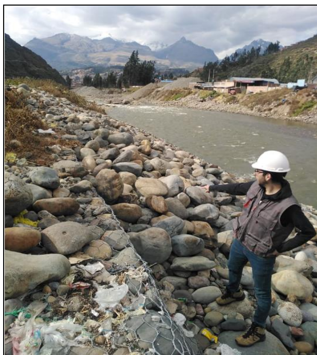
Fotografía 07: Evidencia de piedras de tamaño considerable deformando las mallas del muro de gaviones
