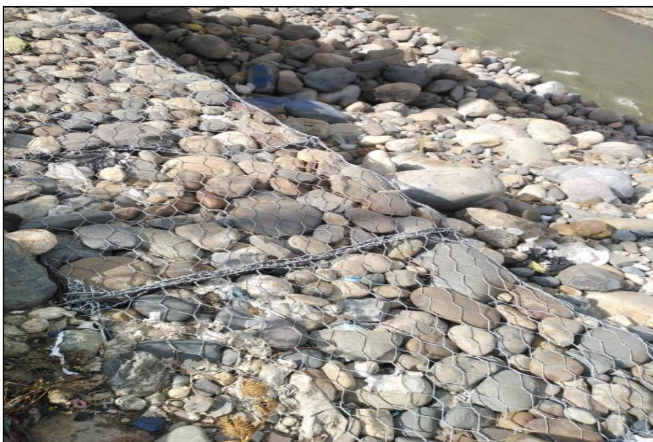
Fotografía 13: Evidencia de la mala granulometría de piedras dentro de la malla tipo cajón.
