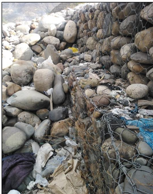
Fotografía 08: Evidencia de la contaminación acelerando la oxidación en las mallas del muro de gaviones.
