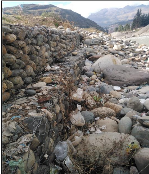
Fotografía 09: Evidencia de la presencia de piedras de dimensiones mayor a 1m de diámetro, dañando y deformando los muros de gaviones.
