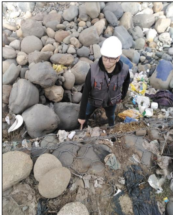
Fotografía 10: Evidencia del estado conservacional malo en el que se encuentra este tramo de los muros de gaviones.
