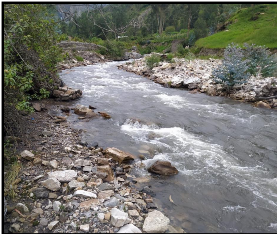
Fotografía 09: Progresiva 0+220 – 0+240 se puede observar ausencia de estructuras de protección a lo largo de ambos márgenes del río, poniendo en peligro terrenos de cultivo aledaños, y viviendas aledañas.
