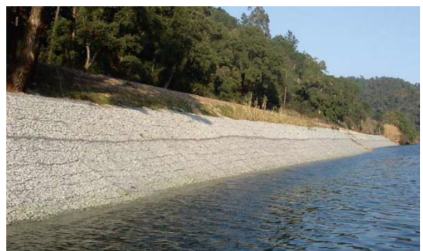
Figura 2. Gaviones para contención fluvial. Fuente:(A Bianchini, 2017).
