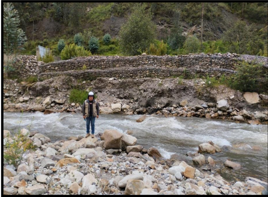
Fotografía 05: Progresiva 0+120 - 0+180, se puede observar deformaciones en toda en la estructura, el primer nivel ha colapsado, el enmallado se encuentra roto y, la estructura ha perdido rigidez, presencia de rocas y sedimentos a lo largo de orilla.
