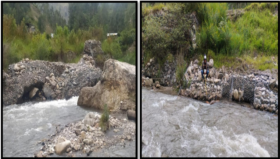
Fotografía 10: Progresiva 0+240 – 0+280, se puede observar la falla de la estructura en su totalidad, debido al fuerte caudal del río, sobre todo en épocas máximas avenidas, el enmallado se encuentra roto y colapsado, el río no tiene un cause definido se encuentra colmatado.
