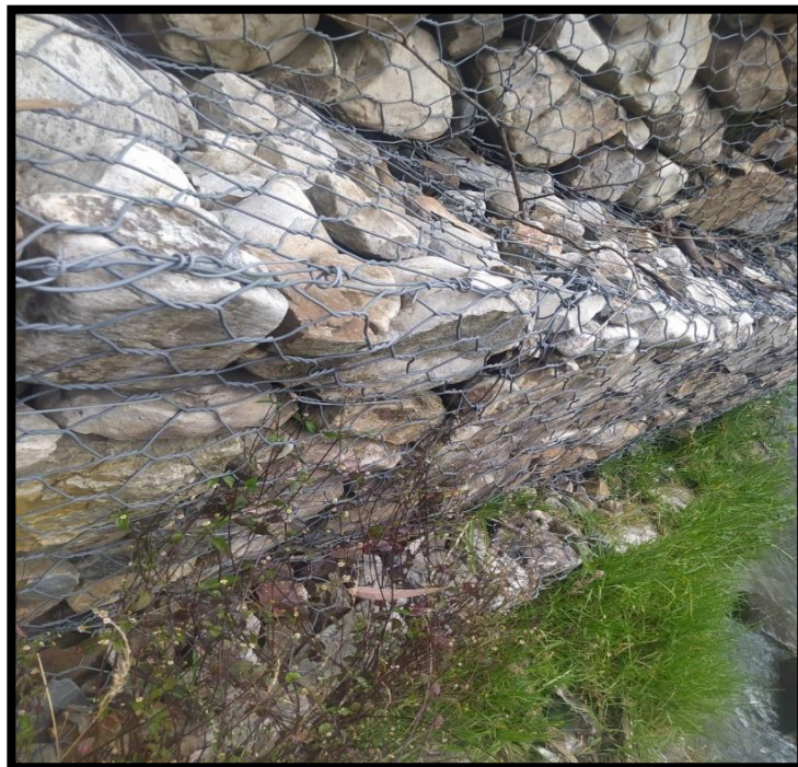
Fotografía 02: Progresiva 0+000 – 0+0.60, podemos observar el estado de los alambres galvanizados, tipo hexagonal, estos se encuentran con deformaciones y forzados, la granulometría de las rocas es variada, cabe mencionar la variedad, presencia de vegetación.
