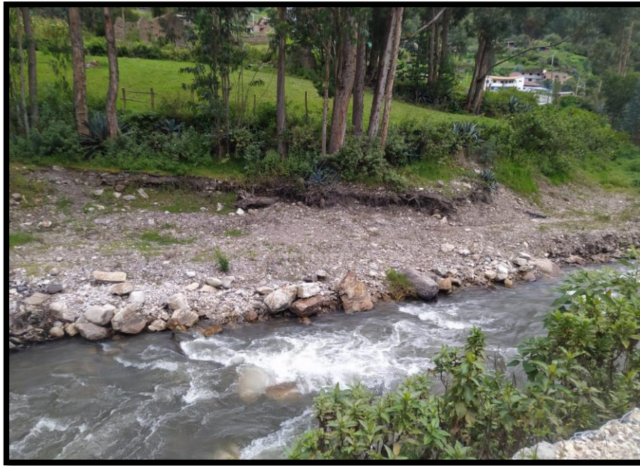
Fotografía 08: Progresiva 0+200 – 0+220, se puede observar la ausencia de gaviones a lo largo de todo el tramo, así como el nivel alcanzado por el agua en máximas avenidas afectando terrenos de cultivo, tramo totalmente desprotegido.
