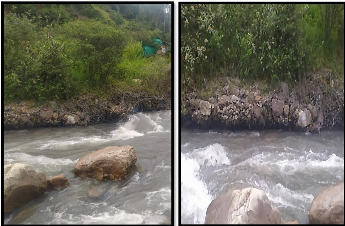
Fotografía 11 - 12: Progresiva 0+240 – 0+280, se puede observar la falla de la estructura en su totalidad, el cauce del río se encuentra colmatado, existen viviendas cercanas.
