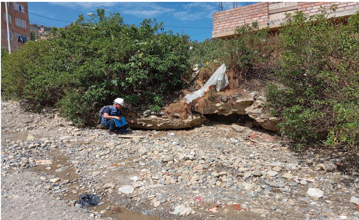
Figura N° 17: Vista socavación de muro en el tramo 0+000 hasta 0+100 del muro de gaviones en el margen izquierdo
