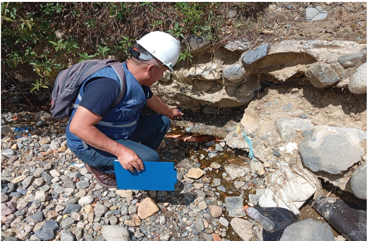
Figura N° 19: Filtración de desagüe en el margen izquierdo de la defensa ribereña
