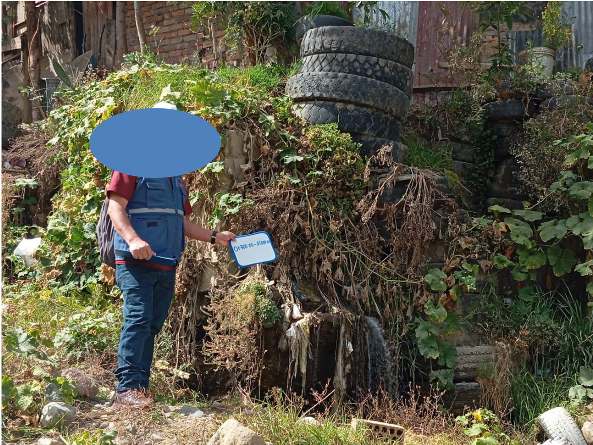
Figura N° 34: Acumulación de materiales y vegetaciones del tramo 0+700 hasta 0+800 del margen izquierdo
