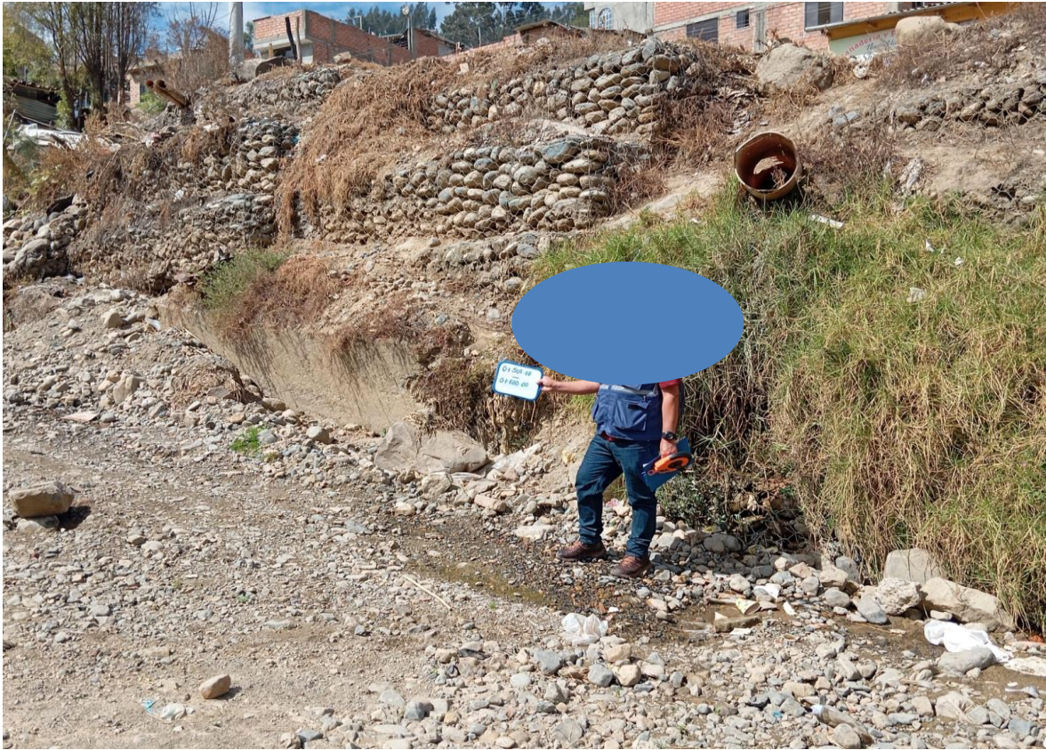
Figura N° 30: Muro de gaviones al borde del colapso en el tramo 0+500 hasta 0+600 del margen izquierdo
