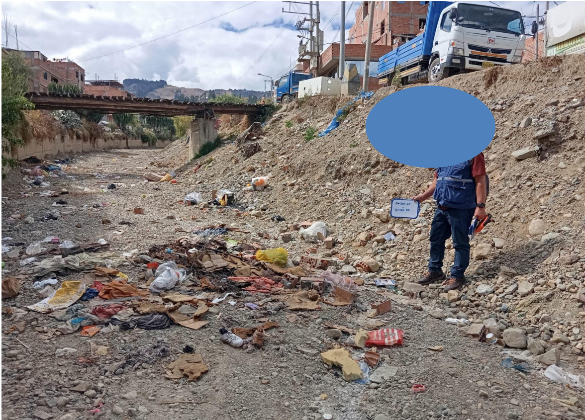
Figura N° 26: No se evidencia estructura existente alguna en el tramo 0+300 hasta 0+400 del margen izquierdo
