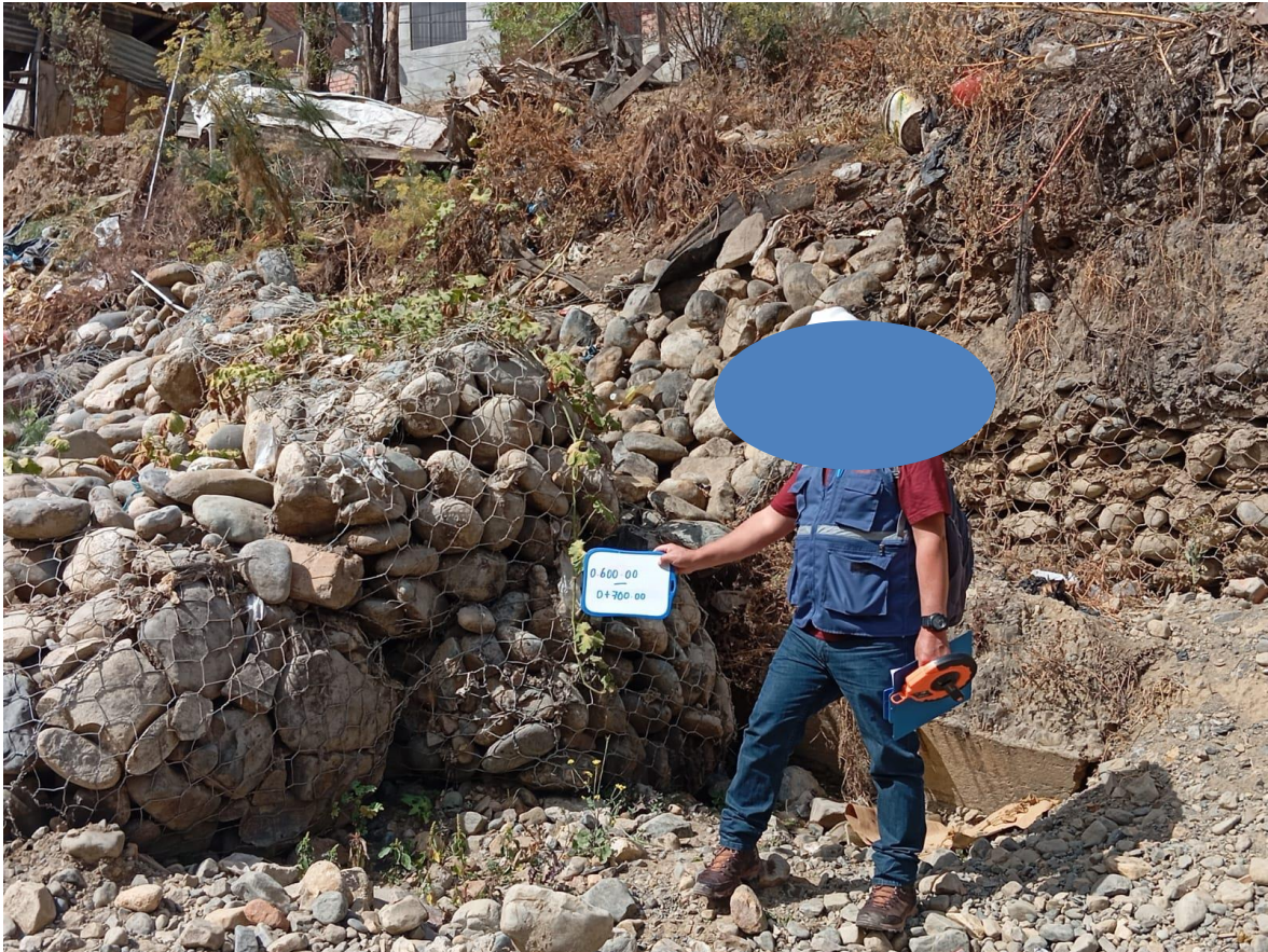
Figura N° 32: Muro de gavión colapsada en el tramo 0+600 hasta 0+700 del margen izquierdo
