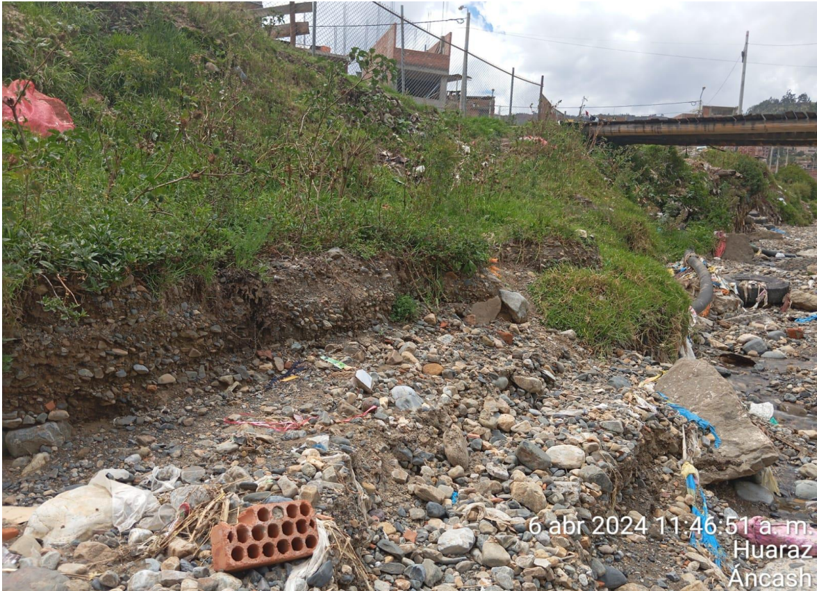
Figura N° 20: Acumulación de arbustos y desmote en el tramo 0+100 hasta 0+200 del margen derecho
