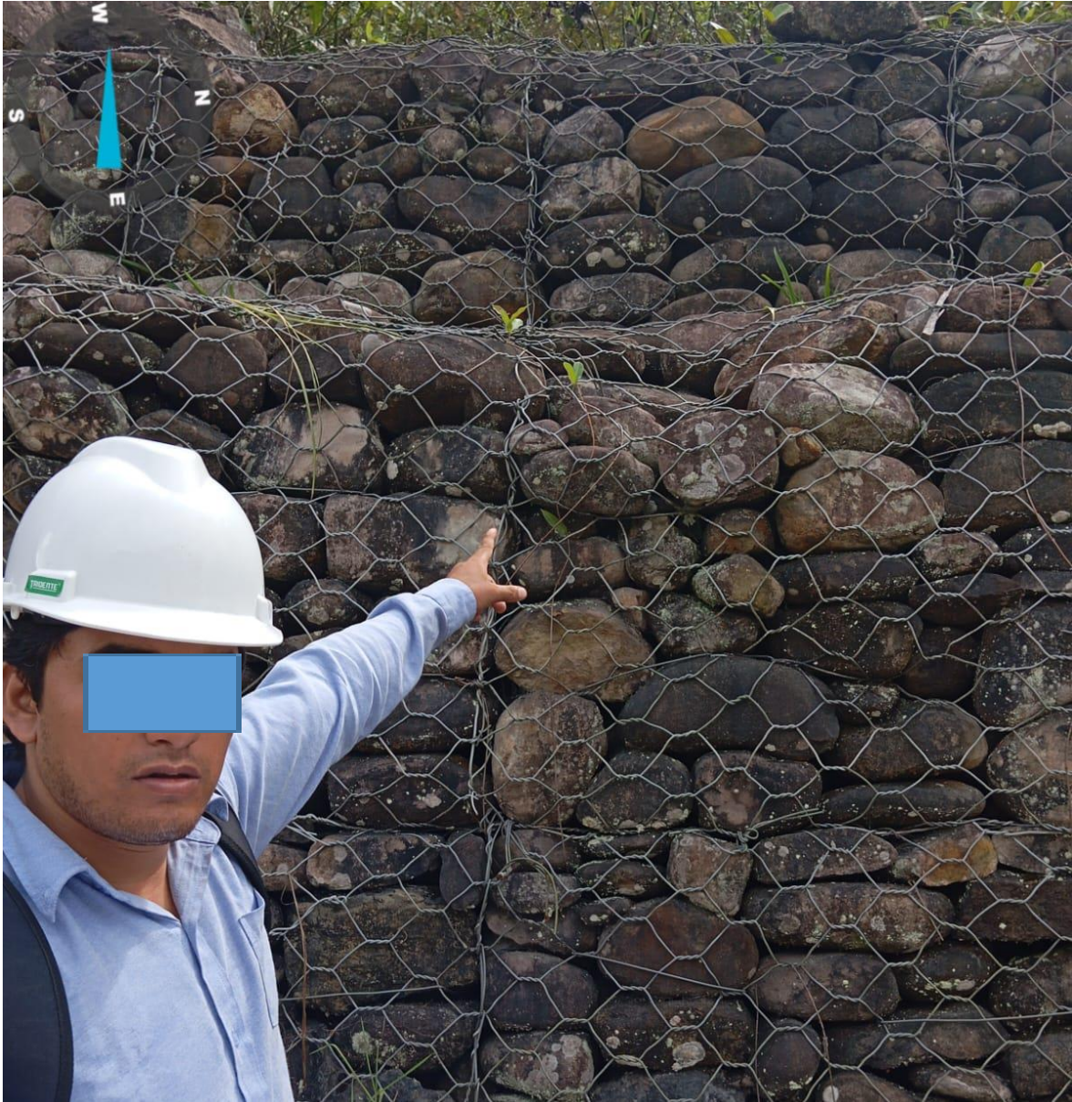
Figura 19: Hundimiento de malla Fuente: Evidencia de campo
