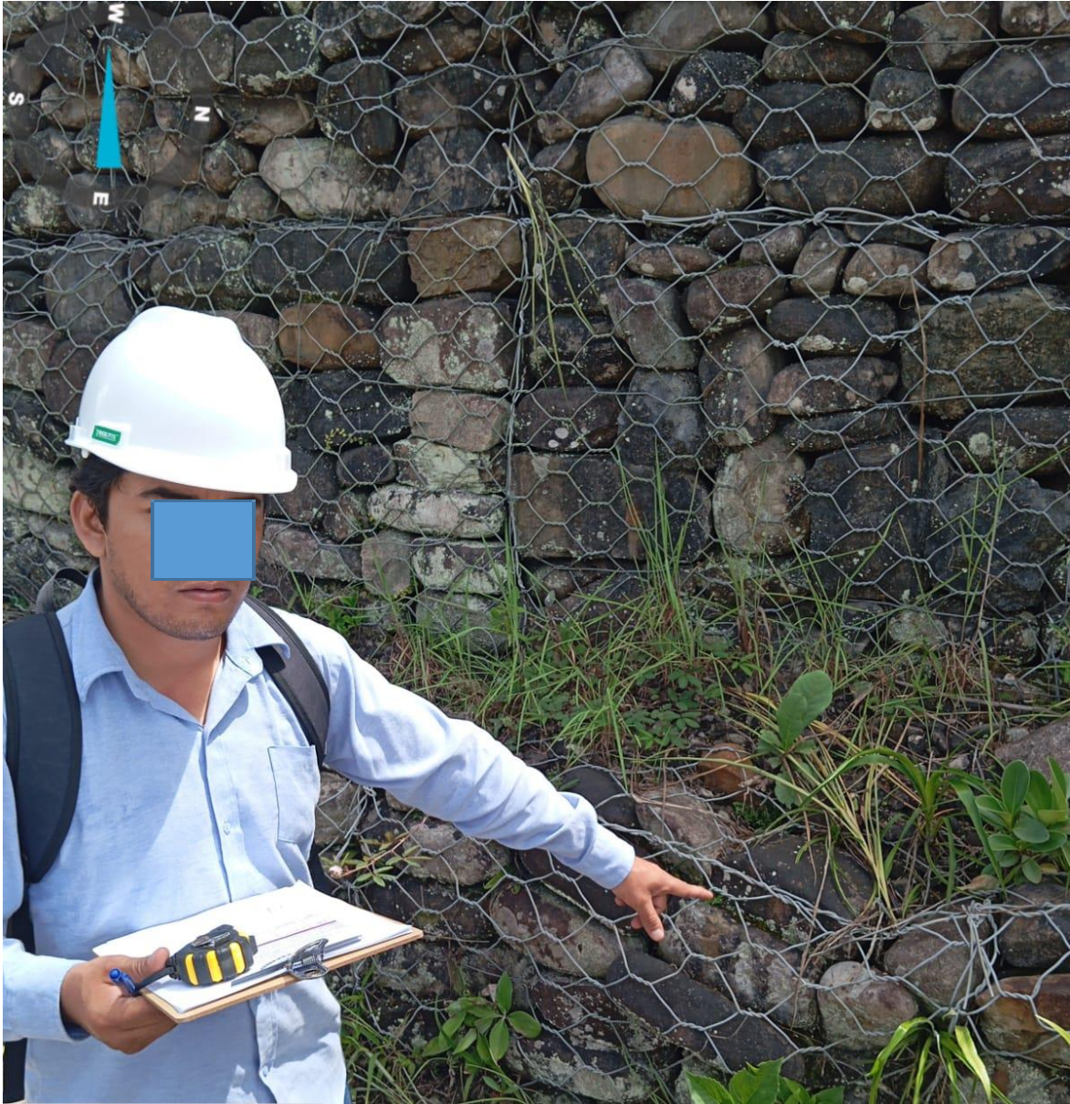
Figura 20: Zona vulnerable en parte baja del muro Fuente: Evidencia de campo
