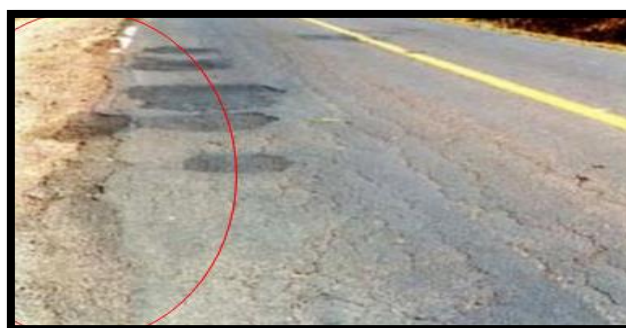
Gráfico N° 13: Fisuras de borde.
