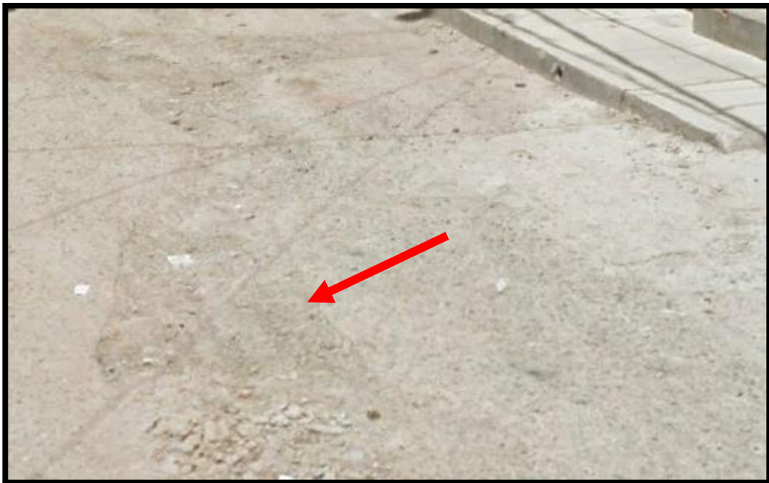
Grafico N° 44: Presentación de fisura bache de severidad alta.
