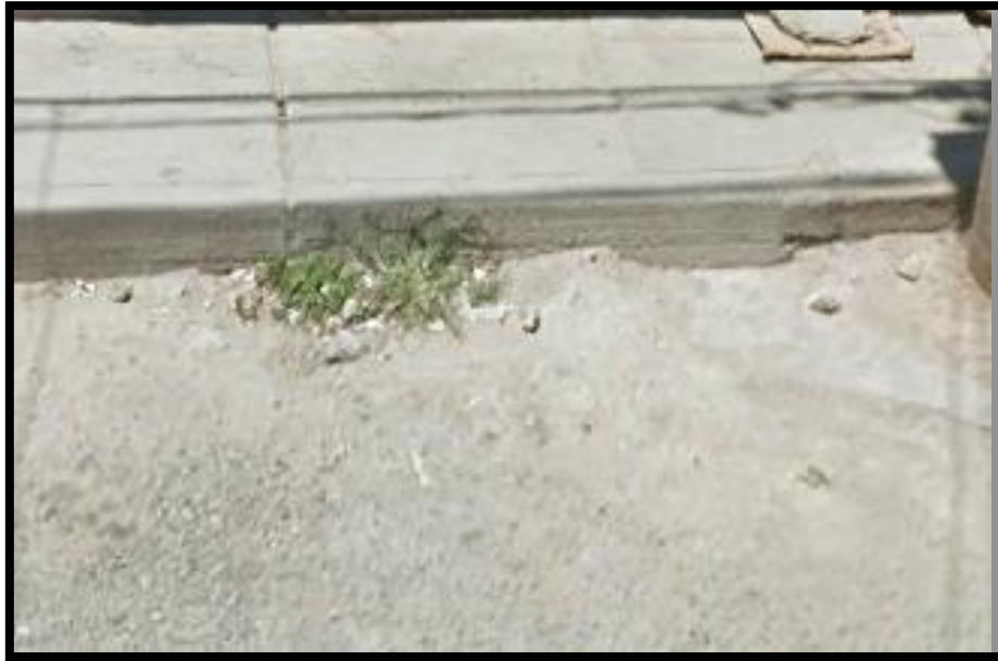
Gráfico N° 62: Calzada con falla de baches, corrugación.
