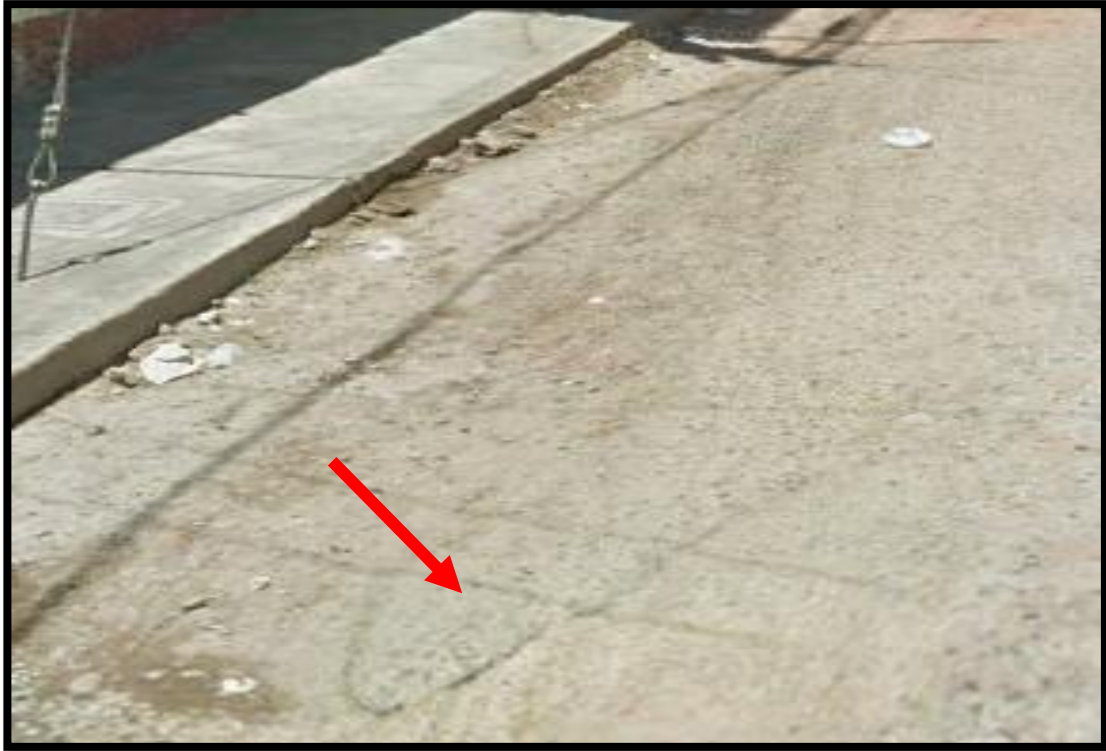
Grafico N° 43: Presentación de fisura parabólica o por deslizamiento de severidad alta.
