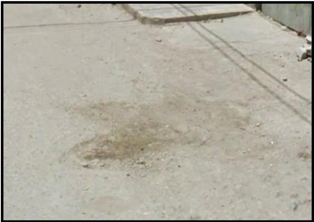
Gráfico N° 67: Calzada con falla de baches. Fuente: Propia.
