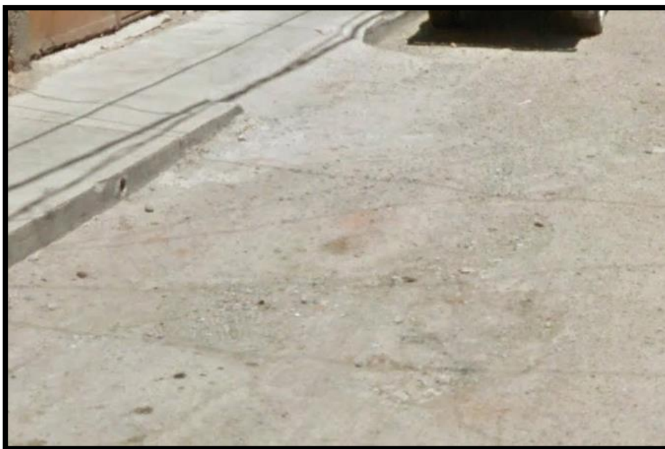
Gráfico N° 64: Calzada con falla de peladura y baches.
