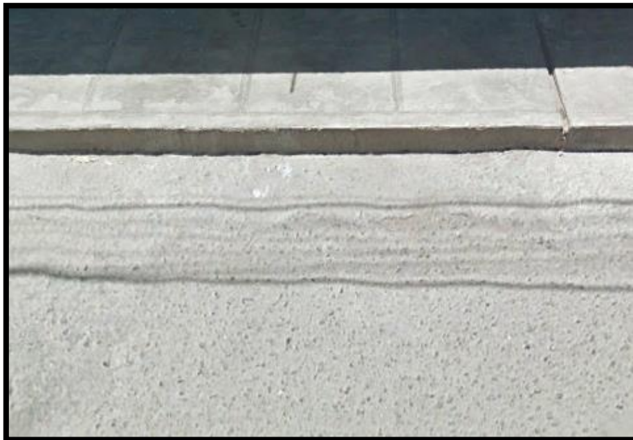
Gráfico N° 63: Calzada con falla de corrugación.
