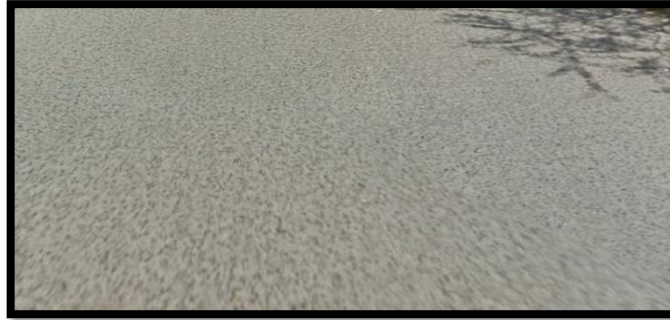
Gráfico N° 28: Peladura por intemperismo y desprendimientos de agregados.
