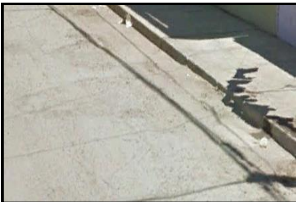
Gráfico N° 65: Calzada con falla de parches, peladura, corrugación y baches.
