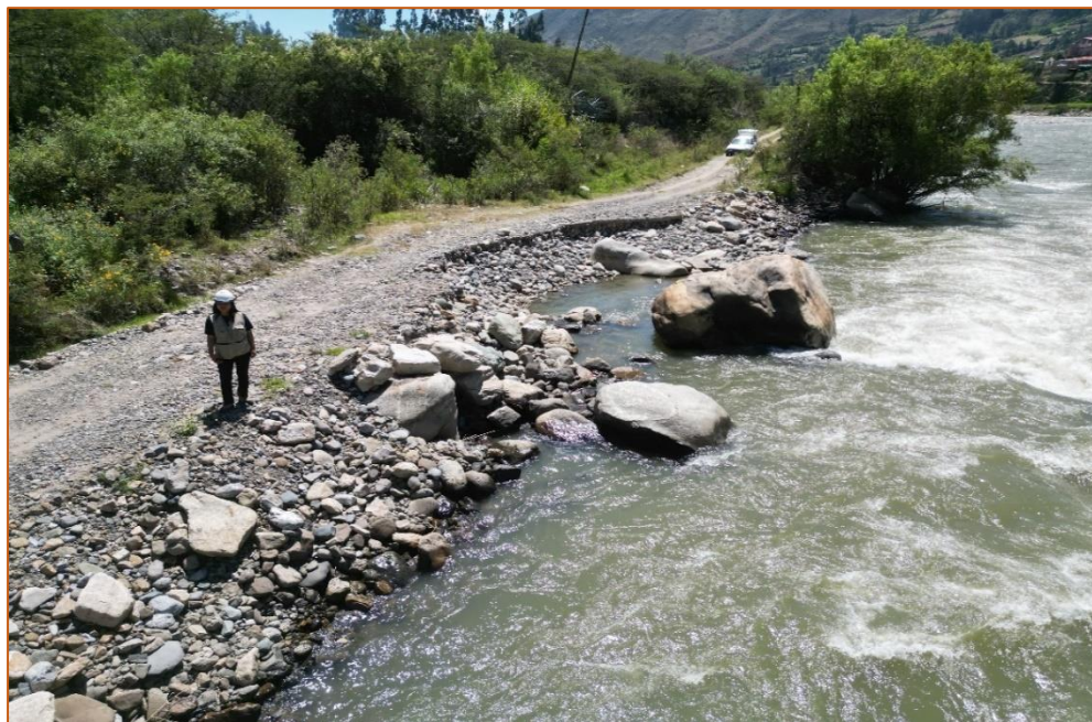
Figura 8: Erosión de enrocado de las progresivas 263+800 al km 264+000
