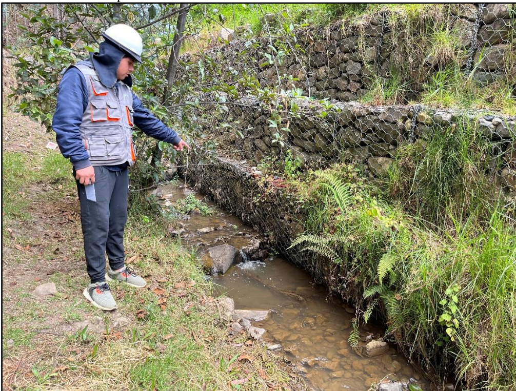
Figura 4: muestra de suciedad y Socavación en el muro de gavión del río Chaupiragra
