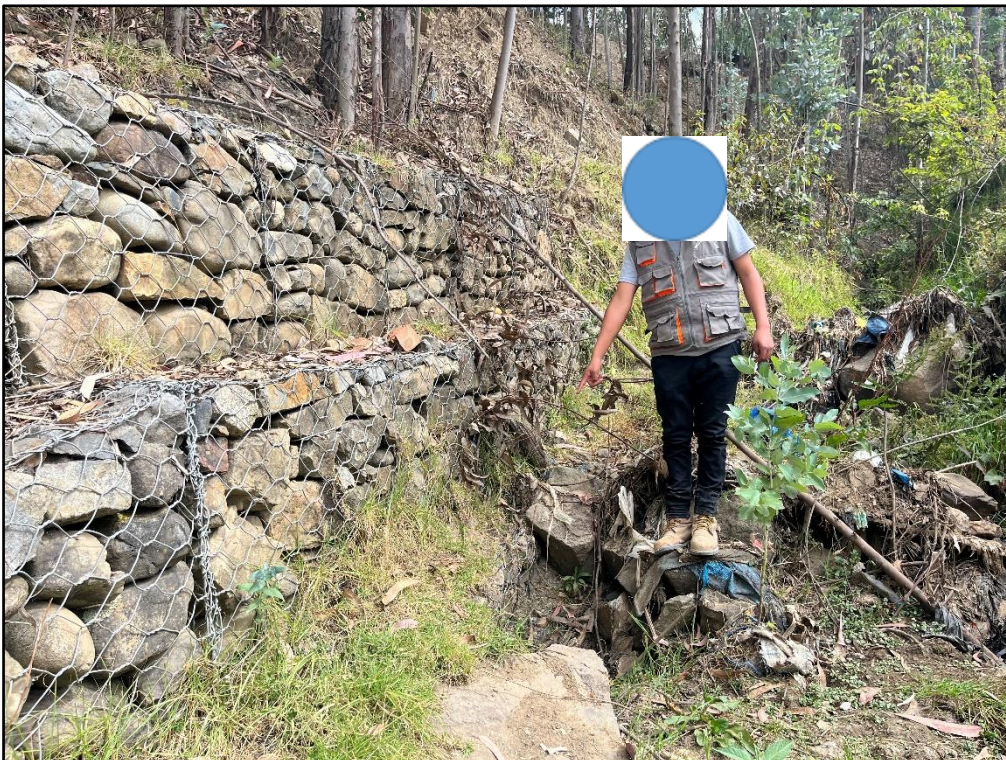
Figura 18: Evaluaci6n estructural del muro de gabi6n del r6o Chaupirgra primer nivel, progresiva 900+1000
