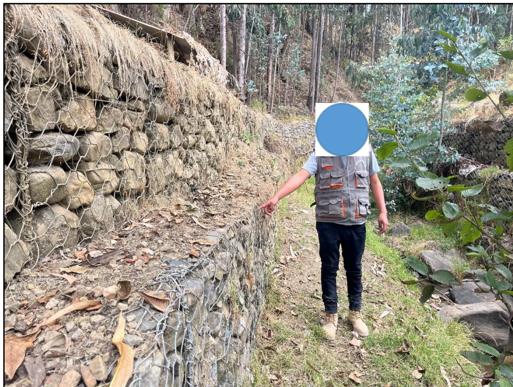
Figura 16: Evaluación estructural del muro de gavión del segundo nivel del río Chaupiragra, progresiva 700+800
