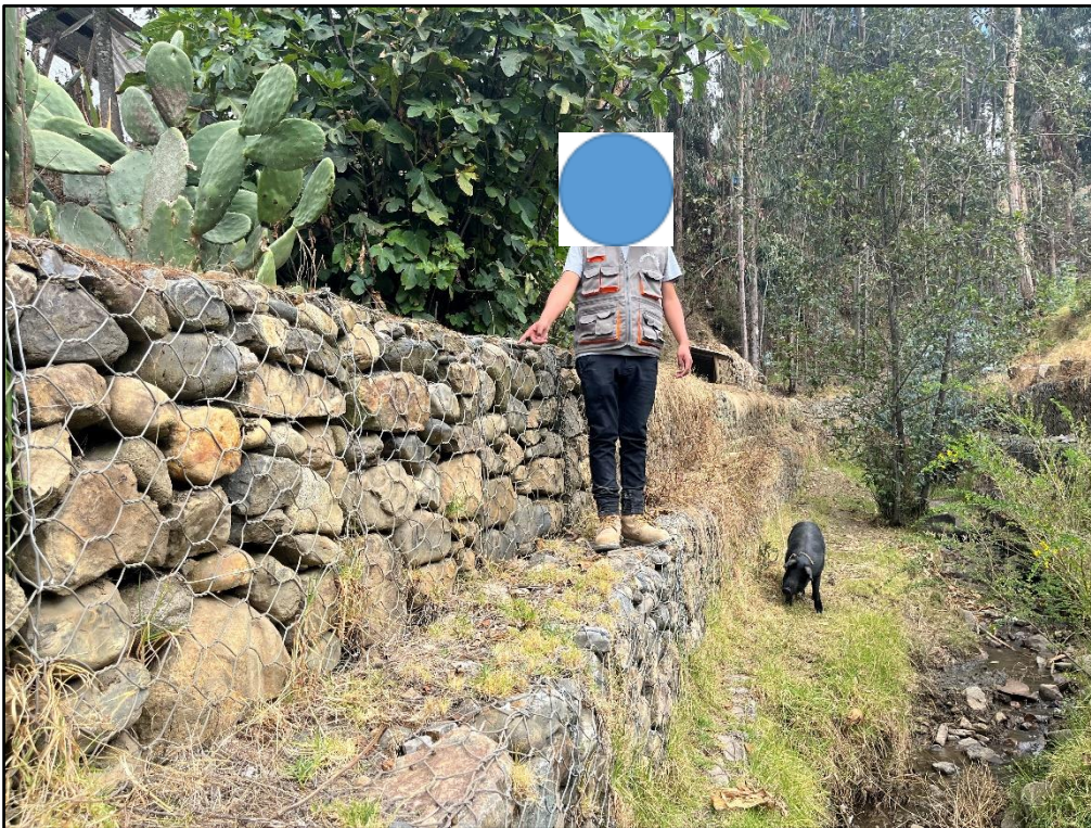
Figura 14: Evaluaci6n estructural del muro de gabi6n del r6o Chaupiragra tercer nivel, progresiva 600+700
