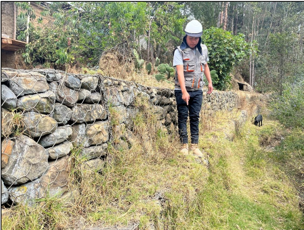
Figura 10: Evaluación estructural del muro de gavión del río Chaupiragra, segundo nivel progresiva 500+600
