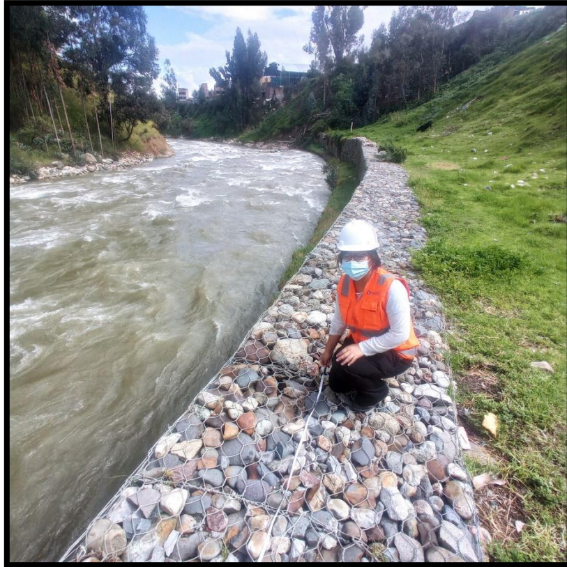
Figuras 9: Medidas del tramo del gavi3n. Fuente: Muro de gavi3n – Sector los libertadores
