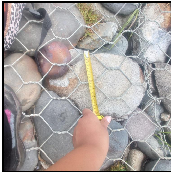
Figuras 14: Piedras rotas. Fuente: Muro de gavión – Sector los libertadores
