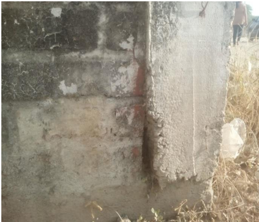
Imagen 24: Presencia de Corrosión en el cerco perimétrico.
