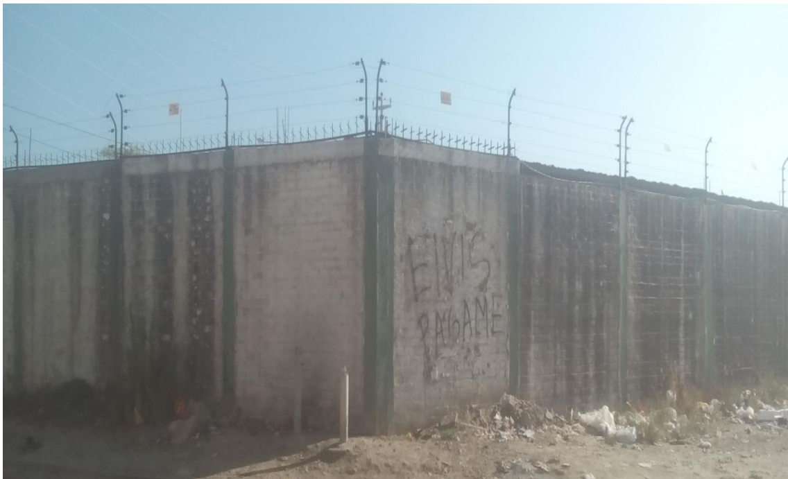
Imagen 19: Presencia de Suciedad en el cerco perimétrico.
