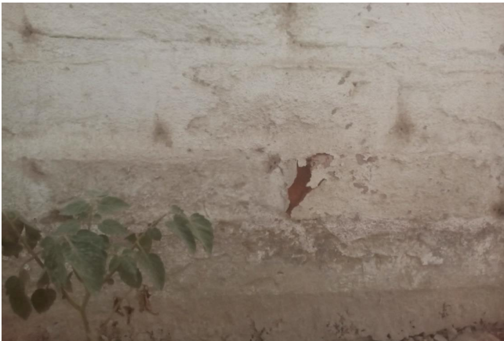
Imagen 23: Presencia de Eflorescencia en el cerco perimétrico.
