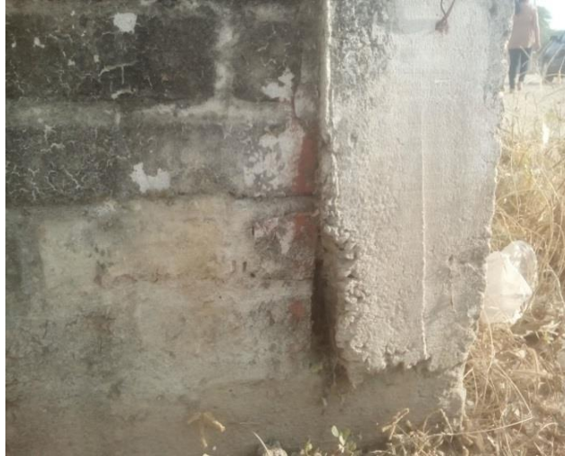
Imagen 14: Corrosión del concreto.
