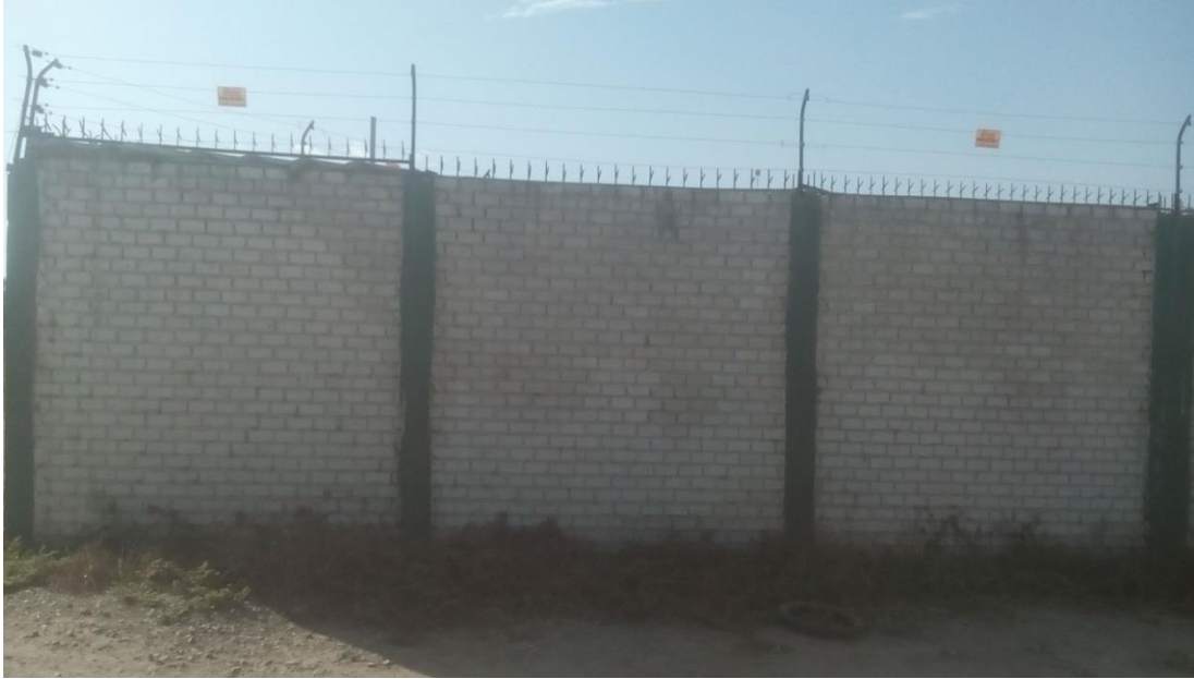
Imagen 18: Humedad en muros que conforman el cerco perimétrico.
