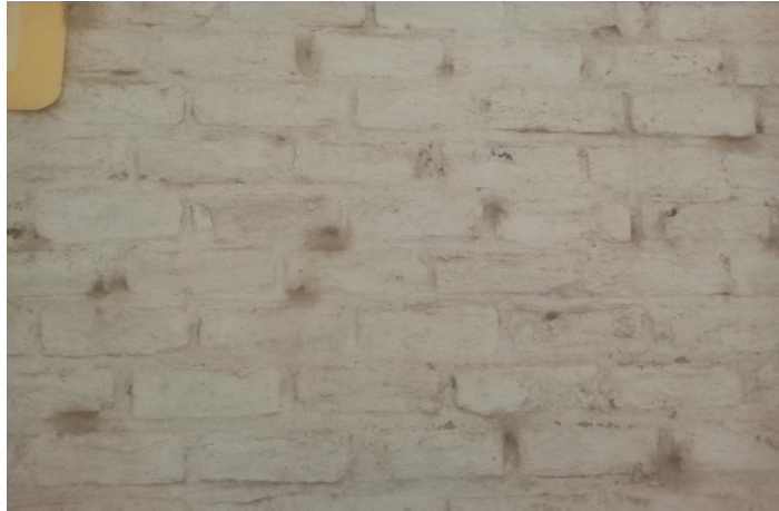
Imagen 11: Suciedad en muros.
