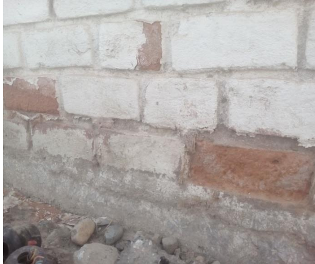
Imagen 13: Erosión en muros.
