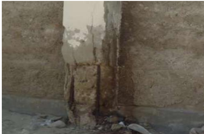
Imagen 3: Desprendimiento del concreto, corrosión del acero.
