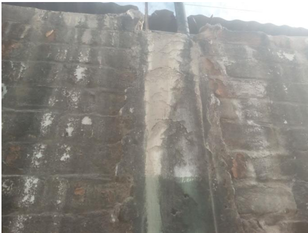
Imagen 25: Presencia de Corrosión en columnas del cerco perimétrico.
