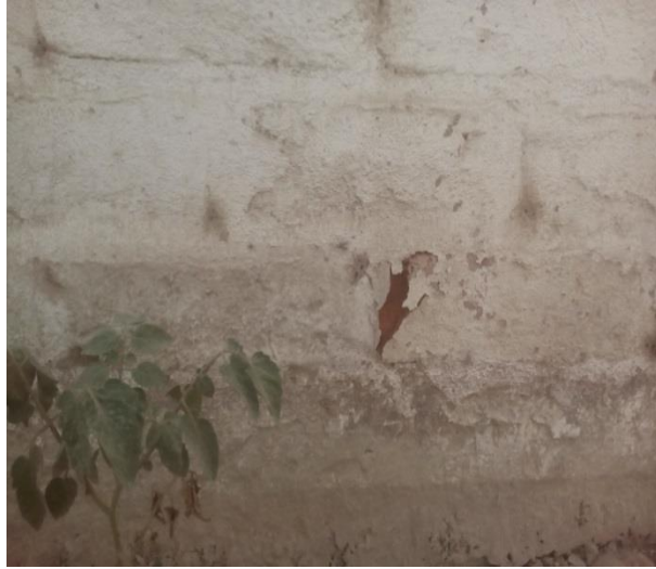
Imagen 10: Humedad en muros.
