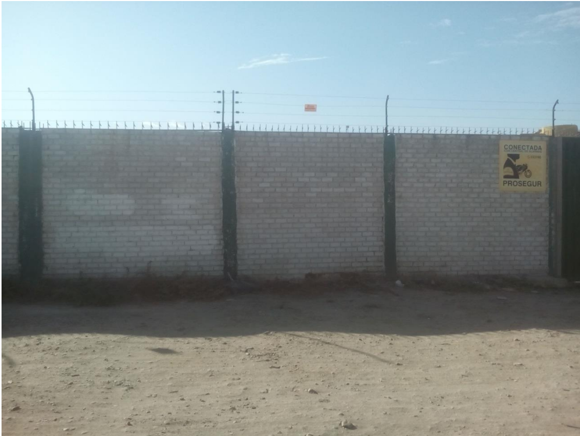
Imagen 17: Presencia de Humedad en el cerco perimétrico.
