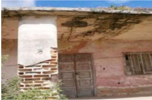
Imagen 2: Fachada de vivienda afectada en Santa Fe.
