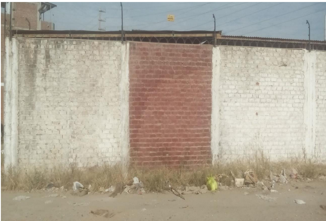
Imagen 20: Suciedad en muros del cerco perimétrico.
