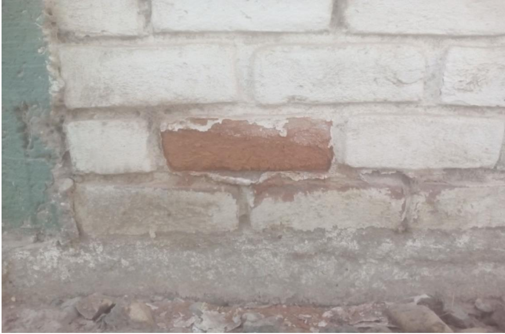
Imagen 22: Presencia de Erosión en muros del cerco perimétrico.
