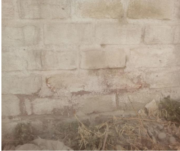
Imagen 12: Eflorescencia en muros.
