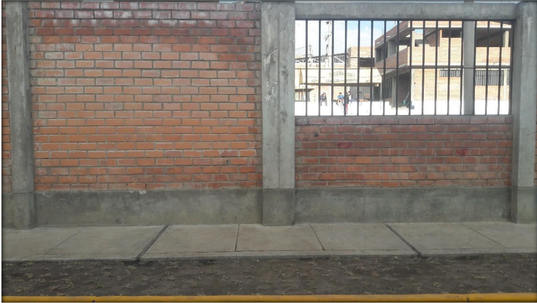
Imágenes 51: patología de humedad.
