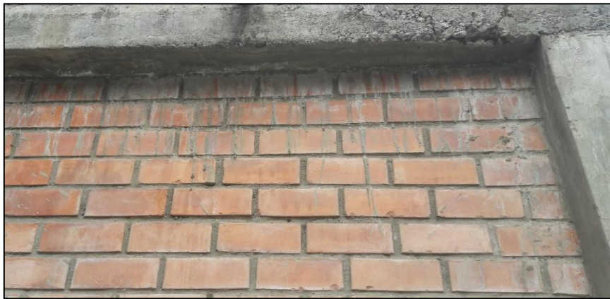
imágenes 40: Corrosión del acero.
