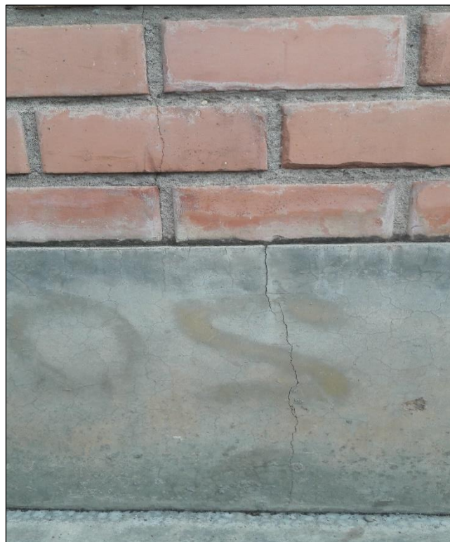
Imágenes 50: patología de fisura viva.
