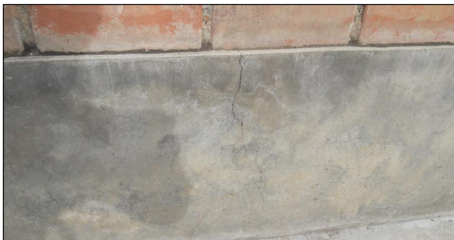
imágenes 39: de fisura en el revestido de sobrecimientos.
