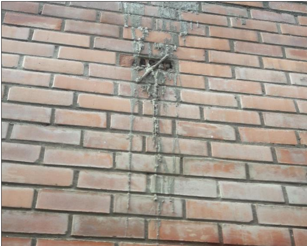
Imágenes 51: patología de exudación.
