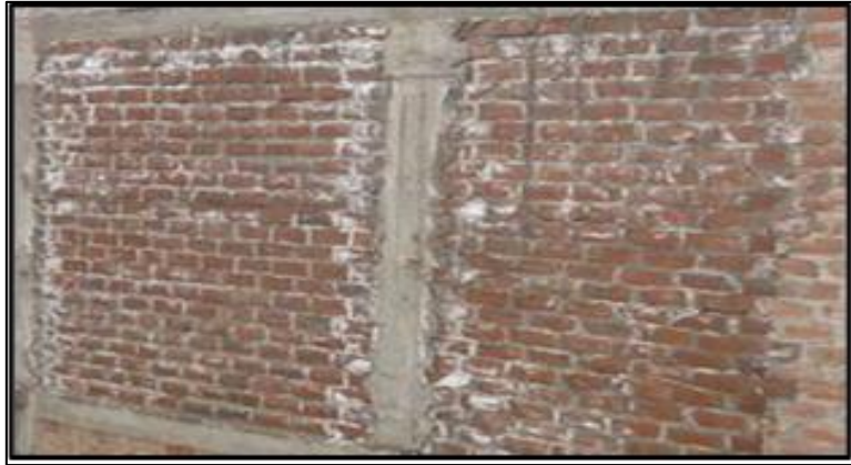
imágenes 33: Las patologías presentes en este muro se ven la eflorescencia
