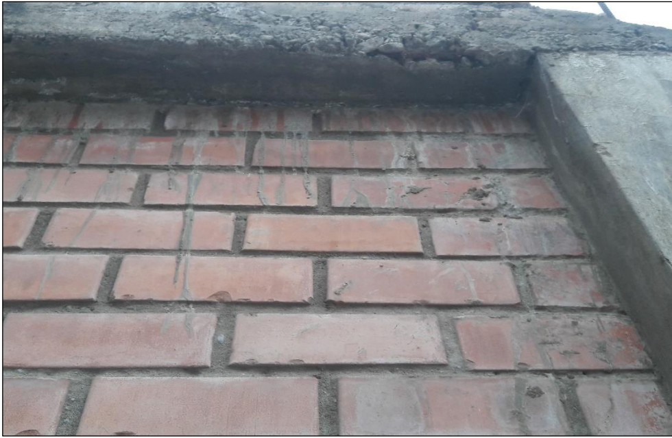
imágenes 45: patología de corrosión.
