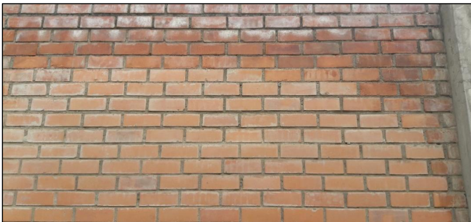
imágenes 37: Se muestra eflorescencia en el muro.
