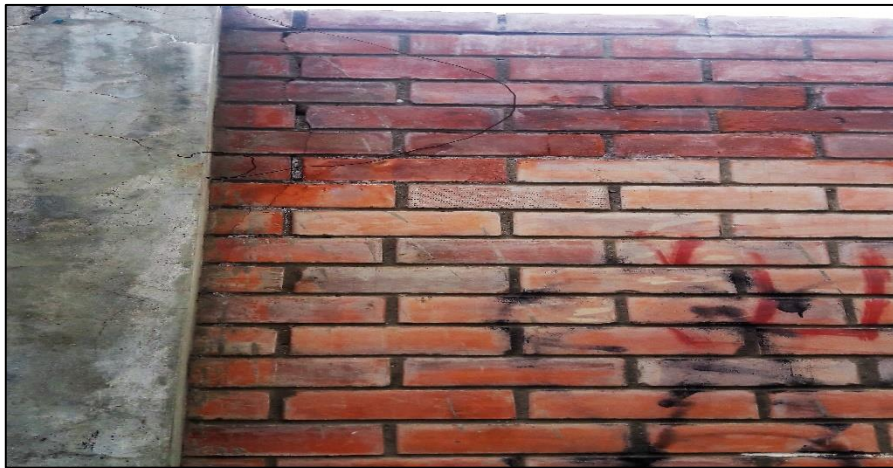
imágenes 38: Se muestra grieta en el muro.
