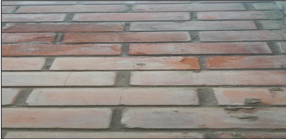
imágenes 36: Erosión física en paredes.
