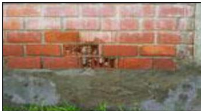
imágenes 21: Humedad capilar.
