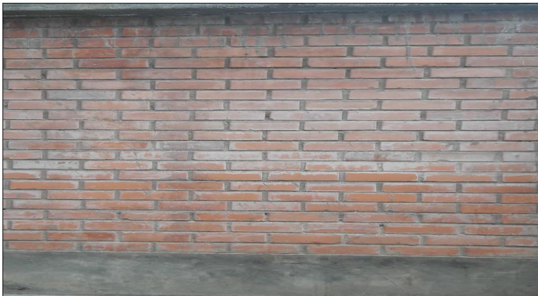
imágenes 44: patología de eflorescencia.
