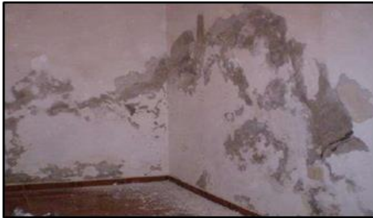
imágenes 20: efectos de la humedad.
