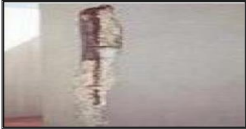
imágenes 30: Fisuración debida a corrosión de las armaduras.
