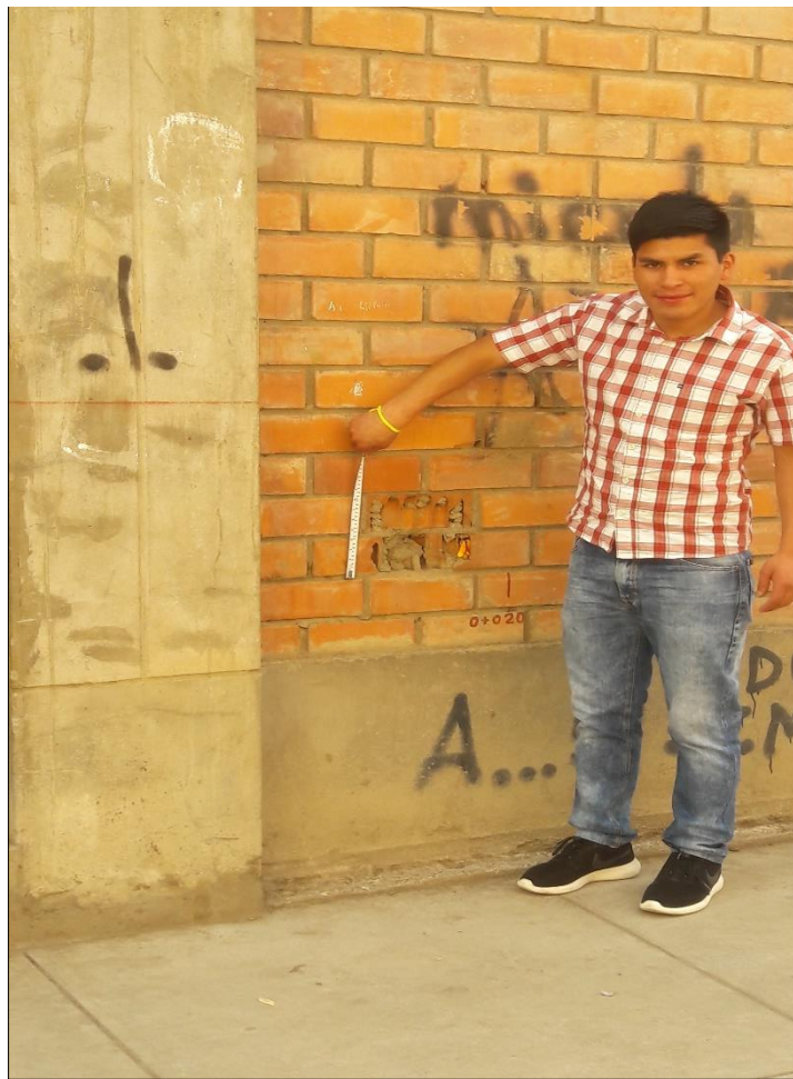
imágenes 46: la patología de erosión mecánica.
