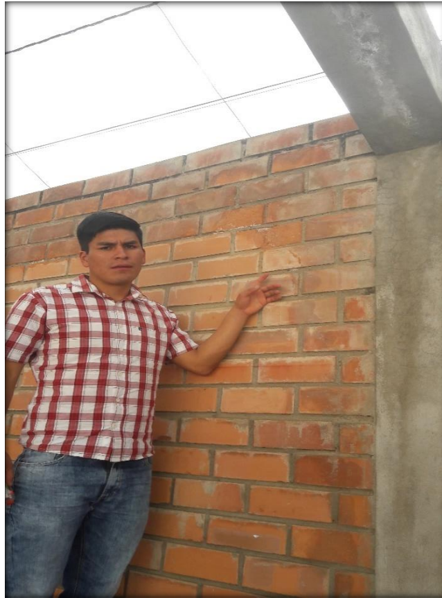
imágenes 49: patología de erosión física.
