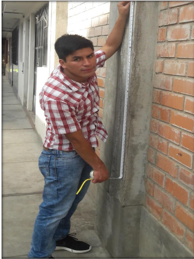
imágenes 47: patología de fisura.
