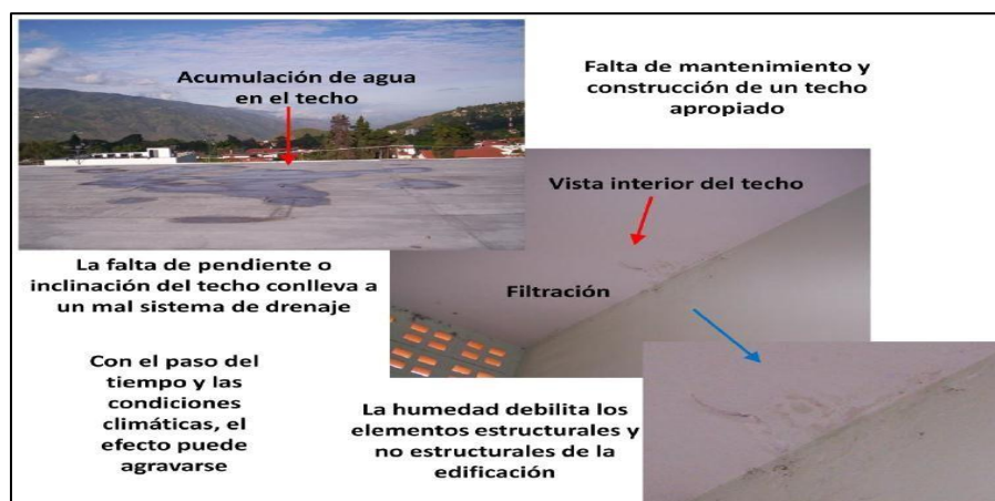
imágenes 19: Patologías por deterioro de la edificación.
