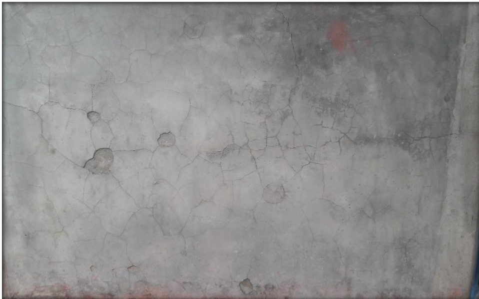
imágenes 48: patología de desprendimiento.
