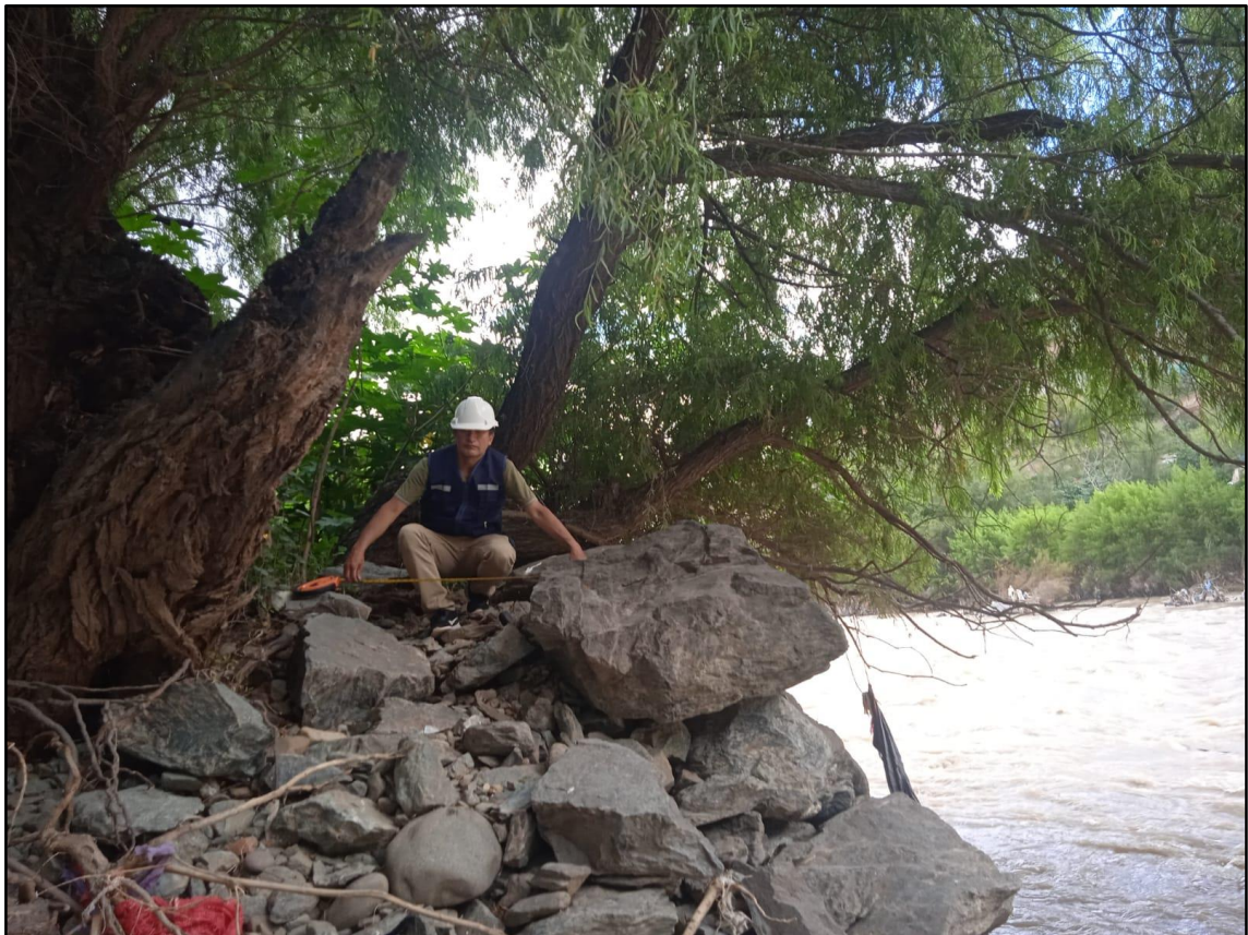
Fotografía 08: Zona 3, deslizamiento total de rocas en 9 m de enrocado. Fecha: 24/03/2016. Fuente: Propia.
