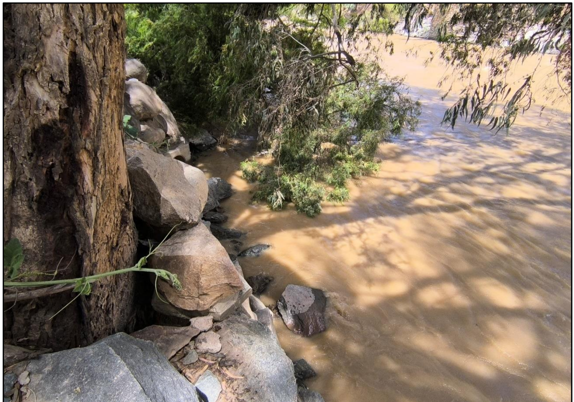
Fotografía 02: Zona 1, vegetación invasiva incrustado en el enrocado.
