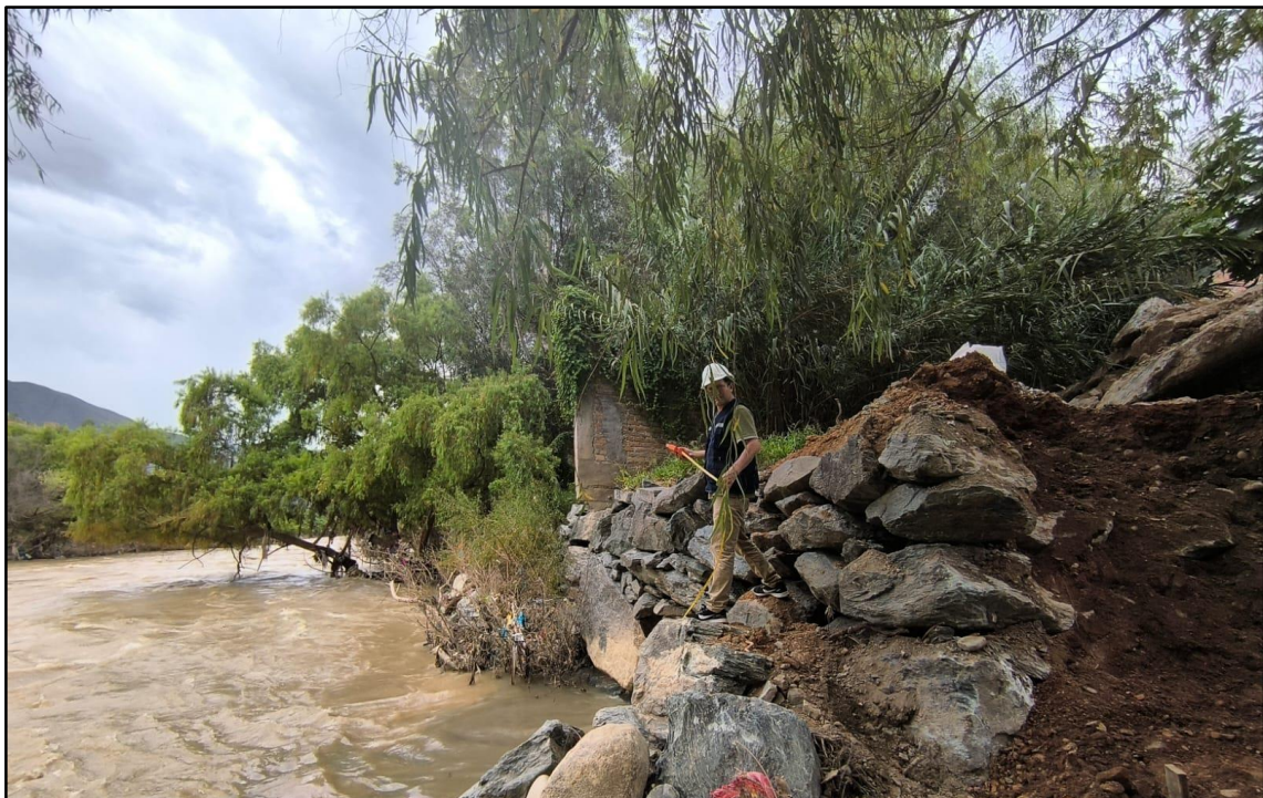
Fotografía 12: Zona 5, tomando medida de altura, evidencia de socavación de la cimentación en 6 m de enrocado. Fecha: 24/03/2016. Fuente: Propia.
