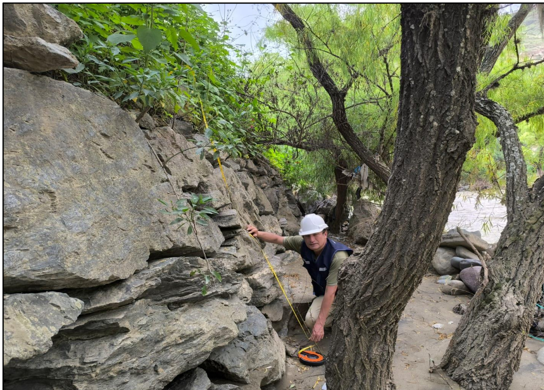
Fotografía 10: Zona 4, Socavación de la cimentación en 6 m de enrocado. Fecha: 24/03/2016. Fuente: Propia.
