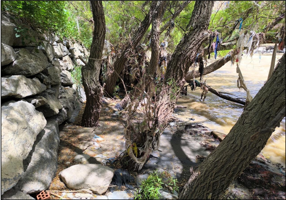
Fotografía 09: Zona 4, Socavación de la cimentación en 6 m de enrocado. Fecha: 24/03/2016. Fuente: Propia.
