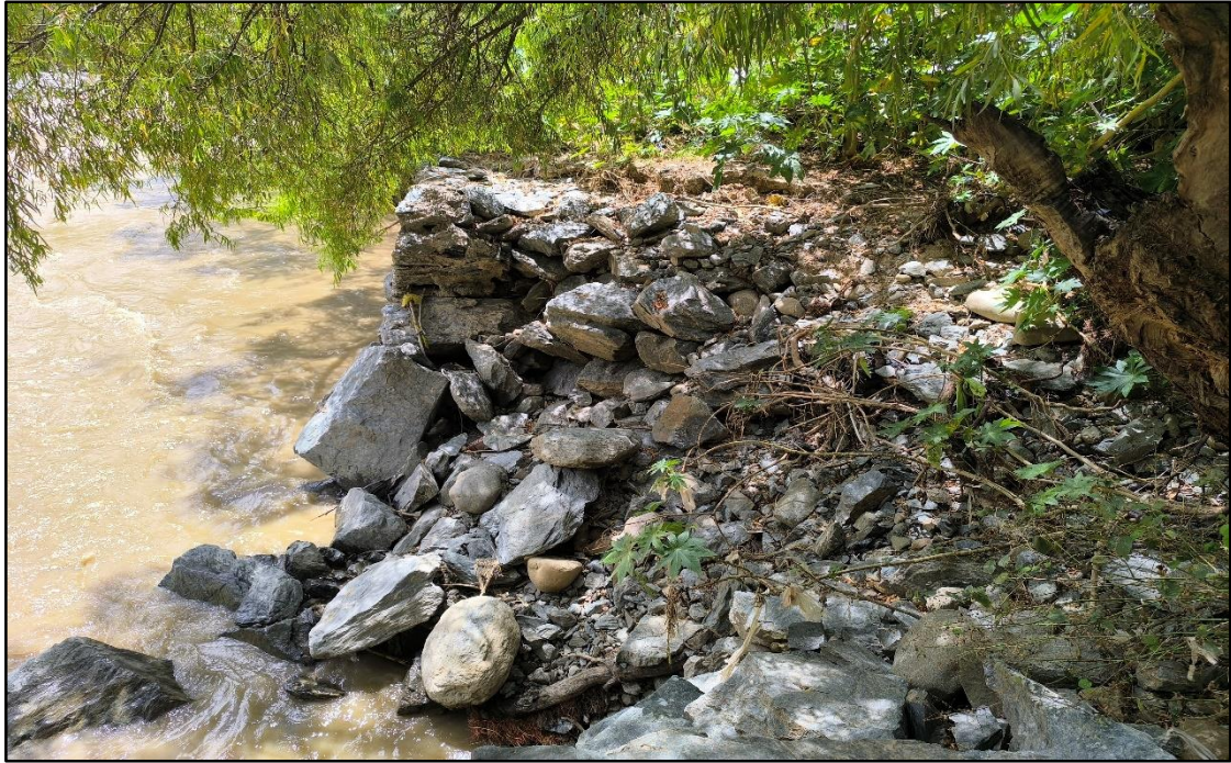
Fotografía 07: Zona 3, deslizamiento total de rocas en 9 m de enrocado. Fecha: 23/03/2016. Fuente: Propia.
