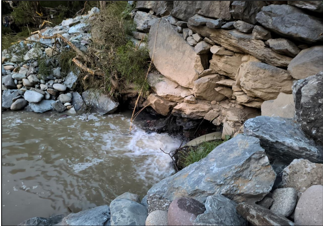
Fotografía 11: Zona 5, Socavación de la cimentación en 6 m de enrocado. Fecha: 24/03/2016. Fuente: Propia.
