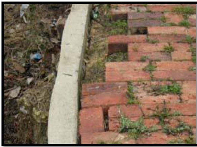
FIGURA N° 8: DESPLAZAMIENTO DE BORDE
