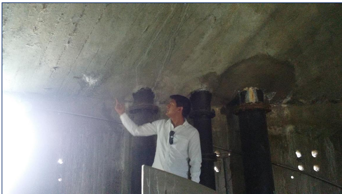
IDENTIFICACION DE PATOLOGIAS EN CUPULA DEL RESERVORIO R7 - PACHITEA
