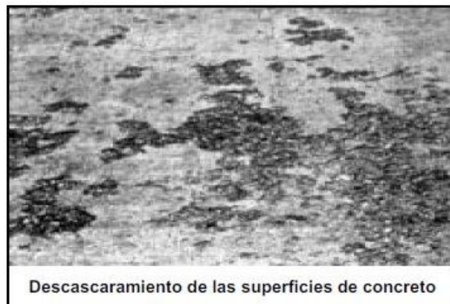
Gráfico N° 08: Descascaramiento de las superficies de concreto.
