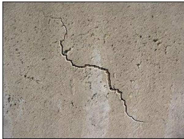
Gráfico N° 06: Agrietamiento por contracción plástica.
