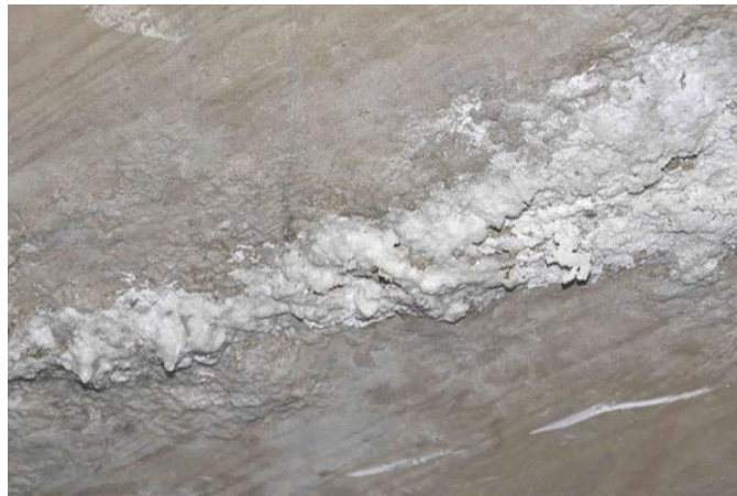
Gráfico N° 11: Eflorescencia del concreto
