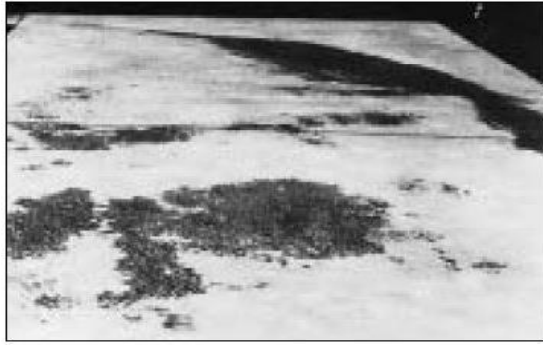
Gráfico N° 04: Decoloración en la superficie de concreto.
