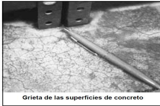
Gráfico N° 10: Resquebrajamiento de las superficies de concreto
