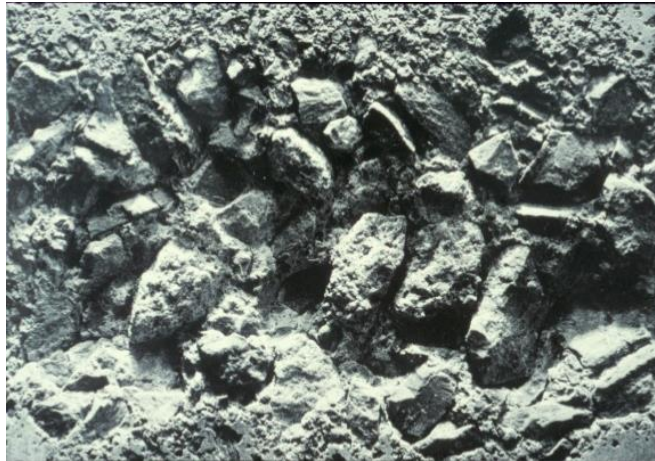
Gráfico N° 12: Daño por cavitación
