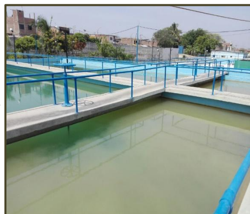
Foto N°02: Sedimentador del Módulo I
