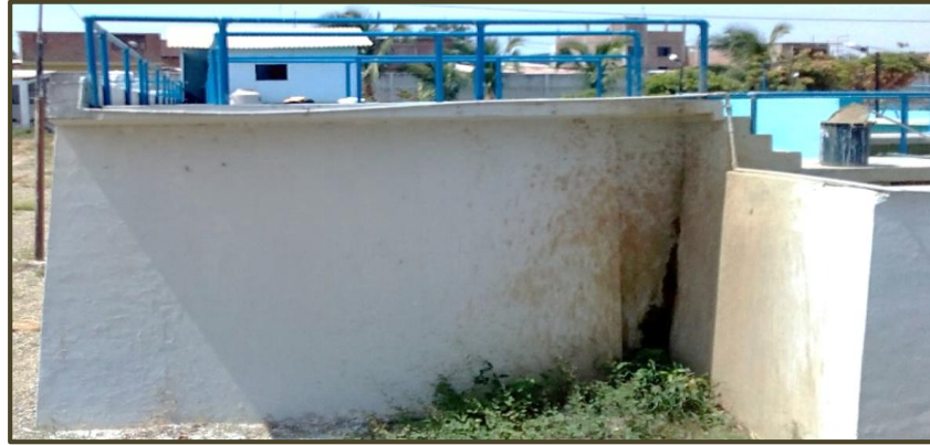
Foto N°10: Colonización en Exterior de Floculador
