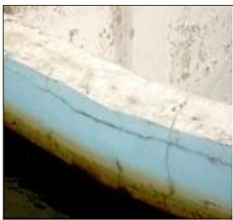
Figura N°13 Fisuras y Grietas
