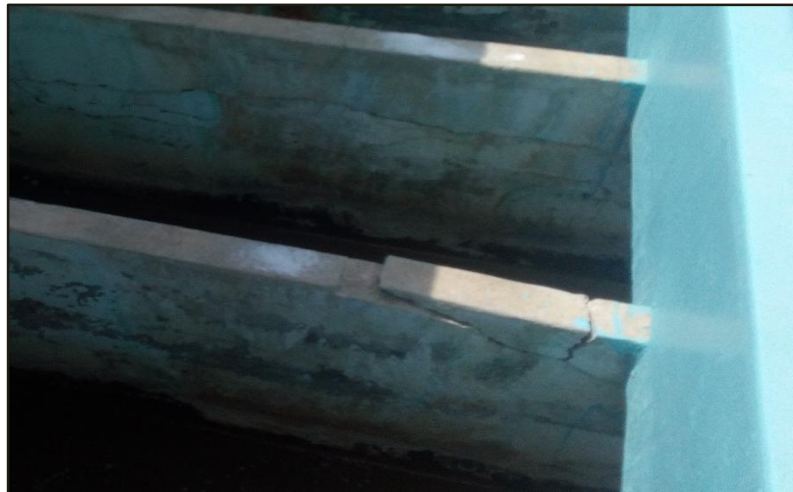
Foto N°05: Desprendimiento de concreto de pantalla
