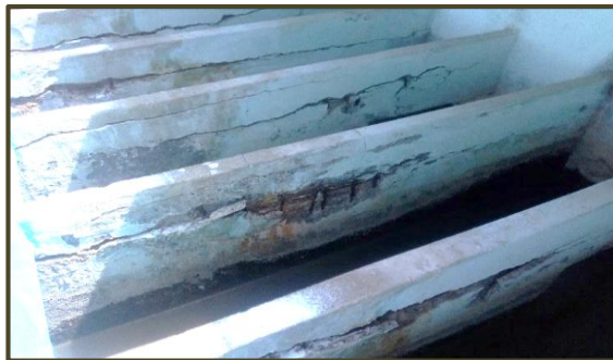
Foto N°09: Corrosión-Carbonatación en el concreto
