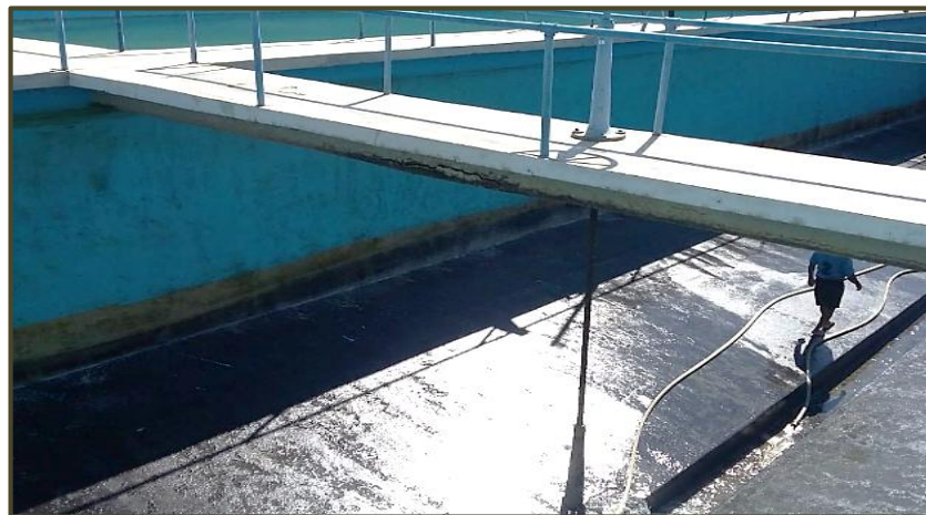
Foto N°11: Colonización en el interior de Sedimentador
