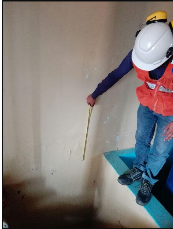
Foto N° 21: Medida de la Patología- Humedad
