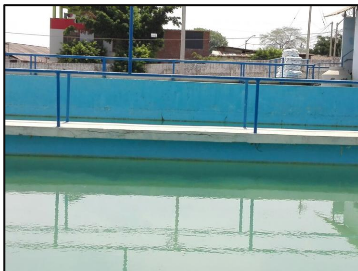
Foto N° 18: Espesor de la Losa con Grietas
