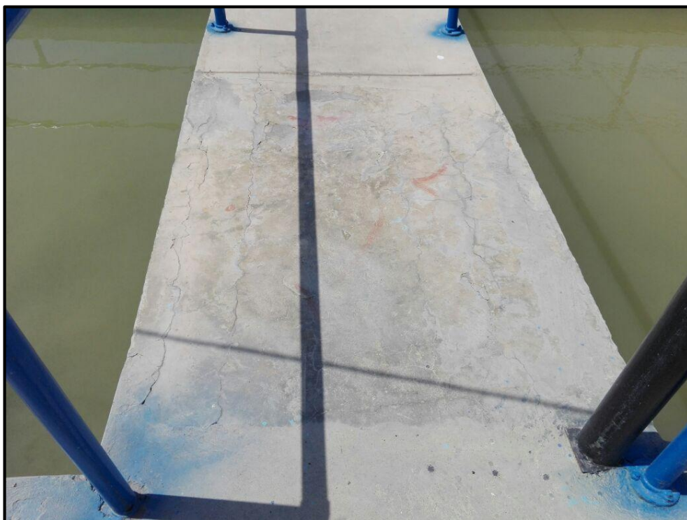
Foto N°17: Fisuras en losa
