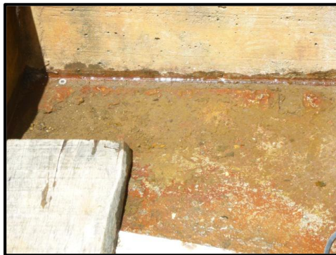
Figura N° 01. Erosión en el fondo. Fuente: Informe Sobre Patologías en la Planta El Dorado
