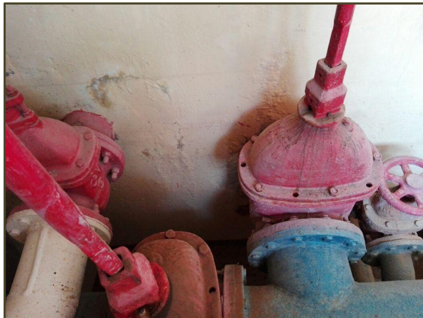
Foto N°04: Filtración en muro de concreto
