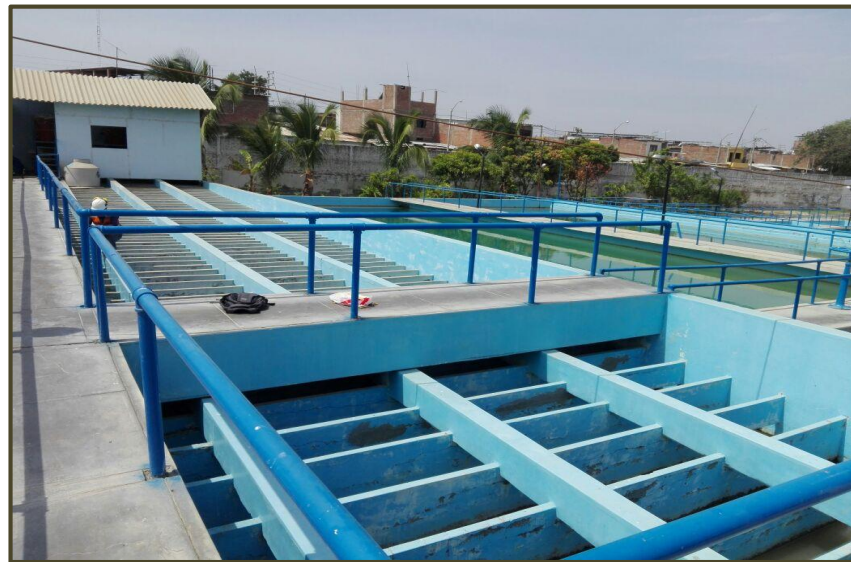
Foto N°01: Floculador del Módulo I
