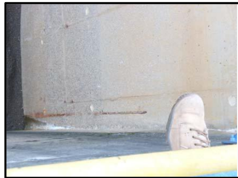
Figura N°02: Exposición de acero de refuerzo. Fuente: Informe Sobre Patologías en la Planta El Dorado
