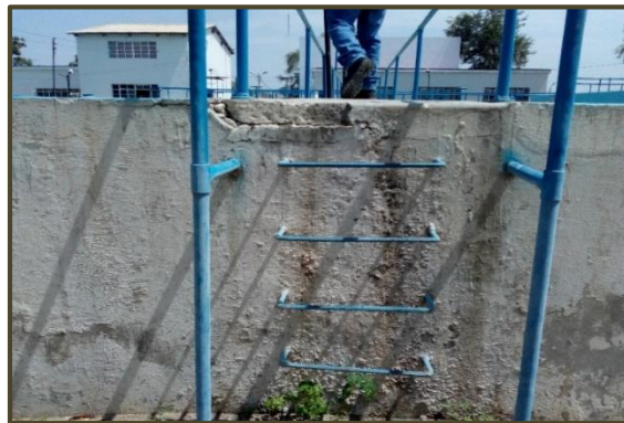
Foto N°08: Lixiviado en el concreto
