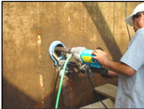
Figura N° 03: Extracción de testigos de concreto endurecido. Obsérvese la corrosión en el muro Fuente: CISMID-UNI
