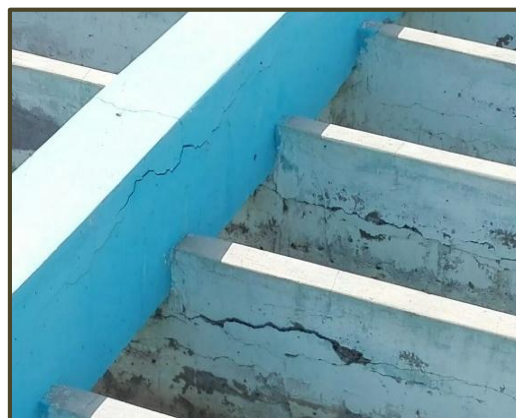
Foto N°07: Grieta en viga y en Pantalla de Flocculador
