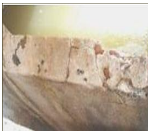
Figura N°14 Corrosión del Concreto
