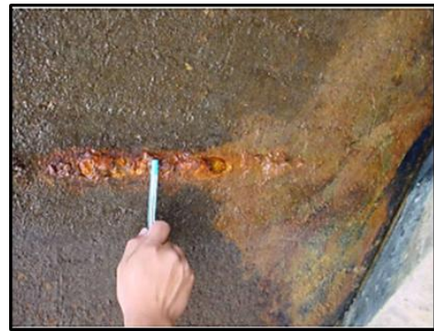
Figura N° 04: Corrosión del refuerzo en los muros de los decantadores Fuente: CISMID-UNI
