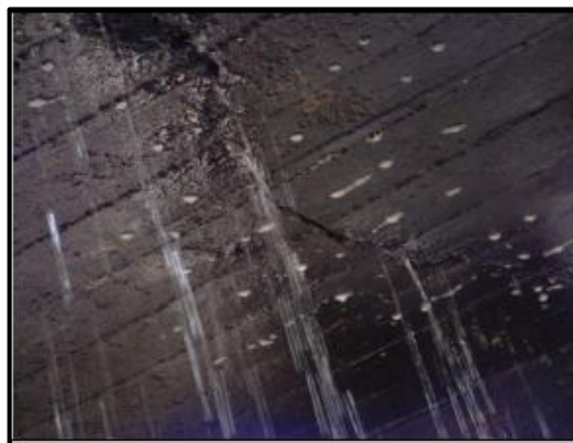
Figura N°05: Fisuras en canal de salida del decantador Fuente: CISMID-UNI
