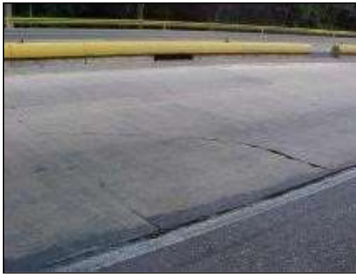
Figura 17, Falla Grietas Diagonales
