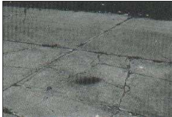
Figura 19, Falla Losa Dividida
