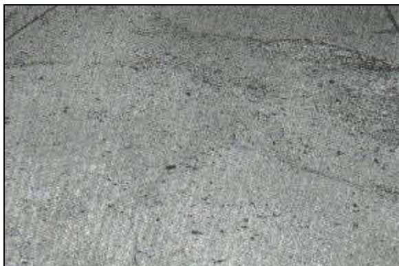
Figura 20, Falla Grietas de Durabilidad “D”
