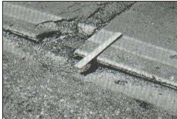
Figura 12, Falla de Asentamiento
