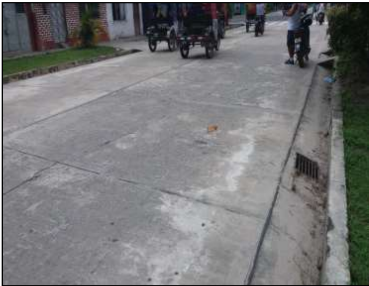
Figura 61, Vista de falla de Desconchamiento UM-01
