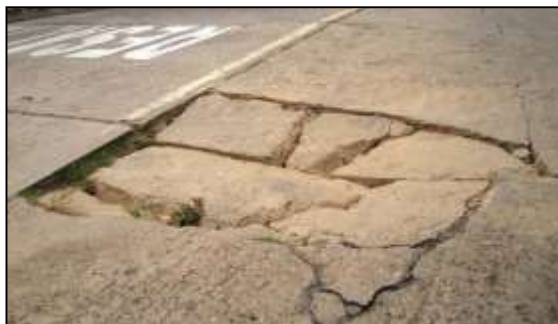
Figura 13, Falla de Bache
