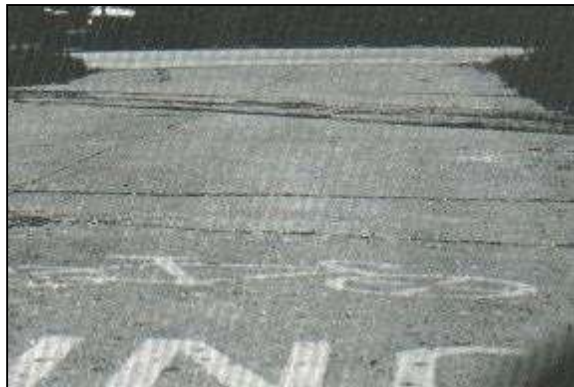
Figura 08, Falla Cruce de Vía Férrea
