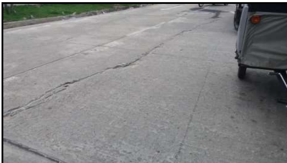
Figura 57, Vista del pavimento de concreto con presencia de grieta lineal
