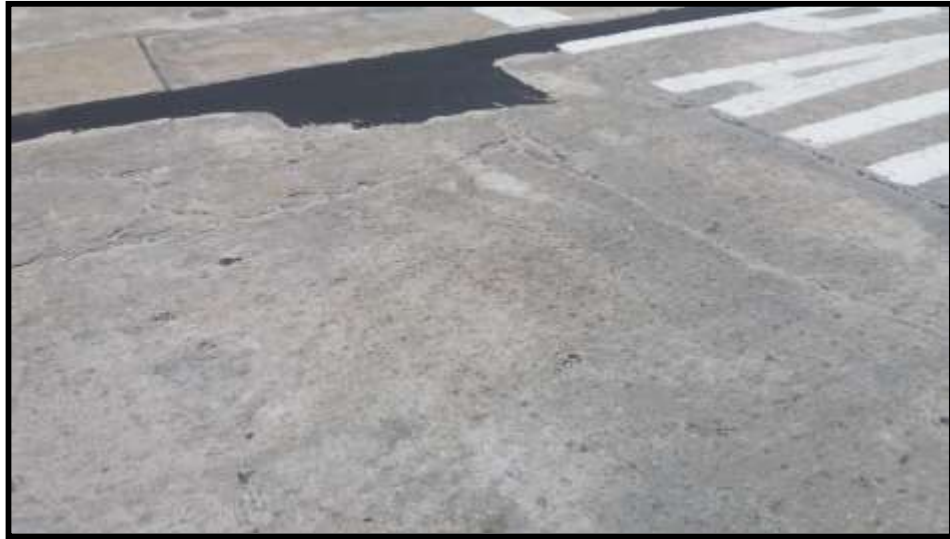
Figura 58, Vista de falla de Parqueo Grande
