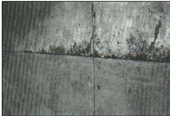
Figura 11, Falla Descaramiento de Junta.
