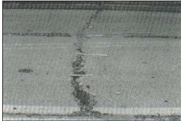
Figura 15, Falla Grietas Longitudinales
