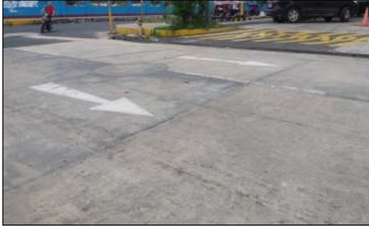
Figura 60, Vista de falla de Desconchamiento UM-05
