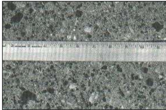
Figura 14, Falla Superficie Pulimentada
