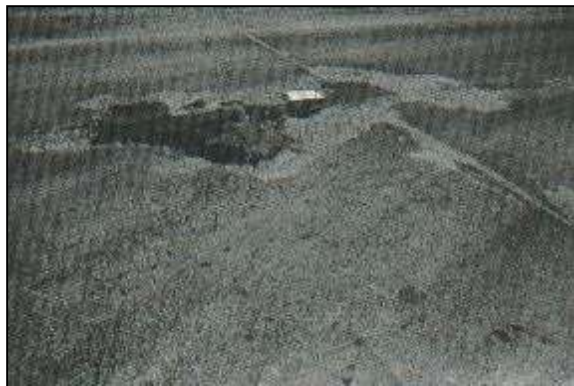
Figura 09, Falla Desconchamiento, Mapa de Grietas, Craquelado
