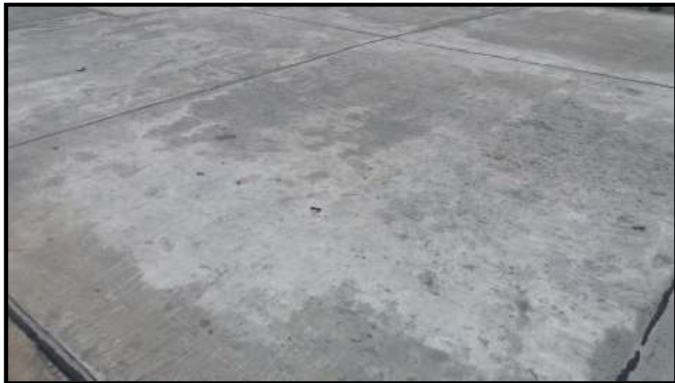
Figura 59, Vista de falla de Desconchamiento UM-03
