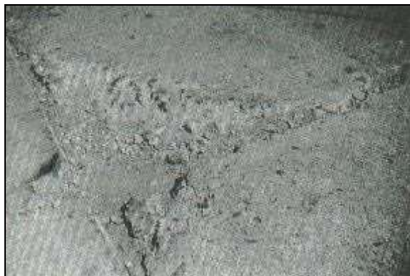
Figura 10, Falla Descaramiento de Esquina
