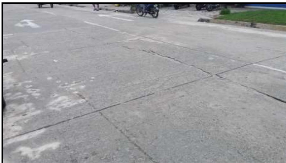
Figura 56, Vista del pavimento de concreto con presencia de grieta lineal y desconchamiento
