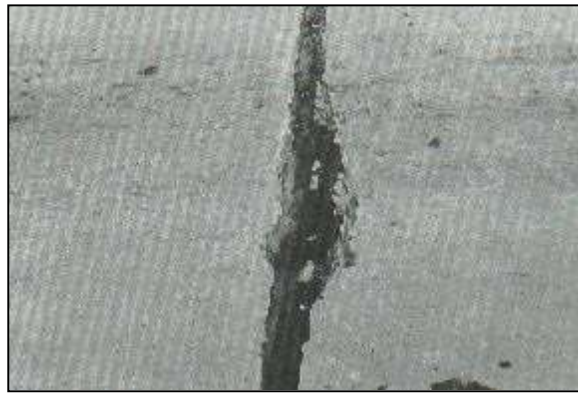
Figura 22, Falla Daño del Sello de Junta
