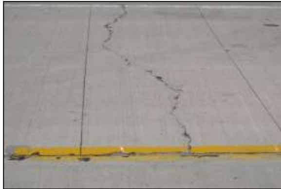
Figura 16, Falla Grietas Transversales
