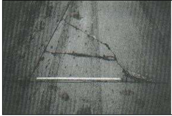
Figura 18, Falla Grieta en Esquina
