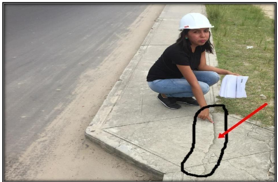
Figura 145 : Vista fotográfica UM2 -I, superficie del pavimento de vereda presenta un tipo de falla Grieta Lineal severidad media. (Calle Iquitos, cdra. 13)
