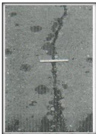
Figura 34. Grietas lineales de severidad media en losa de concreto reforzado
