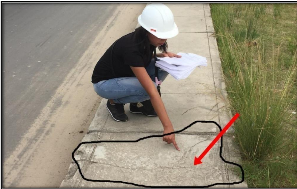
Figura 142 : Vista fotográfica UM2 -I, superficie del pavimento de vereda presenta un tipo de falla Losa Dividida de severidad media. (Calle Iquitos, cdra. 13)
