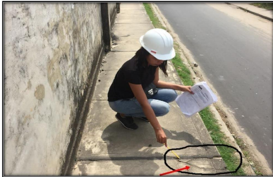
D, superficie del pavimento de vereda present un tipo de falla Grieta de Esquina severidad alta.
