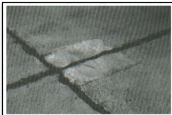
Figura 37. Parche pequeño de baja severidad.
