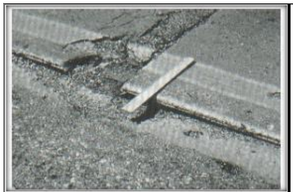
Figura 33. Desnivel carril / berma de severidad baja
