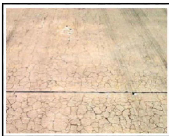
Figura 43. Desconchamiento / mapa de Fisura de baja severidad
