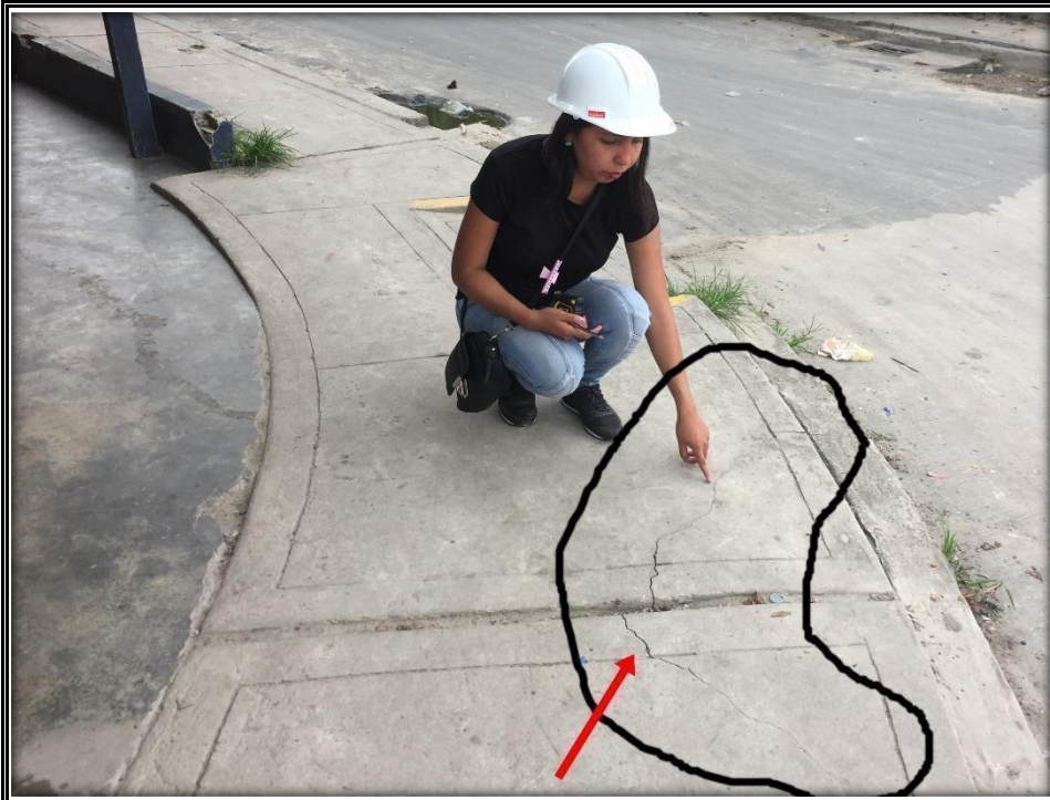
Figura 160 : Vista fotográfica UM5I, superficie del pavimento de vereda presenta
