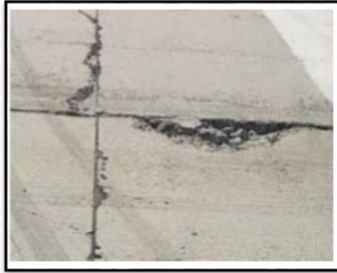
Figura 46. Descascaramiento de junta de severidad alta.
