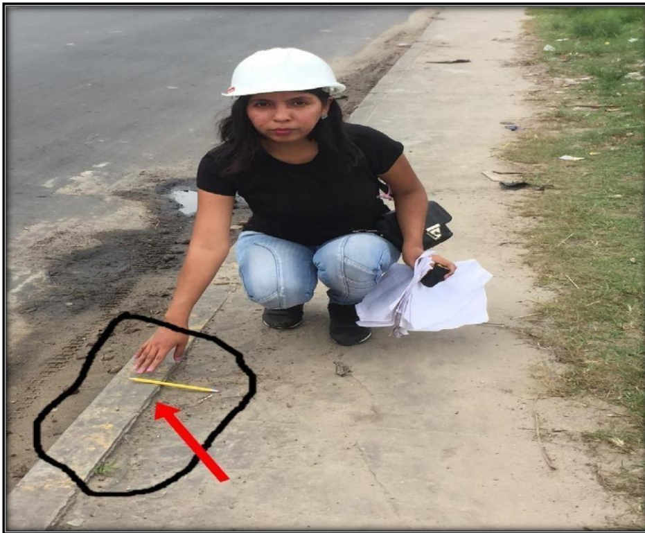
Figura 159: Vista fotográfica UM5-I, superficie del pavimento de vereda presenta un tipo de falla Escala severidad media. (Calle Iquitos, cdra. 16)
