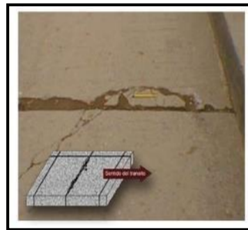
Figura 14. Desportillamiento de Juntas.
