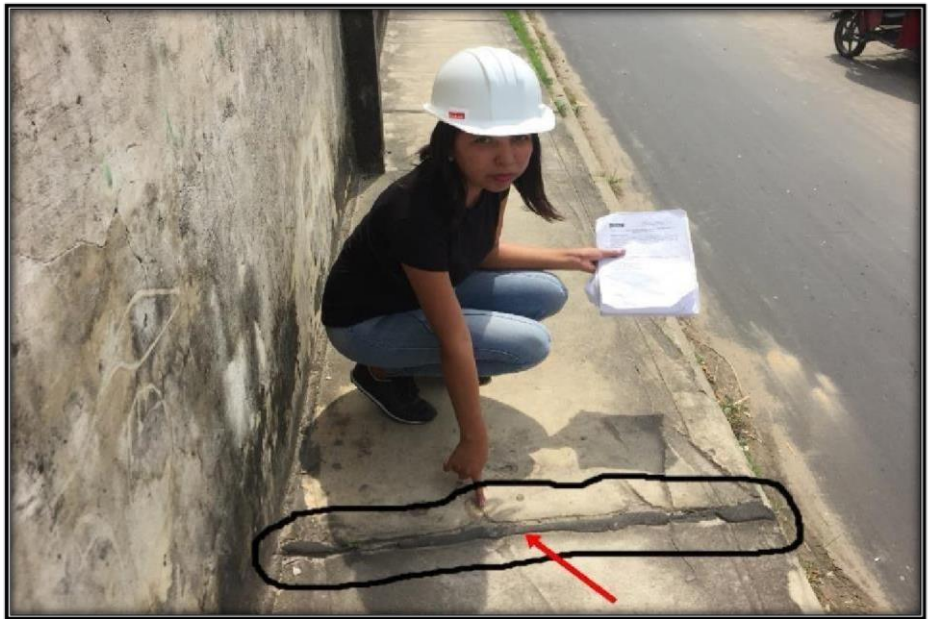
Figura 147: Vista fotográfica UM3 -D, superficie del pavimento de vereda presenta un tipo de falla Descascaramiento de Junta severidad media. (Calle Iquitos, cdra. 14)
