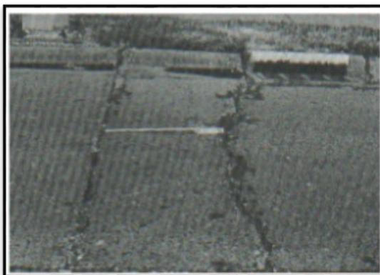
Figura 41. Punzonamiento de baja severidad.
