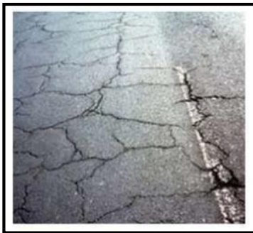
Figura 19. Fisuras en bloque.
