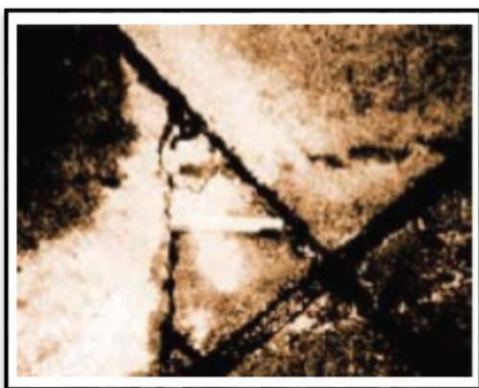
Figura 45. Descascaramiento de esquina de severidad media.
