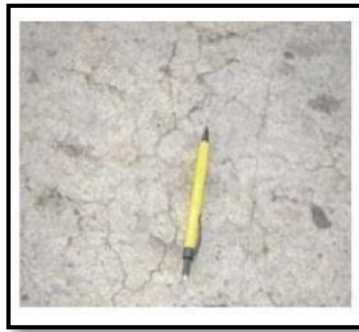
Figura 15. Fisura por Retracción O tipo malla
