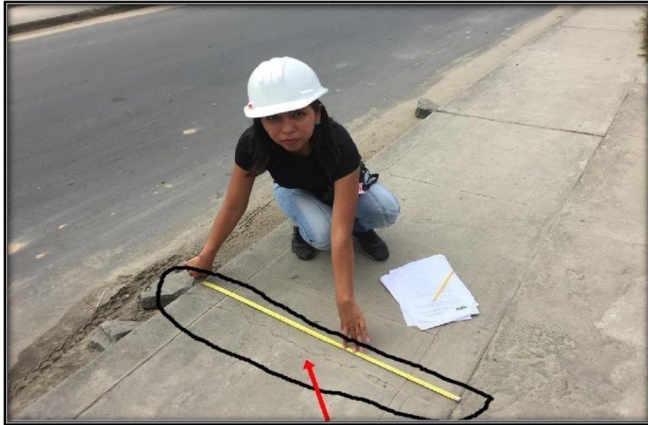
Figura 161: Vista fotográfica UM5-I, superficie del pavimento de vereda presenta un tipo de falla Grieta Lineal severidad media. (Calle Iquitos, cdra. 16)
