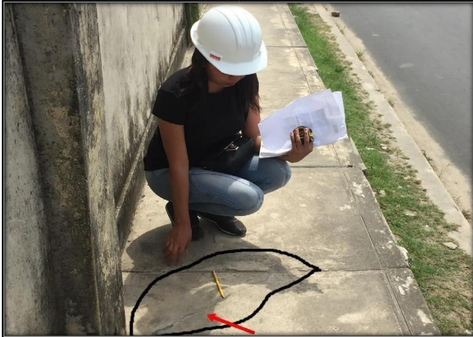
Figura 149: Vista fotográfica UM3-D, superficie del pavimento de vereda presenta un tipo de falla Grieta de Esquina severidad baja. (Calle Iquitos, cdra. 14)
