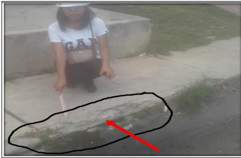
Figura 155: Vista fotográfica UM4-I, superficie del pavimento de vereda presenta un tipo de falla Desnivel carril/berma severidad baja.
