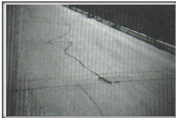
Figura 29. Losa dividida de mediana severidad
