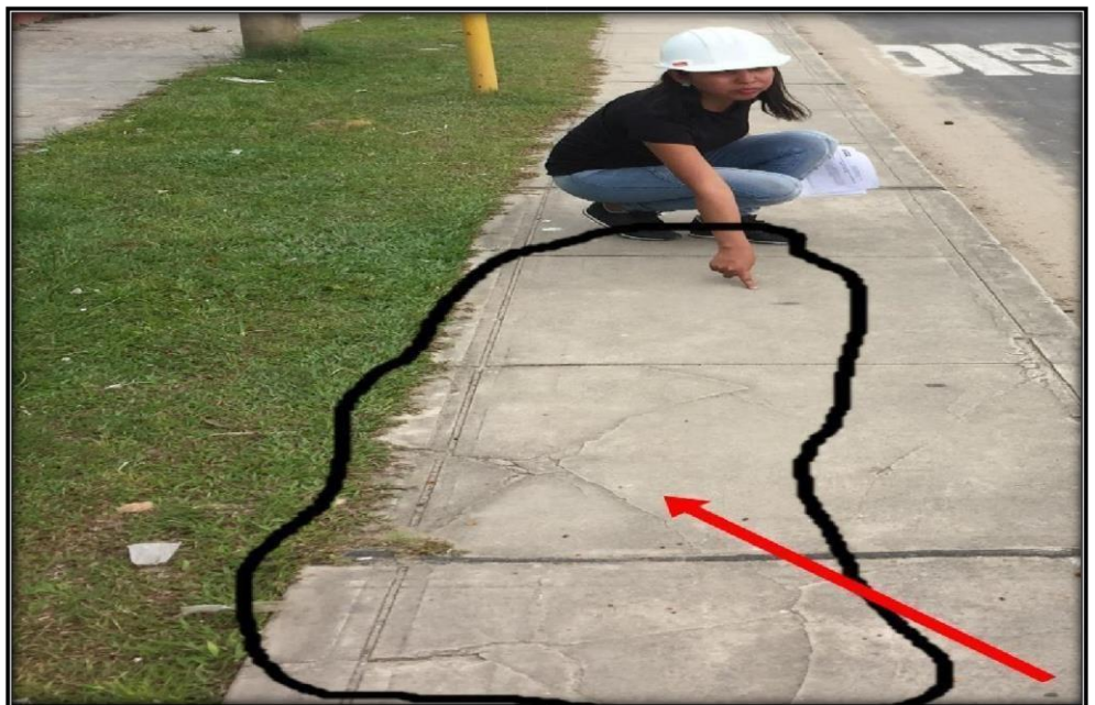
Figura 158: Vista fotográfica UM5-I, superficie del pavimento de vereda presenta un tipo de falla Losa Dividida severidad media. (Calle Iquitos, cdra. 16)
