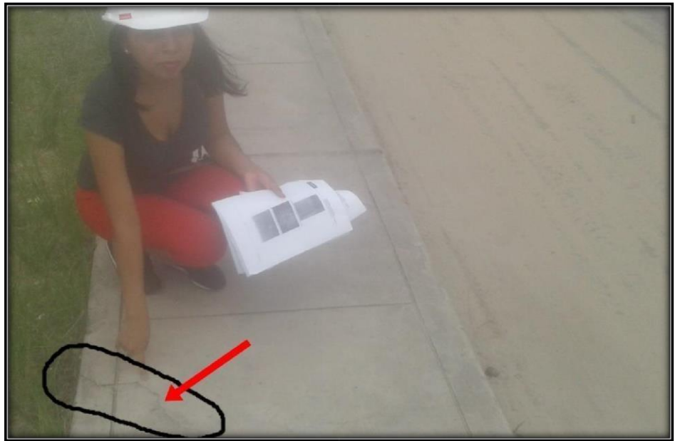
Figura 144: Vista fotográfica UM2-I, superficie del pavimento de vereda presenta un tipo de falla Grieta de Retracción no tiene severidad. (Calle Iquitos, cdra. 13)
