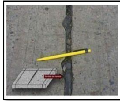
Figura 18. Deficiencia de Material
