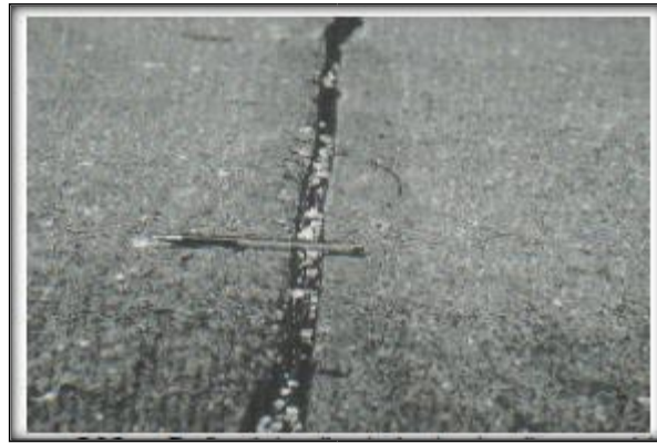
Figura 32. Daño del sello de junta de severidad alta
