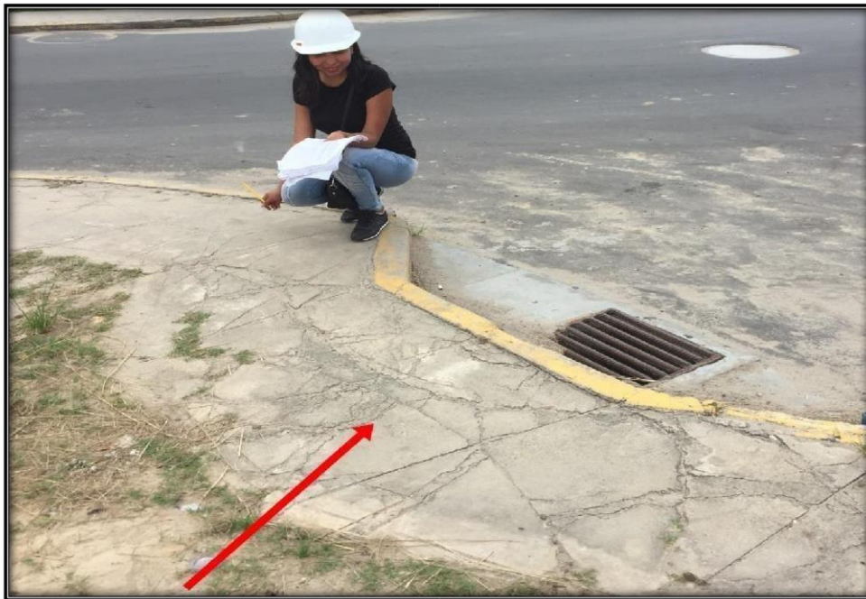
Figura 154: Vista fotográfica UM4-I, superficie del pavimento de vereda presenta un tipo de falla Punzonamiento severidad alta. (Calle Iquitos, cdra. 15)
