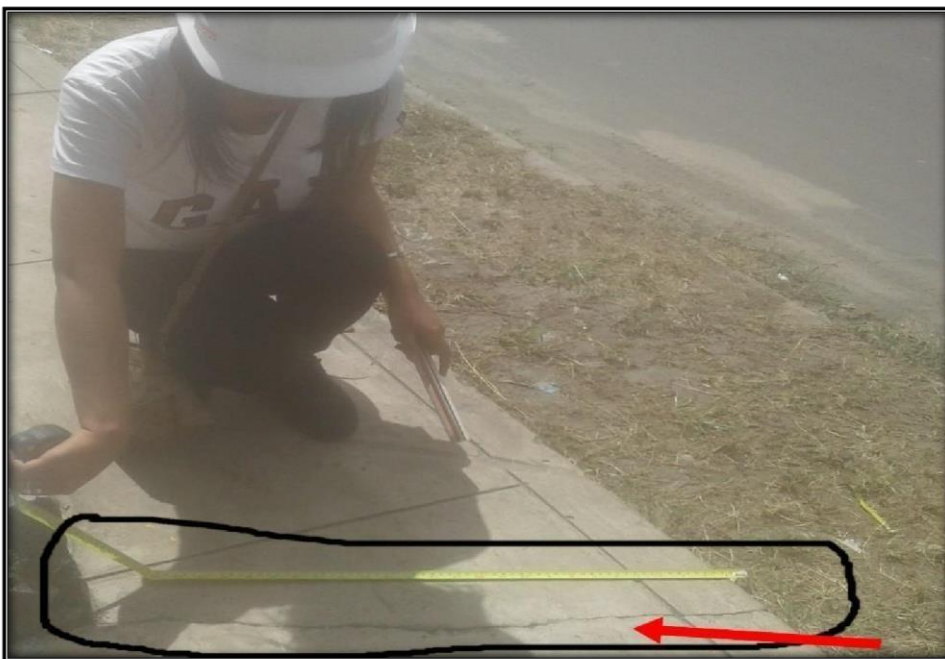
Figura 143: Vista fotográfica UM2 -I, superficie del pavimento de vereda presenta un tipo de falla Grieta de Esquina de severidad media. (Calle Iquitos, cdra. 13)
