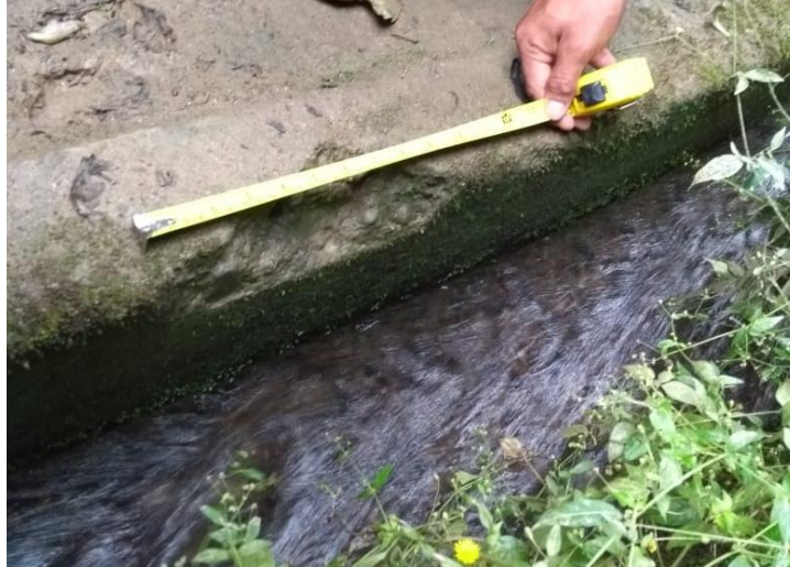
Gráfico 9: Desprendimiento en concreto.
