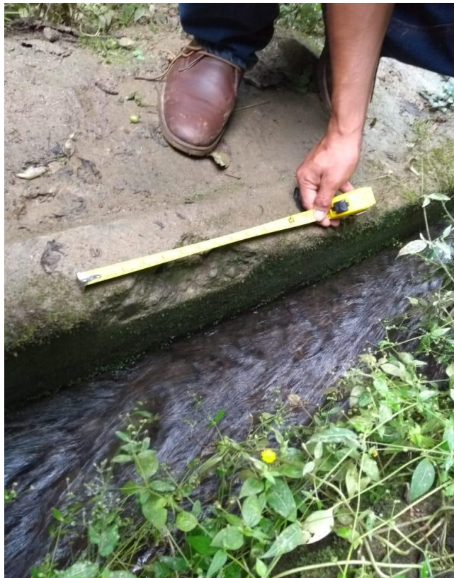
Gráfico 141: Desprendimiento en el margen lateral del canal.
