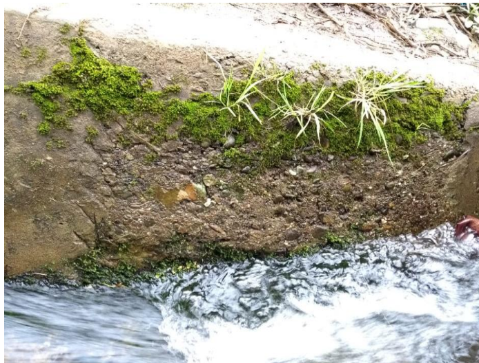
Gráfico 8: Erosión en canal de concreto.
