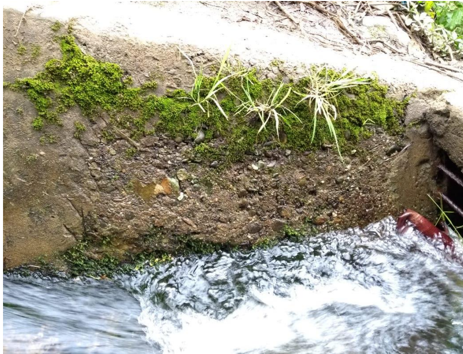
Gráfico 140: Erosión en losa lateral del canal.
