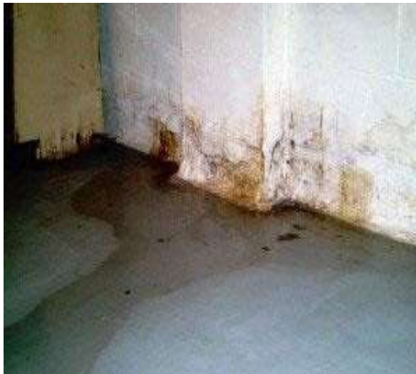
Imagen 4: Humedad por Filtración
