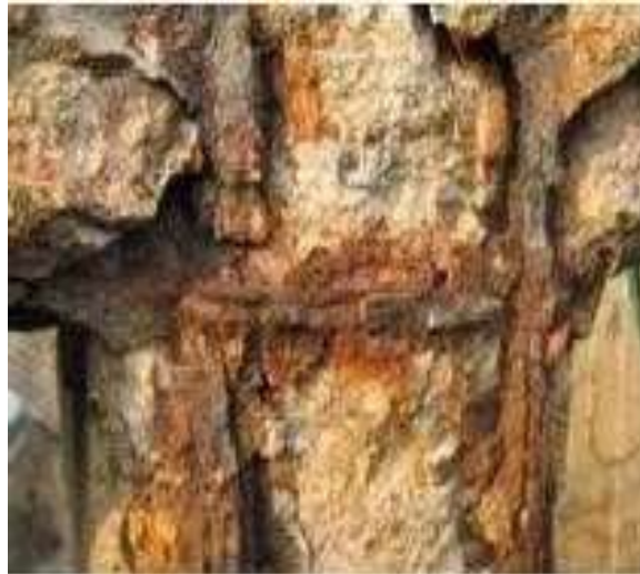
Imagen 8: Corrosión en el acero
