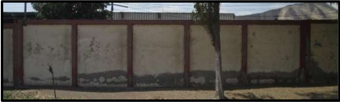
Fotografía 10 - Vista Panorámica de la Muestra 10 (Interior) del Cerco Perimétrico de la Institución Educativa “Eduardo Ferrick Ring”.
