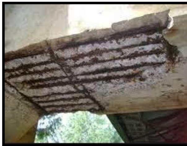
Figura 17. Corrosión de armaduras
