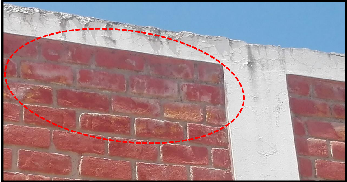
Fotos de Patologías más resaltantes como son la erosión que se visualiza en el cerco perimétrico.
