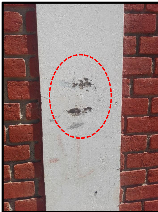
Fotos de Picaduras que se presentan en la Columna
