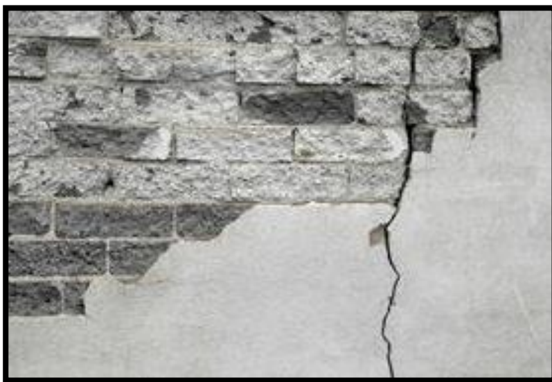
Figura 11. Imagen de grieta.
