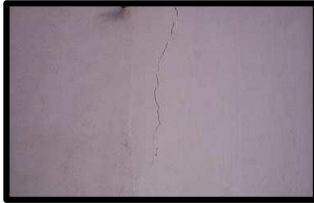
Figura 14. Imagen de fisura en muro.
