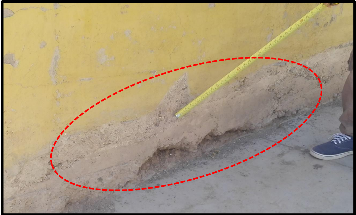
Fotos de Patologías (erosión) más resaltantes mostradas en el cerco perimétrico.
