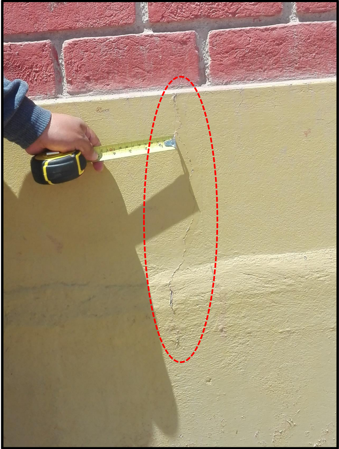
Fotos de Fisuras que presenta el cerco perimétrico.
