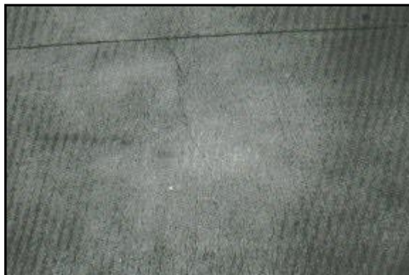
Figura 10: Falla por grieta de retracción
