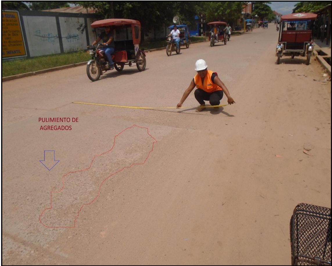
Figura 94: Daño Pulimento de Agregados
