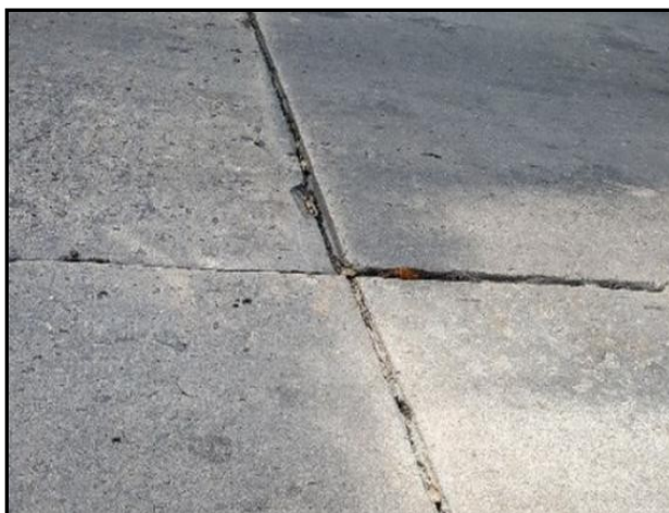
Figura N°08: Falla por descascamiento de junta.
