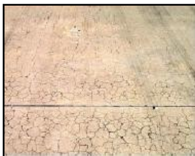
Figura 11: Desconchamiento, mapa de grietas, craquelado.
