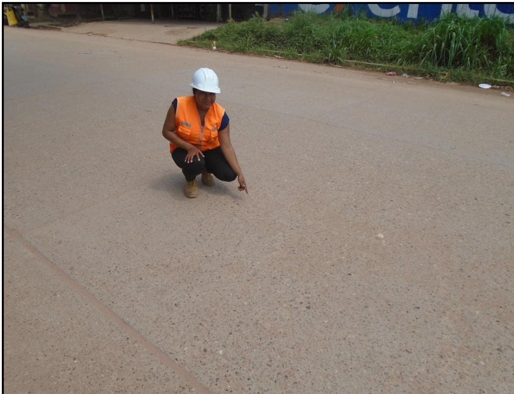
Figura 91: Vista Daño de Grieta Lineal severidad Baja.
