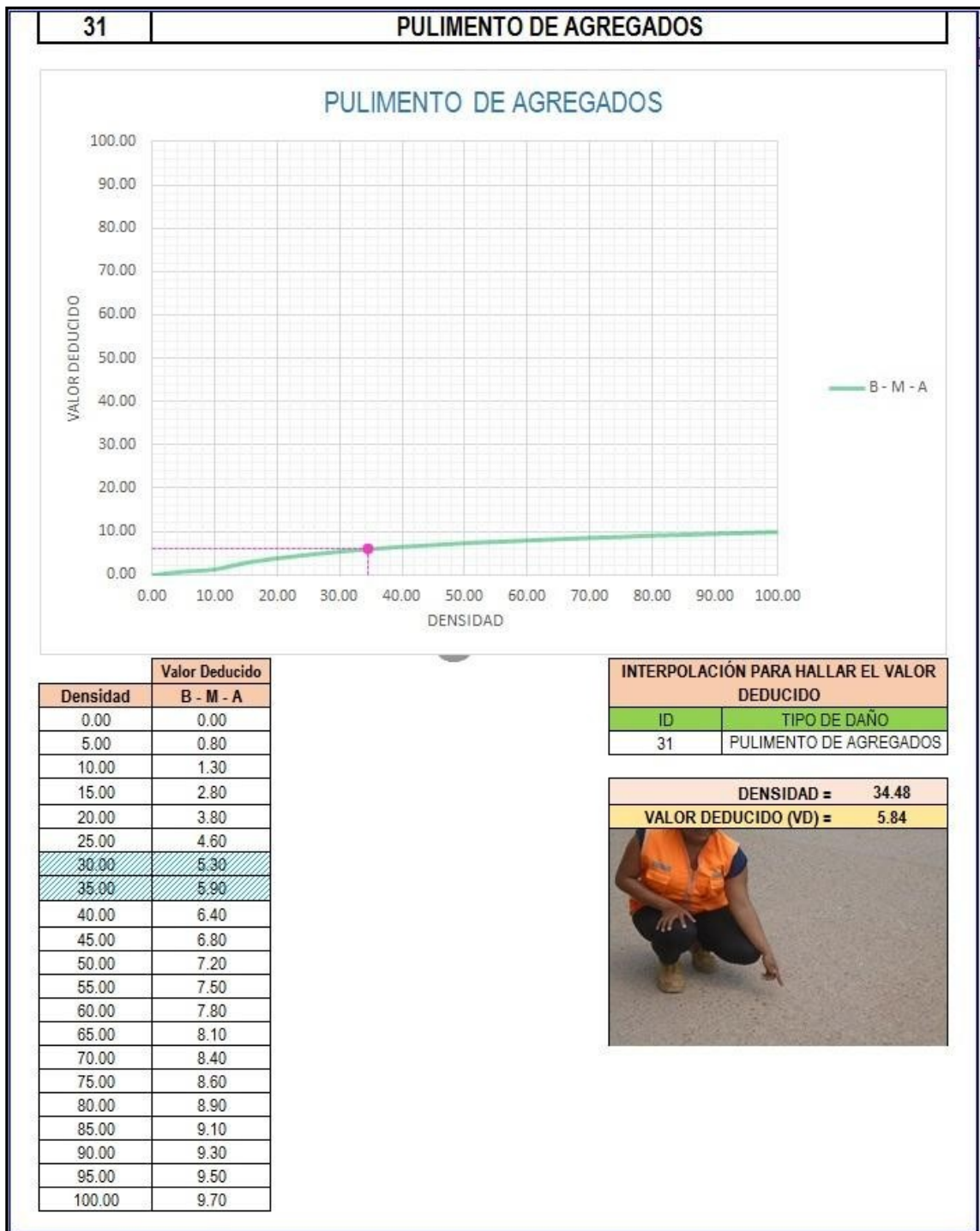
Figura 45: Grafico de las Grietas de pulimento de agregados UM-02
