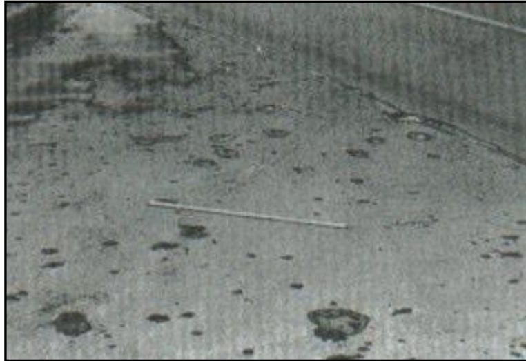
Figura N°15: falla por Popouts
