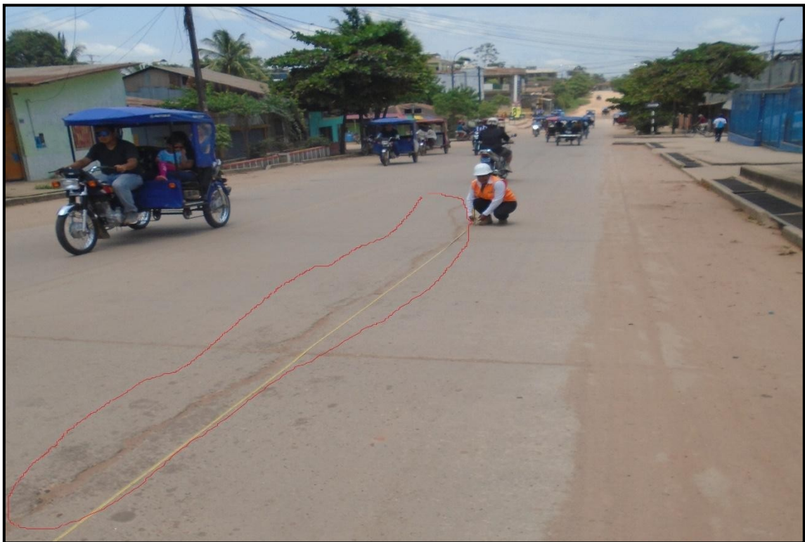
Figura 105: Vista daño Grieta Lineal severidad Alta
