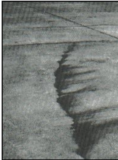
Figura 14: Falla por bombeo.
