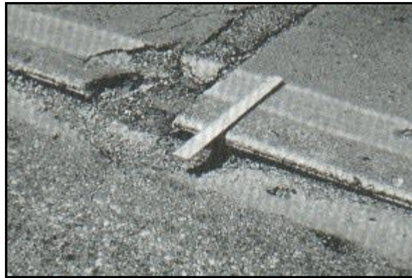
Figura 20: Falla por desnivel carril / berma.
