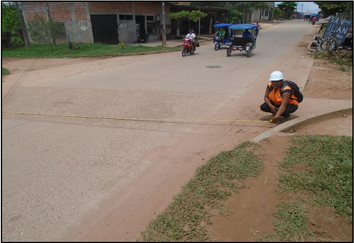
Figura 97: Vista de Daño Pulimento de Agregados
