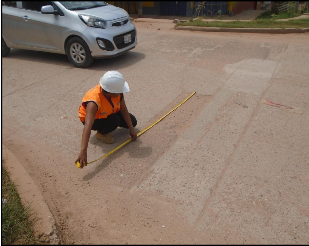
Figura 90: Vista daño Parche Grande.
