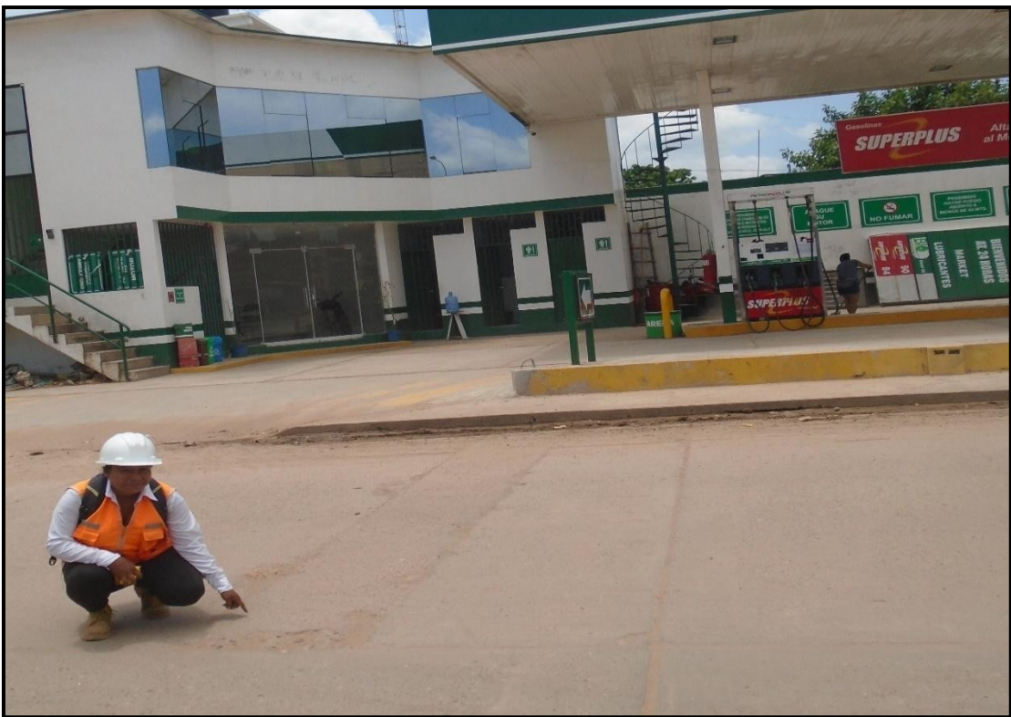
Figura 108: Daño Pulimento de Agregados y Parche Grande
