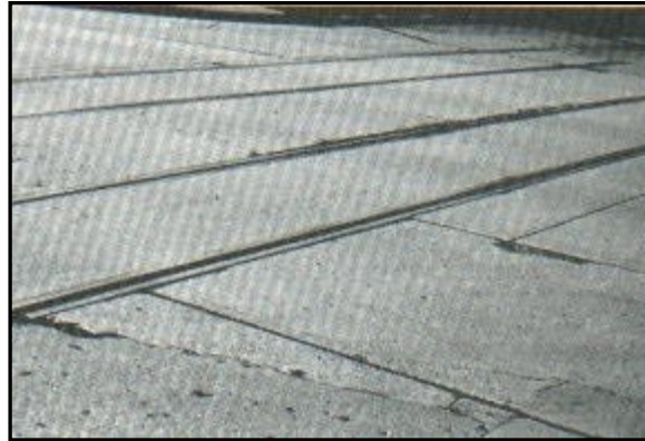
Figura 12: Falla por cruce de vía férrea
