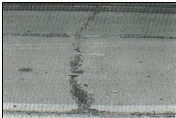
Figura 19: Falla grietas lineales.
