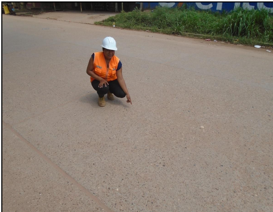
Figura 89: Vista Daño de Pulimiento de Agregados
