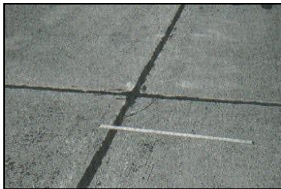
Figura 09: Falla por descascaramiento de esquina.
