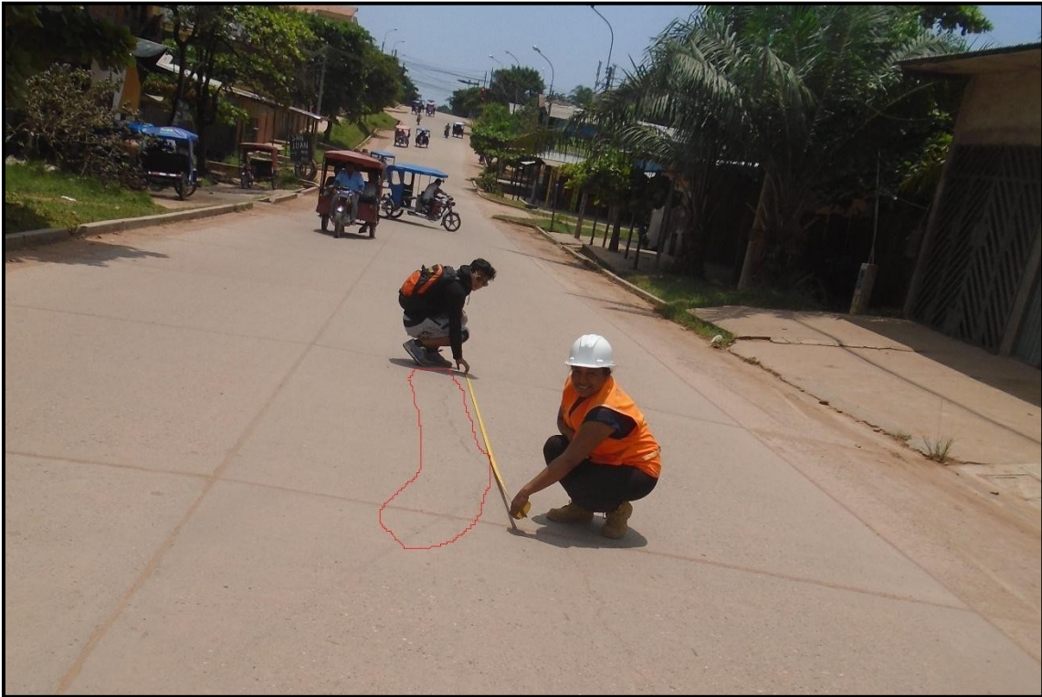
Figura 101: Vista daño Grieta Lineal severidad Baja.
