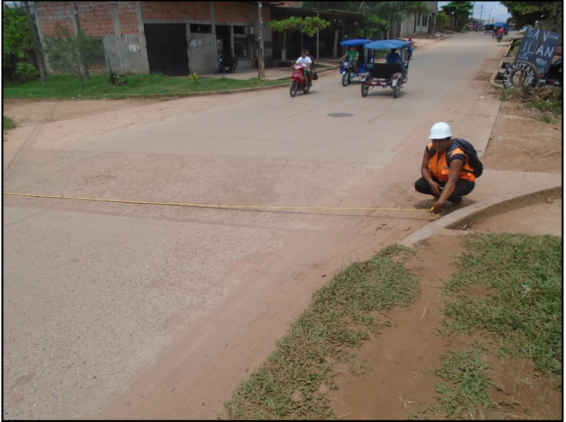
Figura 106: Vista daño Parche Grande
