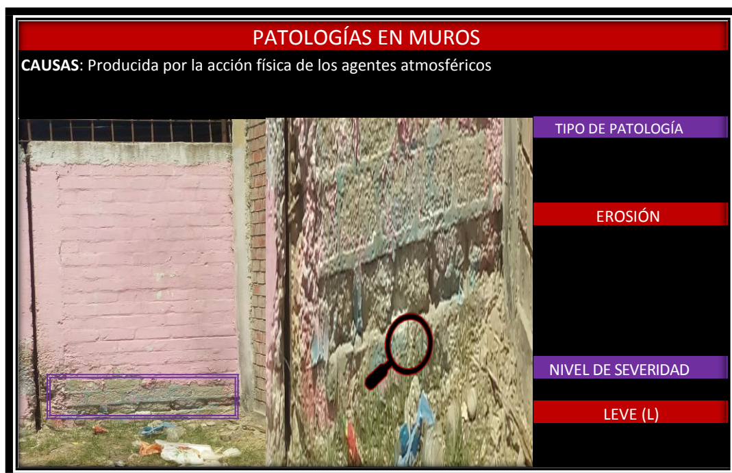
Fotografía N°26: Erosión del cerco perimétrico de la Institución Educativa Inicial N°754”
