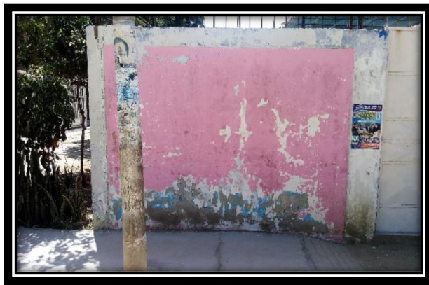
Fotografía N°22: Vista del tramo de la Muestra N°20 del cerco perimétrico de la Institución Educativa Inicial N°754”
