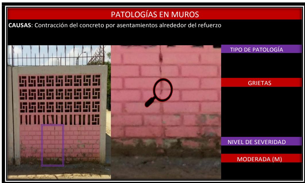
Fotografía N°25: Grieta del cerco perimétrico de la Institución Educativa Inicial N°754”
