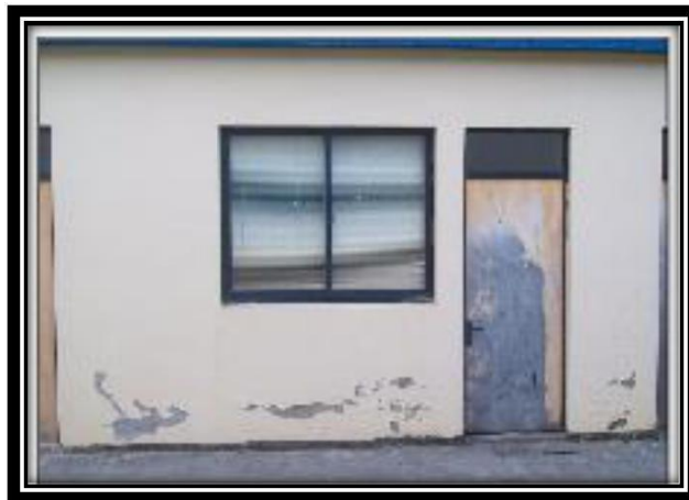
Imagen N°09: Eflorescencia y desprendimiento de pintura
