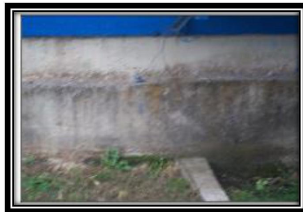
Imagen N°10: Humedad en el sobrecimiento
