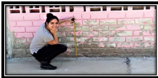
Fotografía N°30: Tomando medidas de las patologías del cerco perimétrico de la Institución Educativa Inicial N°754”
