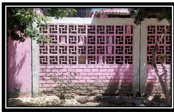
Fotografía N°17: Vista del tramo de la Muestra N°15 del cerco perimétrico de la Institución Educativa Inicial N°754”
