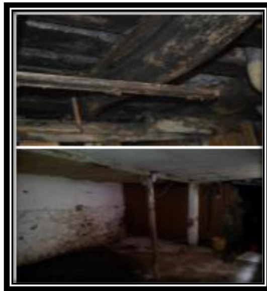
Imagen N°05: Fallo de viga de madera
