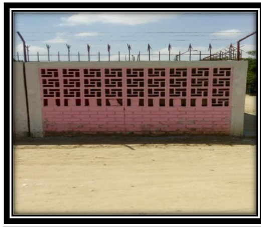
Fotografía N°07: Vista del tramo de la Muestra N°05 del cerco perimétrico de la Institución Educativa Inicial N°754”
