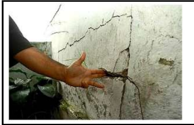
Figura 11. Imagen de grieta.
