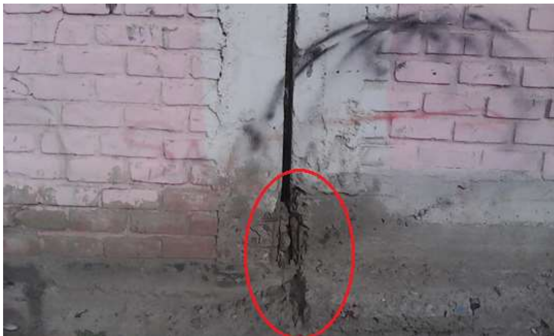
Patologías de corrosión en columna de muros confinados en la unidad de muestra 5 del cerco perimétrico I.E.P. “José Abelardo Quiñones
