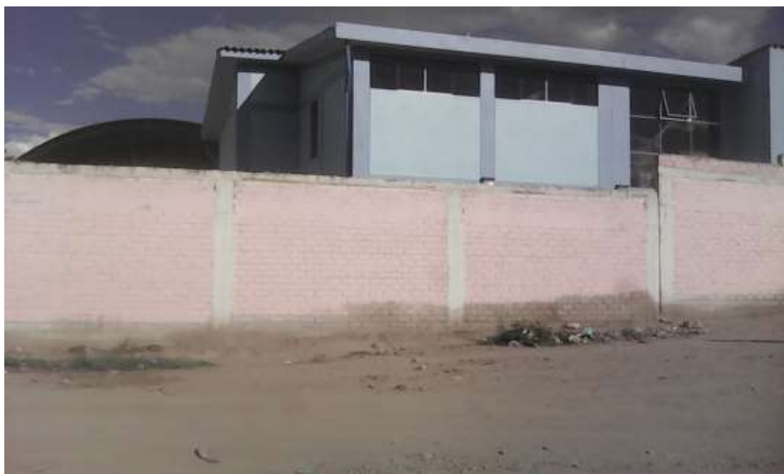
Muro confinado en el lado DC (ubicado hacia el oeste) del cerco perimétrico I.E.P. “José Abelardo Quiñones”
