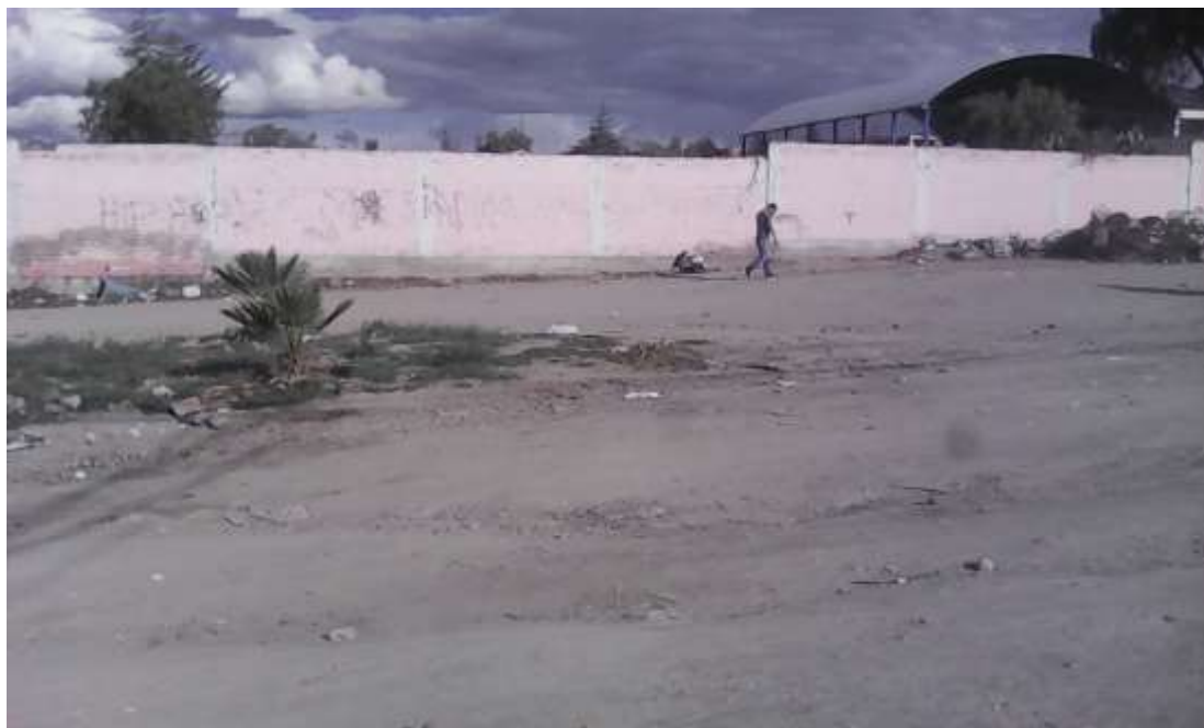
Prosigue el lado DC (ubicado hacia el oeste) en muros no confinados del cerco perimétrico I.E.P. “José Abelardo Quiñones”
