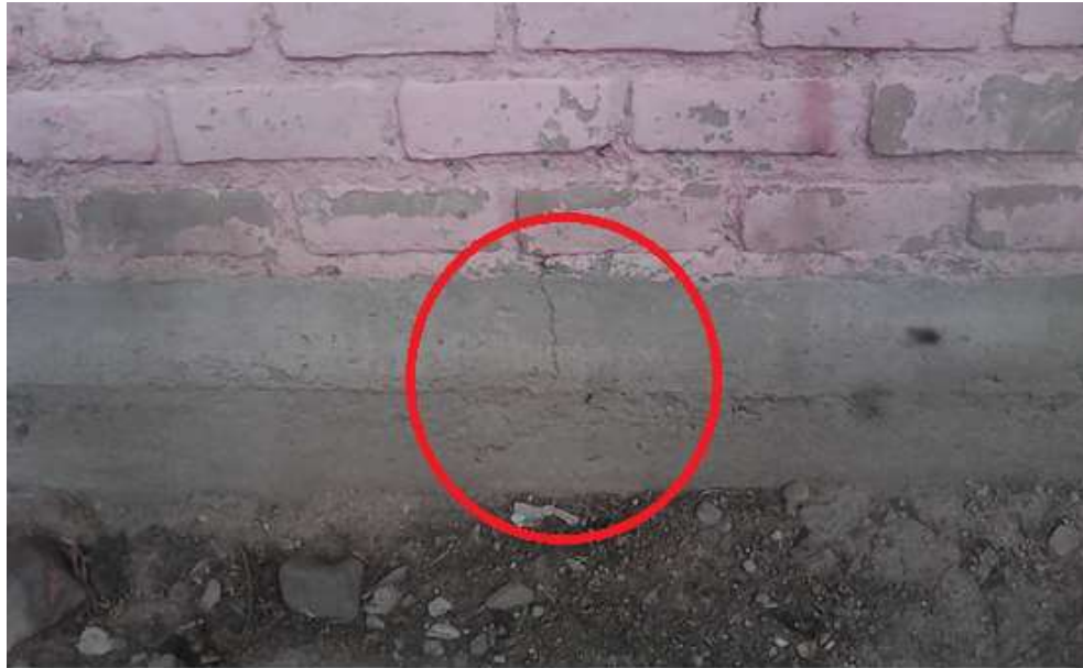
Patologías de fisura en sobrecimiento de muro confinado en la unidad de muestra 8 del cerco perimétrico I.E.P. “José Abelardo Quiñones
