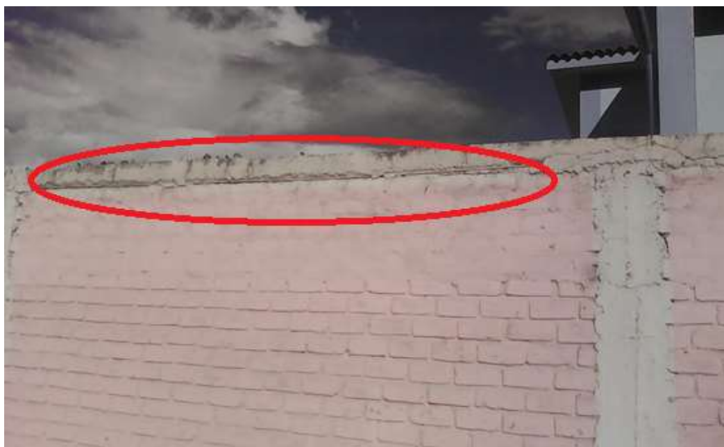
Patologías de oxidación en viga de muro confinado en la unidad de muestra 9 del cerco perimétrico I.E.P. “José Abelardo Quiñones
