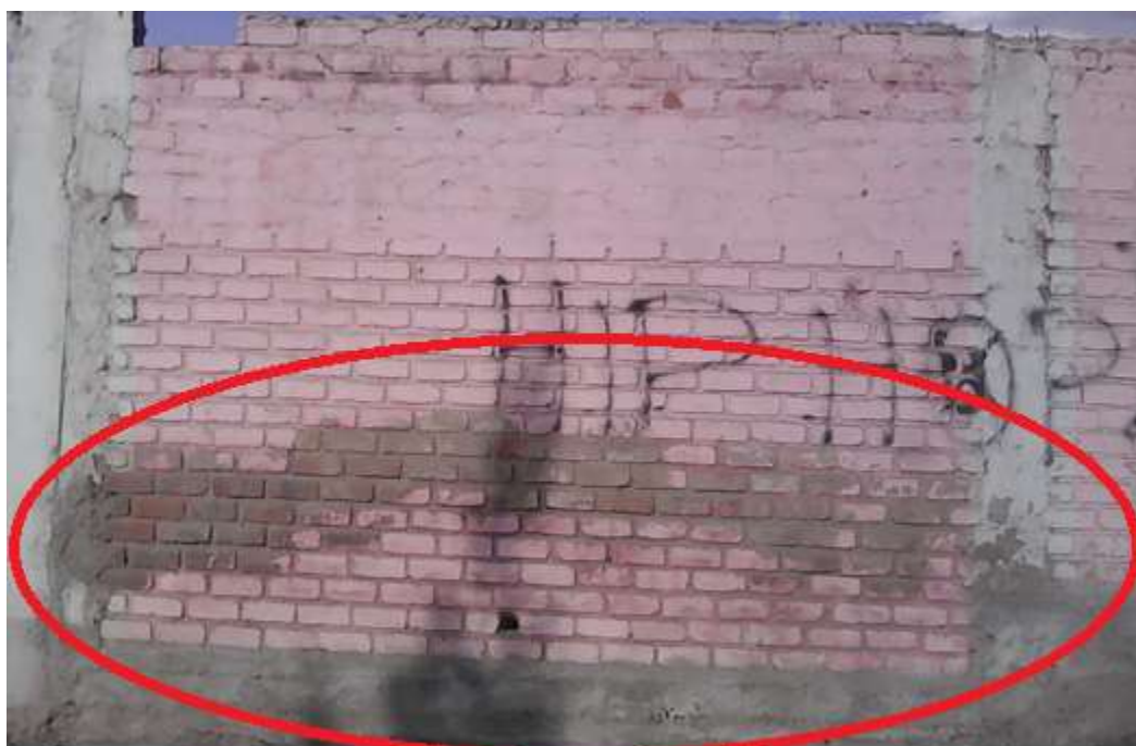
Patologías de eflorescencia en muro no confinado en la unidad de muestra 1 del cerco perimétrico I.E.P. “José Abelardo Quiñones
