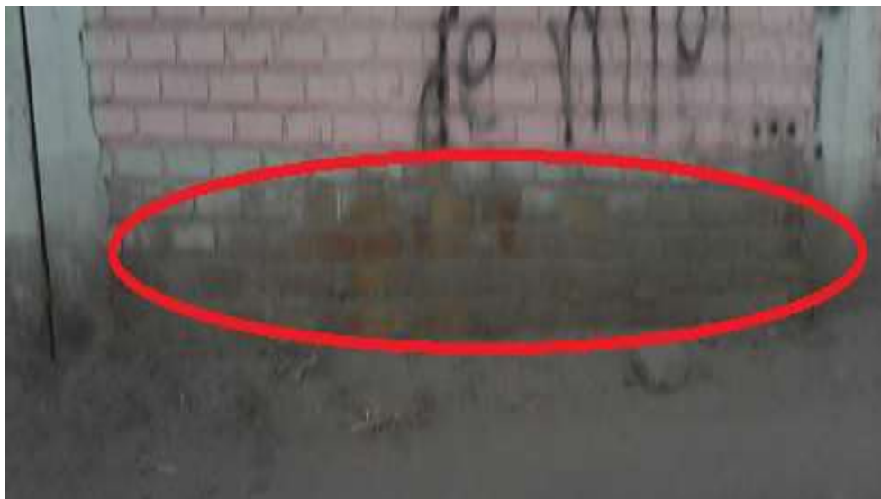
Patologías de erosión en muro confinado en la unidad de muestra 10 del cerco perimétrico I.E.P. “José Abelardo Quiñones
