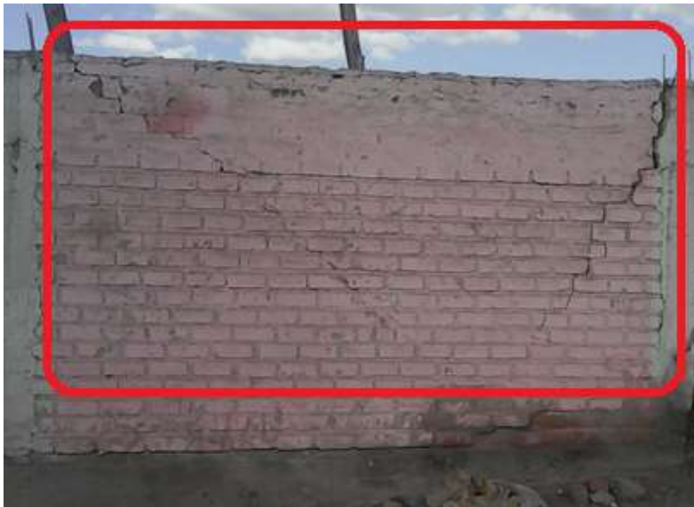
Patologías de Grieta en muro no confinado en la unidad de muestra 4 del cerco perimétrico I.E.P. “José Abelardo Quiñones
