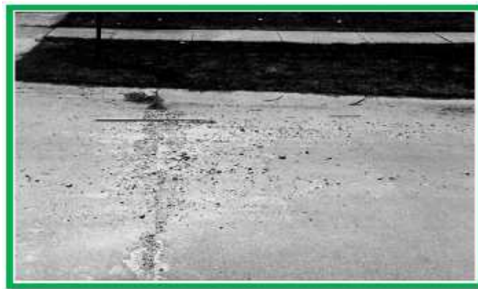
Figura 9. Falla por blowup/buckling
