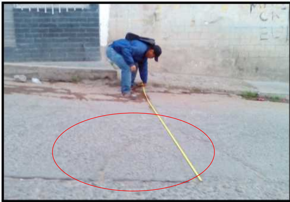
Figura 91. Falla de grieta de esquina de media severidad en la UM3 paño 4
