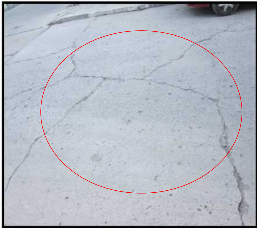
Figura 89. Falla de losa dividida de media severidad en la UM1 losa 05
