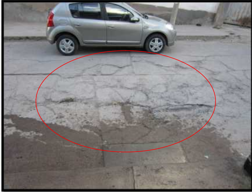
Figura 90. Falla de Punzamiento de alta severidad en la UM4 paño 6
