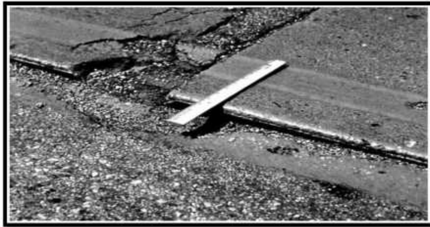
Figura 15. Desnivel de carril / berma.
