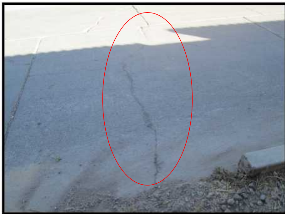
Figura 94. Falla de Grietas longitudinales de baja severidad en la UM3 paño 14.
