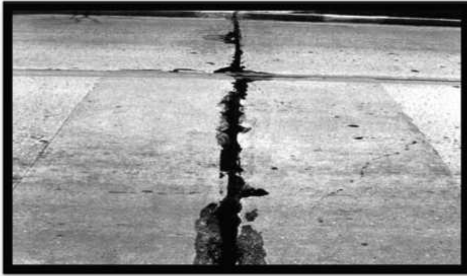
Figura 14. Daño de sello de junta
