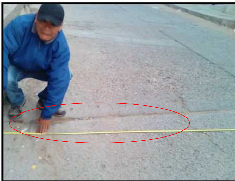
Figura 93. Falla de Descascaramiento de Junta en la UM3 paño 07
