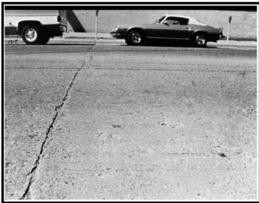
Figura 27. Descascaramiento de junta
