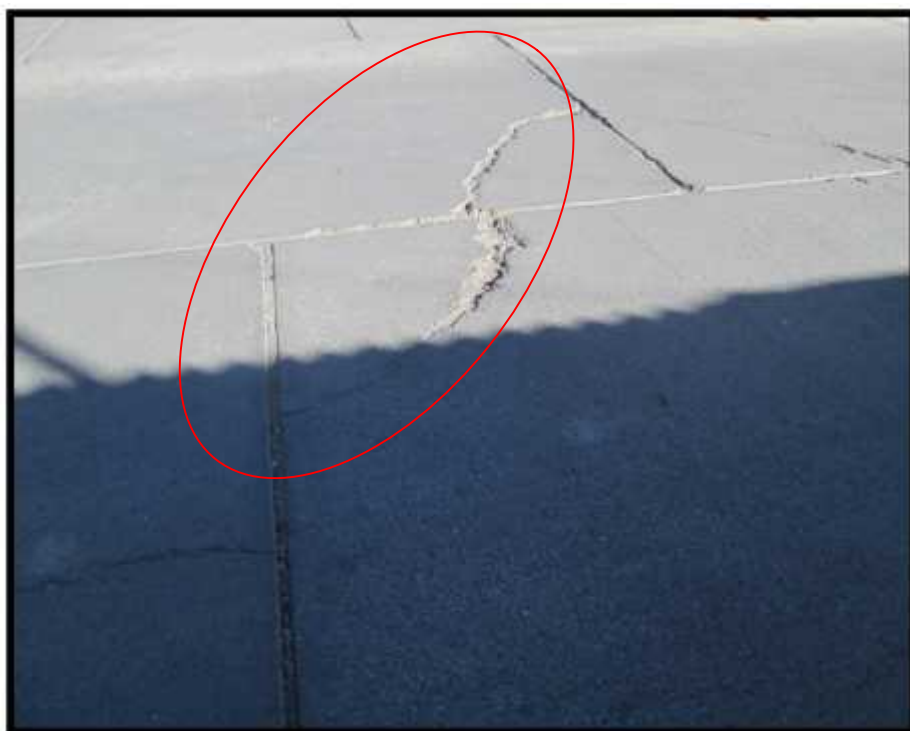
Figura 95. Falla de Grietas de esquina - baja severidad en la UM2 paño 8
