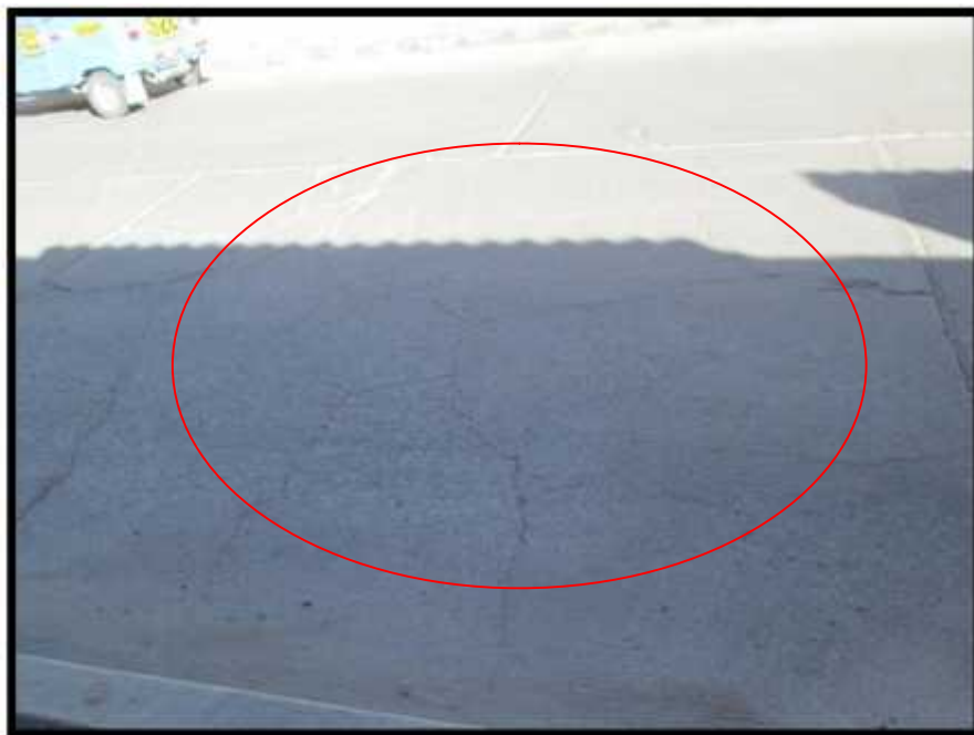
Figura 92. Falla de losa dividida de baja severidad en la UM2 paño 09
