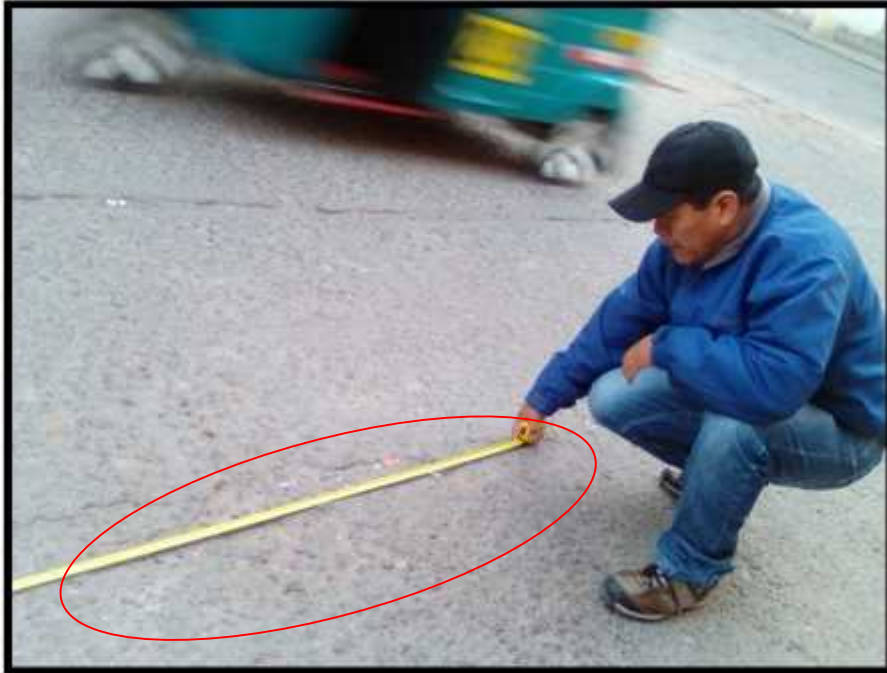
Figura 88. Toma de dato de una grieta lineal en MU3 paño 02
