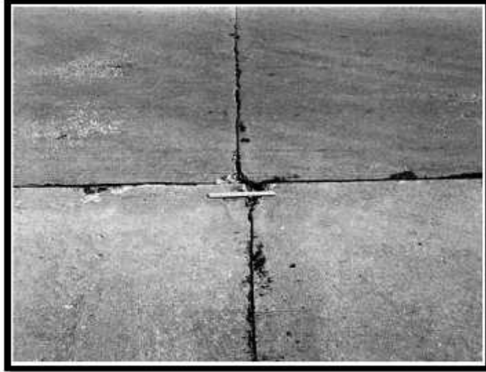
Figura 26. Descascaramiento de esquina.
