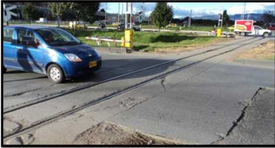
Figura 23. Falla por el cruce de vía férrea.
