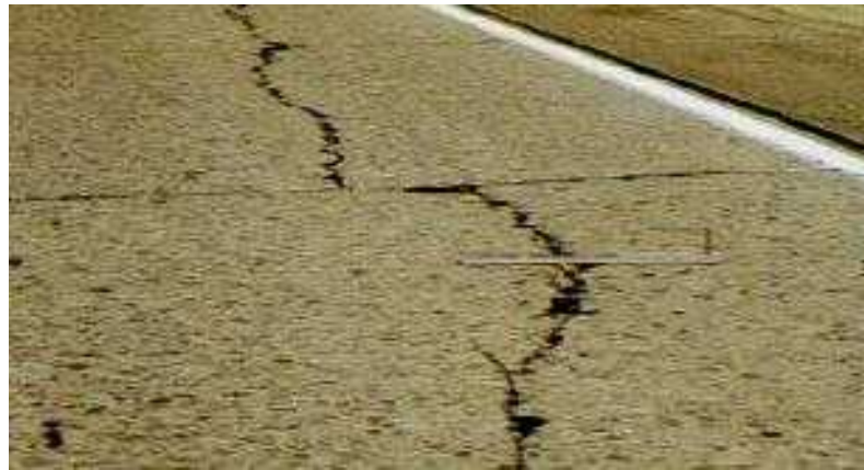
Figura 8. Deterioros más comunes en pavimento.
