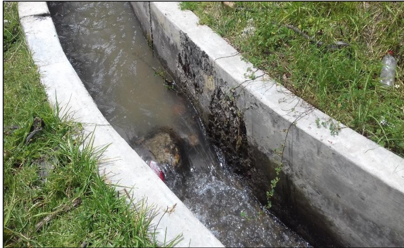
Imagen 05: degradación en la estructura del canal.
