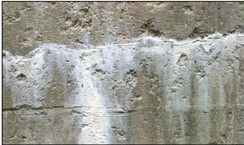
Imagen 06: Eflorescencia en las paredes del canal.
