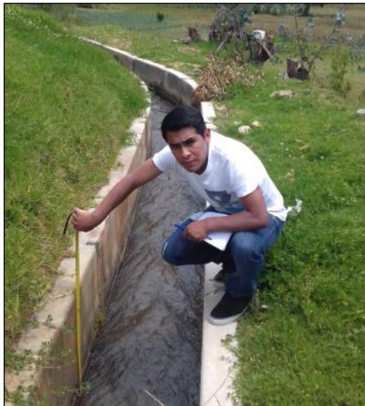
Imagen 12: mi persona tomando medidas de las áreas afectadas (mohos)
