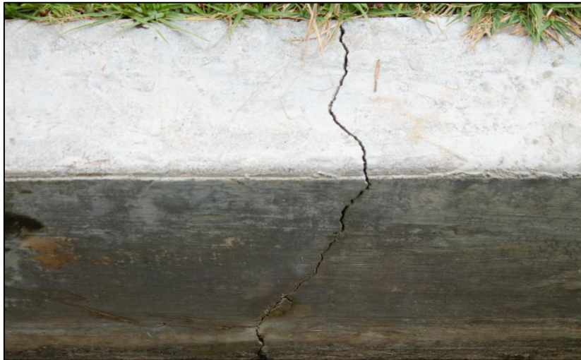
Imagen03:Grietas en la estructura del canal.
