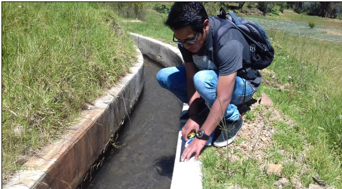
Imagen 18: Canal de riego Lucma, se observa fisura en el lado derecho del canal
