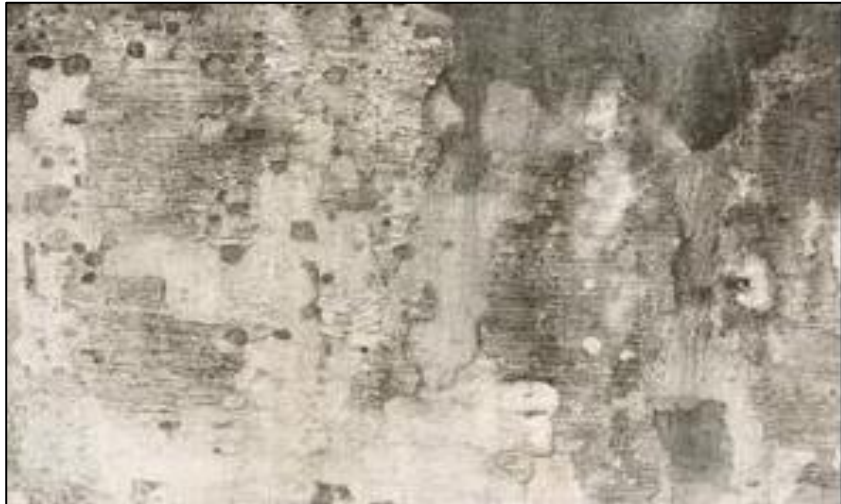
Imagen 08: Presencia de mohos.
