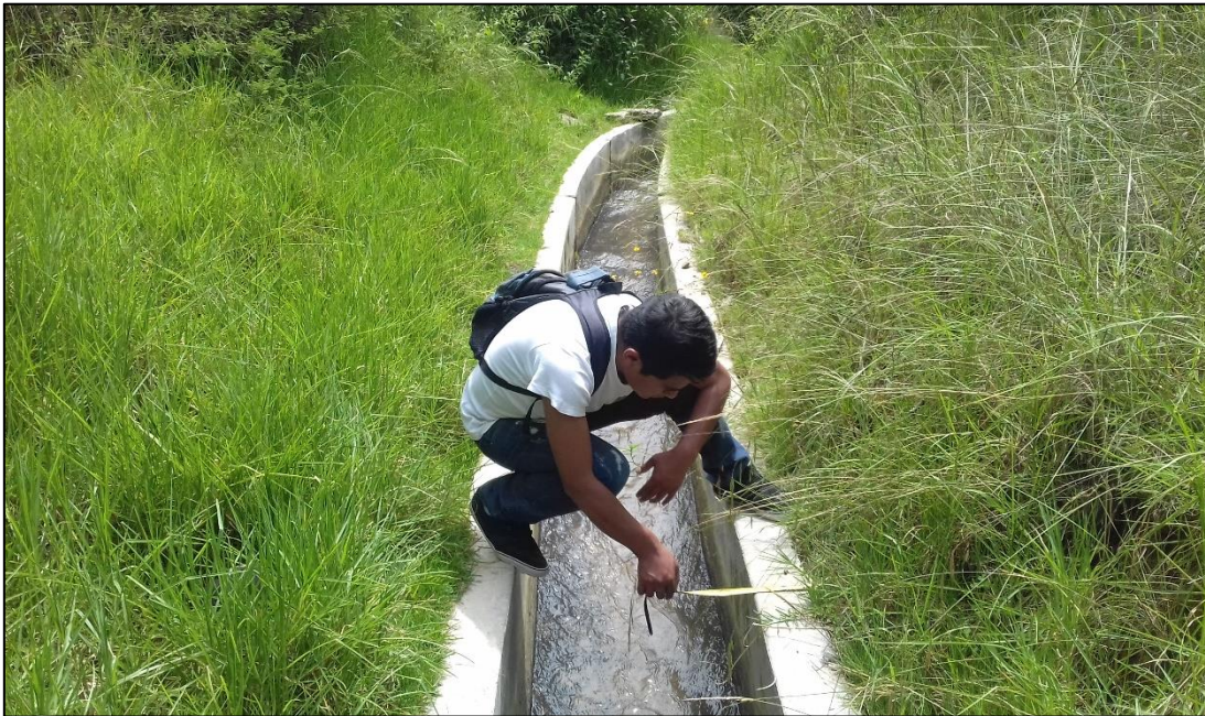
Imagen 16: Mi persona tomando medidas de las patologías (grieta)
