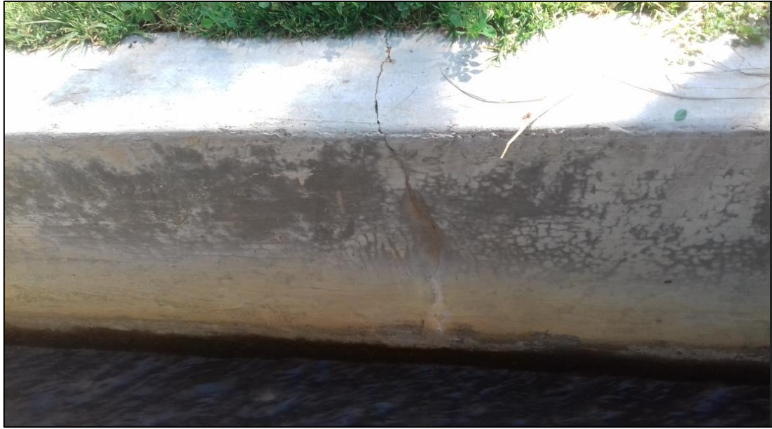
Imagen 17: Donde se aprecia la presencia de patologías (fisuras)
