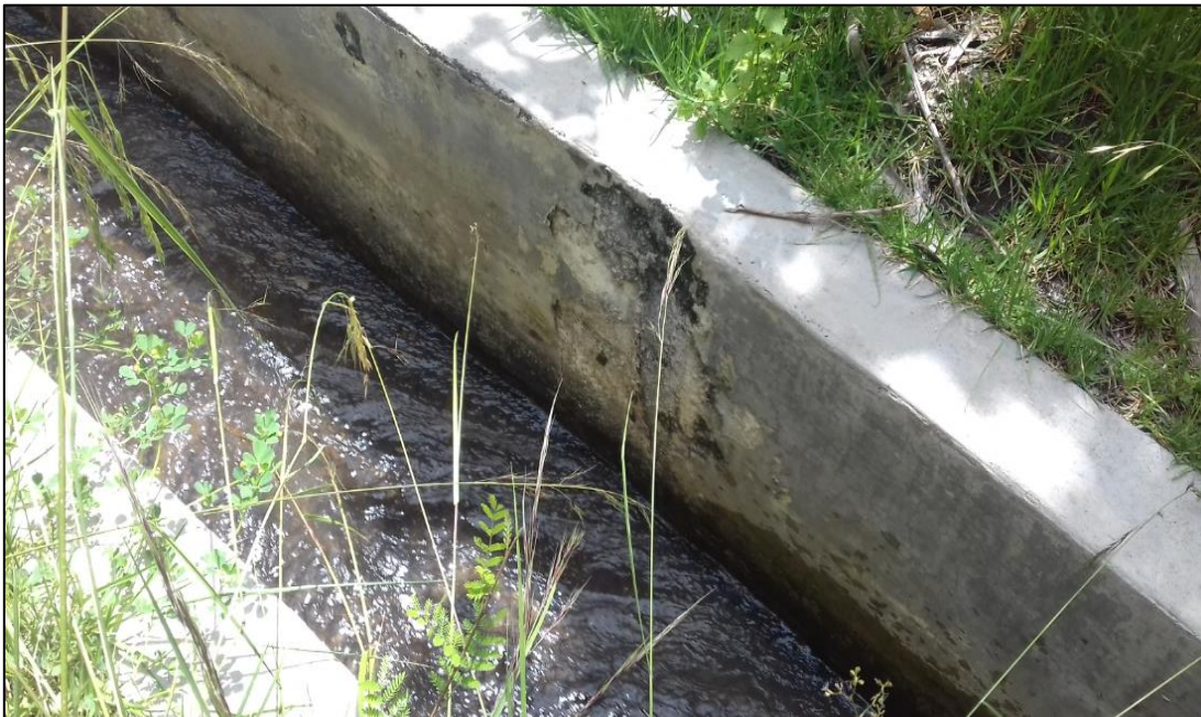
Imagen 14: Canal de riego Lucma, donde se aprecia presencia de euflorescencia
