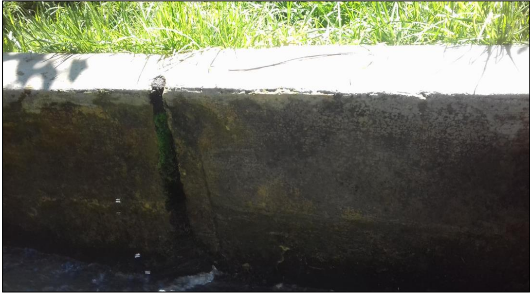
Imagen 11: canal de riego Lucma, donde se aprecia la patología de mohos.
