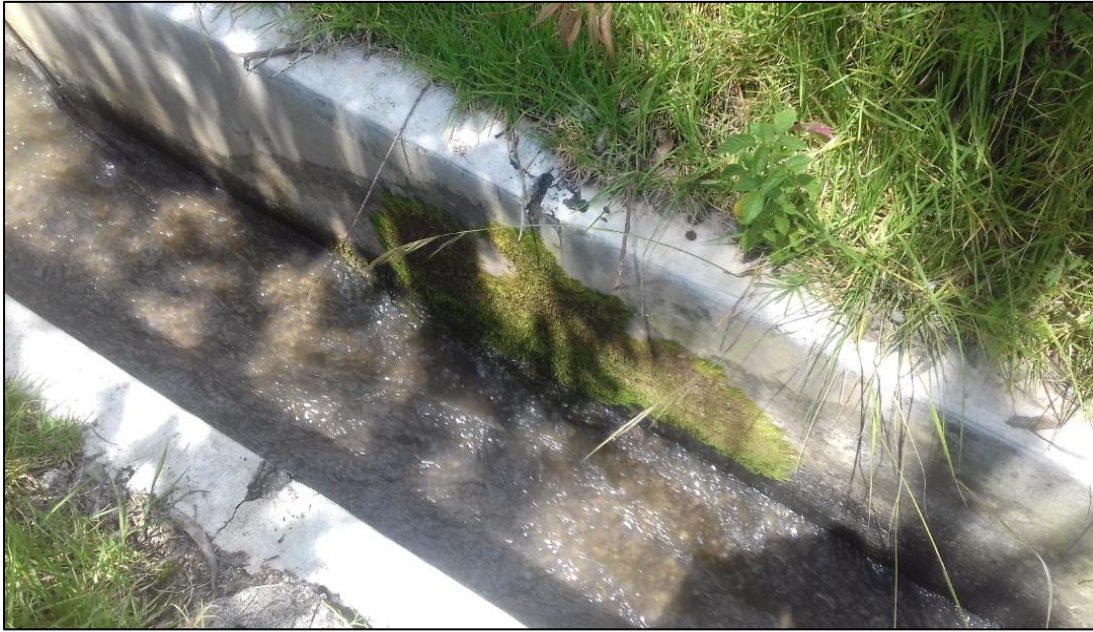
Imagen 13: Canal de riego Lucma, donde se aprecia presencia de musgos.
