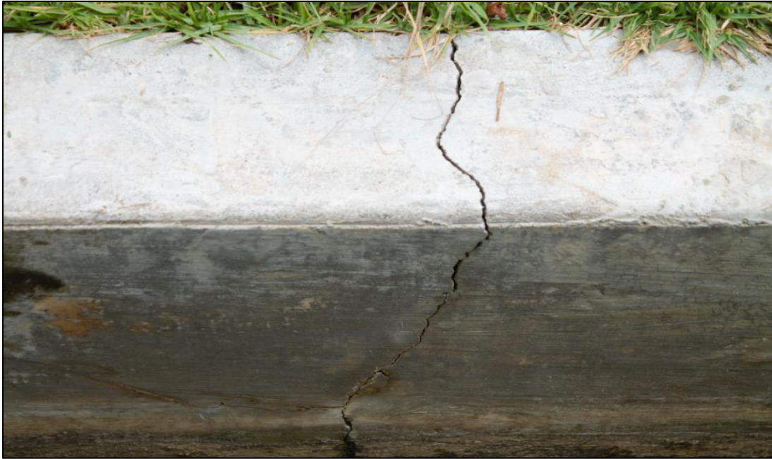
Imagen 15: Canal de riego Lucma, donde se aprecia presencia de grieta
