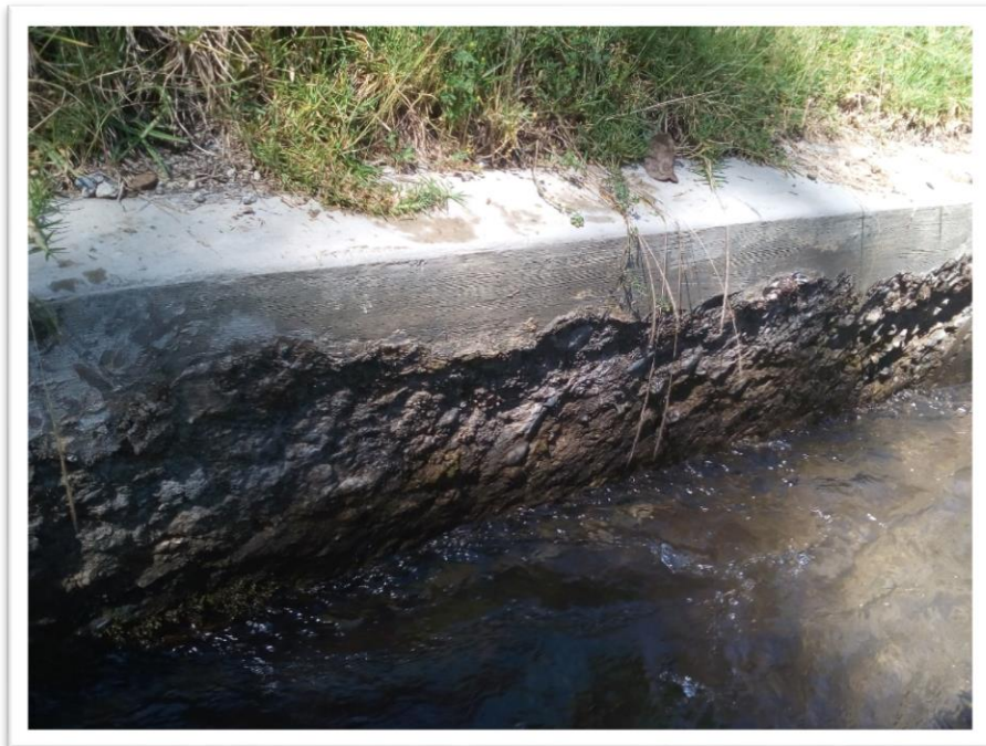
Fotografía 04. Se aprecia como la degradación va disminuyendo la sección del muro izquierdo del canal generando puntos débiles en la estructura.
