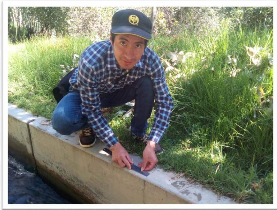
Fotografía 03. Realizando mediciones mediante una regla metálica la abertura de la grietas y fisuras.
