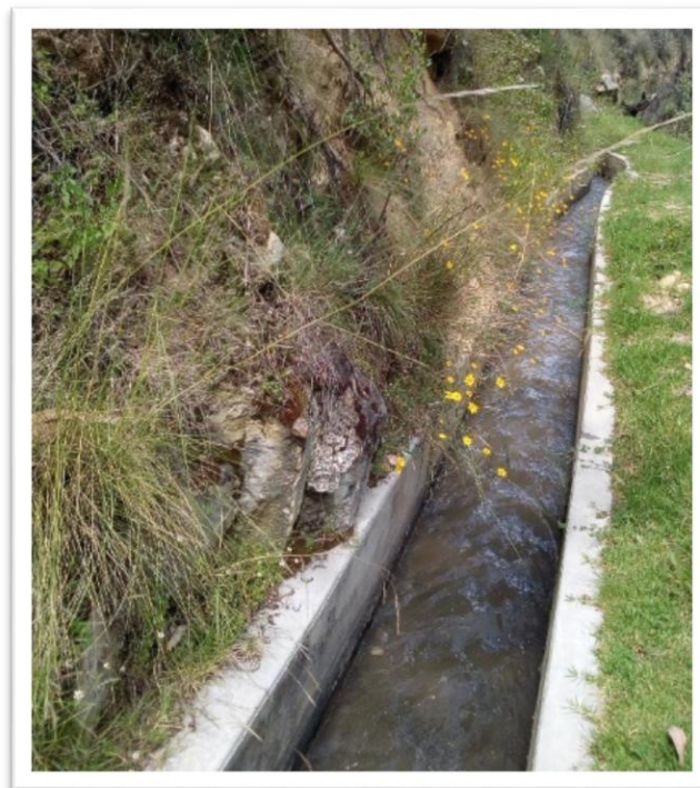
Fotografía 02. Se aprecia la excesiva cercanía del terreno contiguo que produce empuje al canal produciendo grietas debido a esfuerzos mecánicos.
