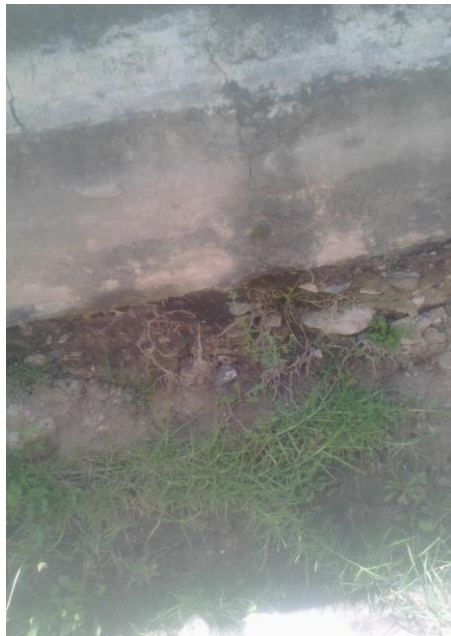
Imagen 13-Fisura en el canal
