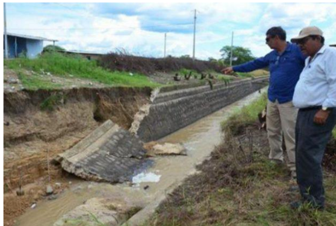
Imagen 11 – Erosión del canal
