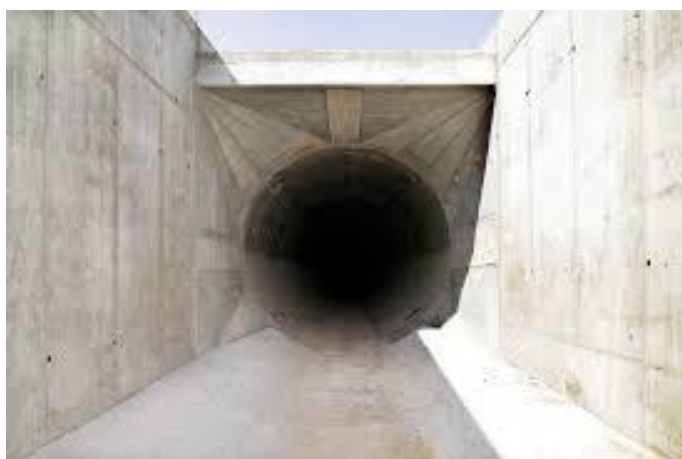
Imagen 07–Canal de sección circular
