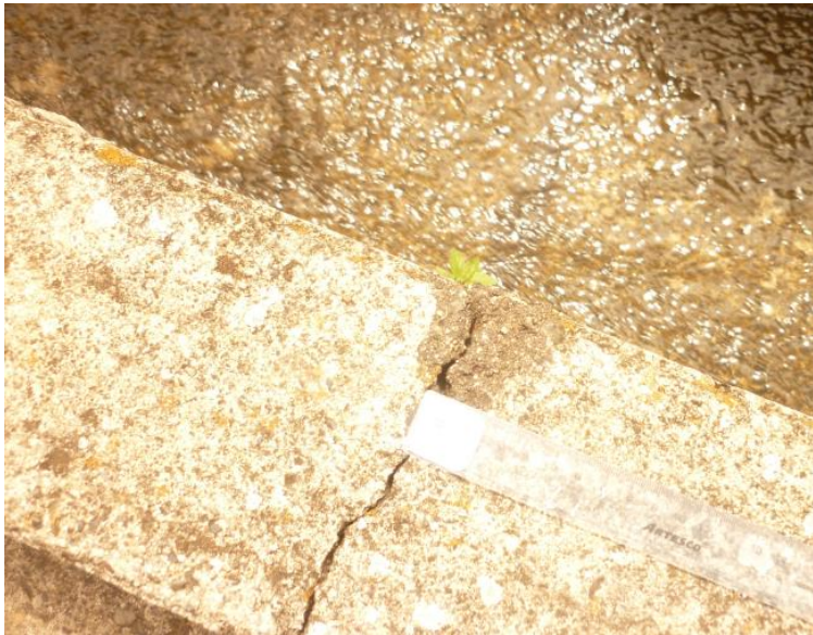
Imagen 09 – Grieta en canal
