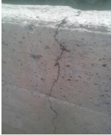
Imagen 12 – Agrietamiento del canal
