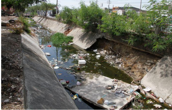
Imagen 08 –erosión del canal
