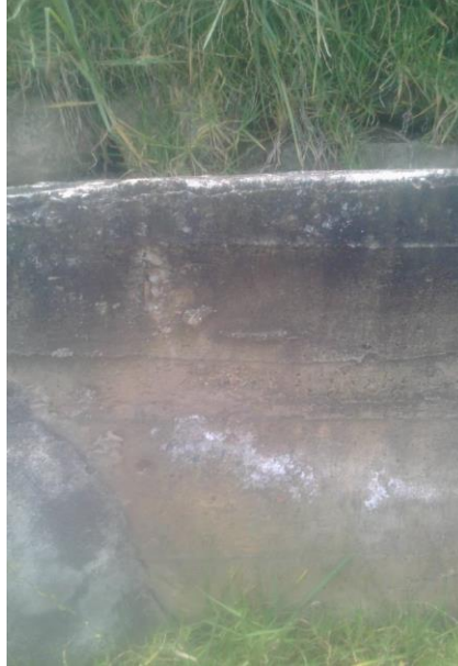
Imagen 10 – Eflorescencia en el canal
