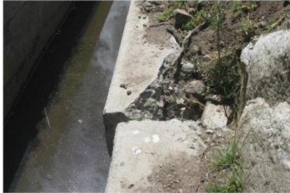
Figura 16: Daño por impacto.
