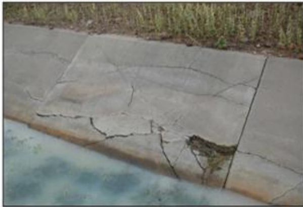
Figura 10: Fisuras como consecuencia de movimientos en el suelo de fundación.
