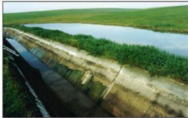
Figura 9: Fisuras en el revestimiento como consecuencia de la supresión.
