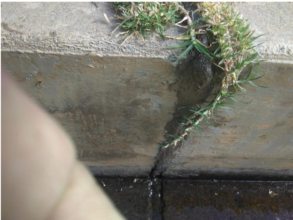
En esta fotografía se puede apreciar la patología crecimiento de vegetación en juntas con una severidad moderado.
