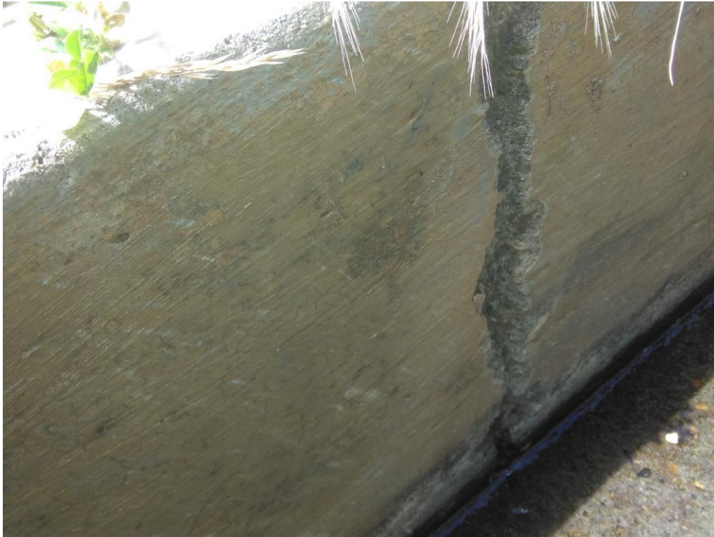
En esta fotografía se puede apreciar la patología de fisura con una severidad moderada.
