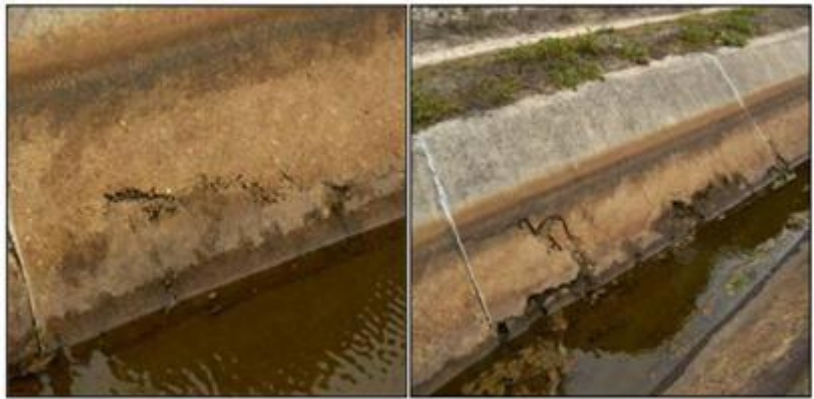
Figura 11: Degradación del revestimiento del concreto.
