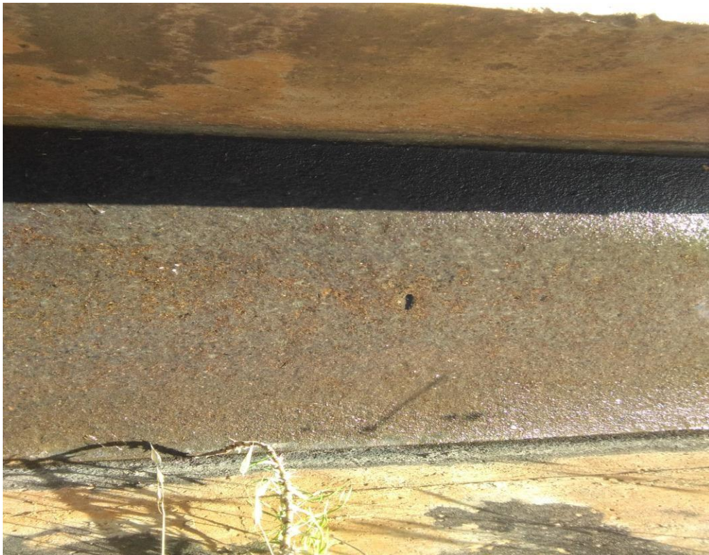
En esta fotografía se puede apreciar la patología de degradación del revestimiento del concreto con una severidad moderado.
