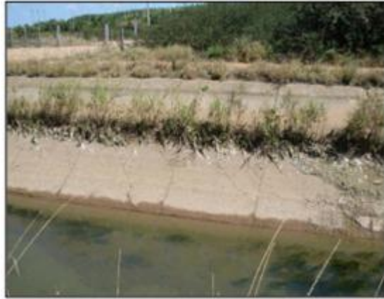
Figura 12: Crecimiento de vegetación en junta longitudinal.
