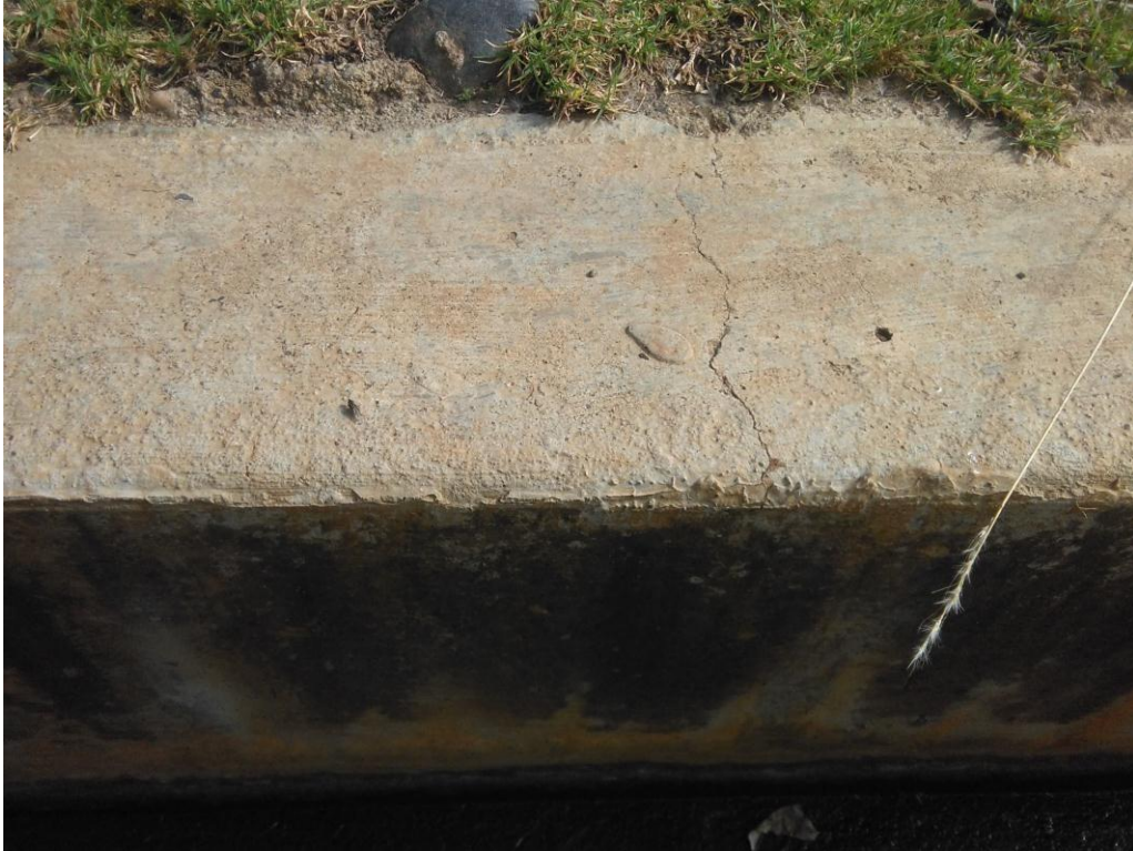
En esta fotografía se puede apreciar la patología de daño por impacto con una severidad leve.
