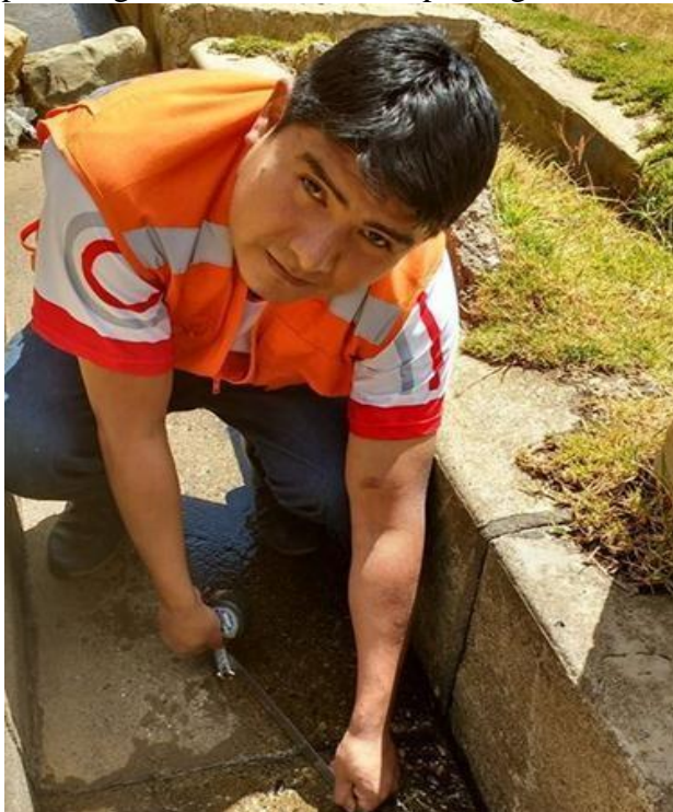
En esta imagen se puede apreciar el momento cuando se realiza la medida para luego hallar el área de la patología de hundimiento.
