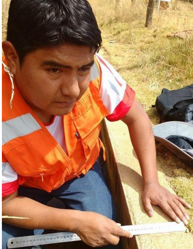
En esta imagen se puede apreciar el momento cuando se realiza la medida para luego hallar el área de la patología de fisuras.
