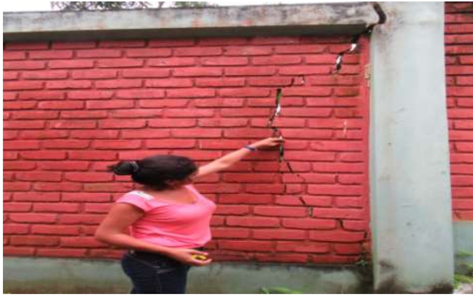
Gráfico 117: Grieta en sobrecimientos del cerco perimétrico. Fuente: Elaboración propia.
