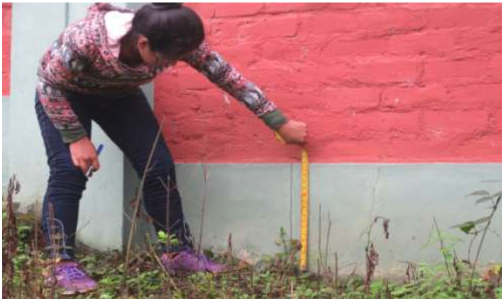
Gráfico 116: Fisura en sobrecimientos del cerco perimétrico. Fuente: Elaboración propia.
