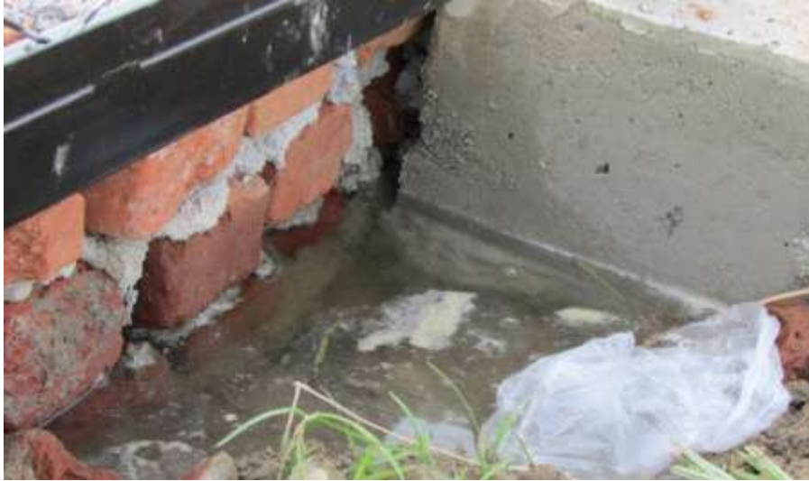
Gráfico 10: Filtración de agua en cercos perimetrales
