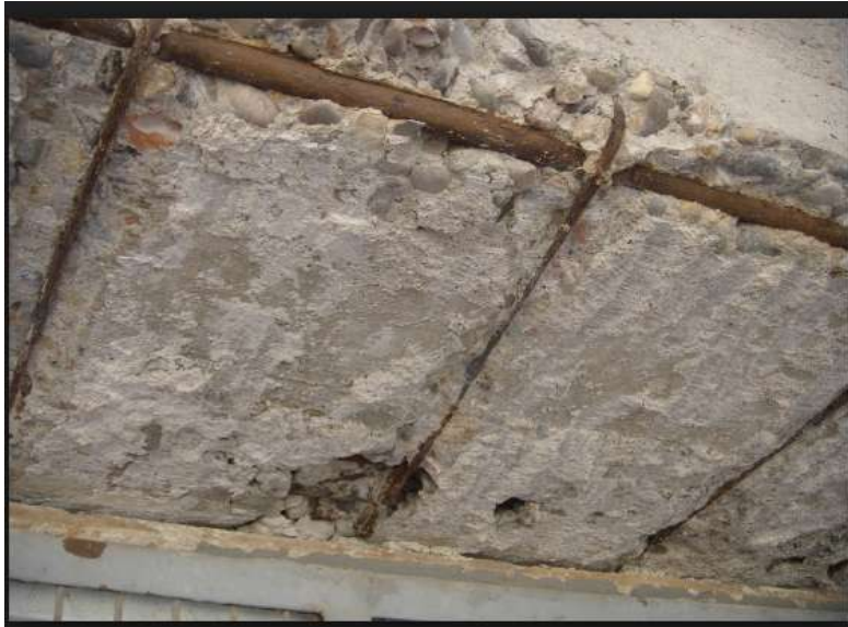
Gráfico 04: Corrosión de acero en vigas
