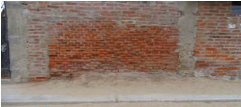
Gráfico09: Erosión en muros de albañilería
