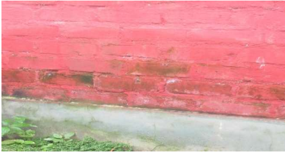
Gráfico 03: Humedad en muros y sobrecimiento.
