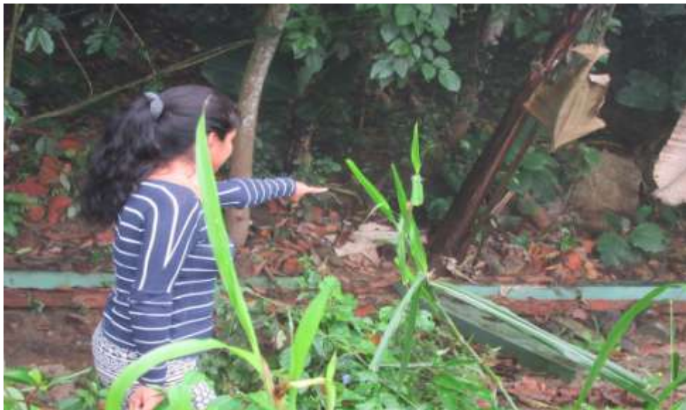
Gráfico 120: Secciones de muro colapsado del cerco perimétrico. Fuente: Elaboración propia.
