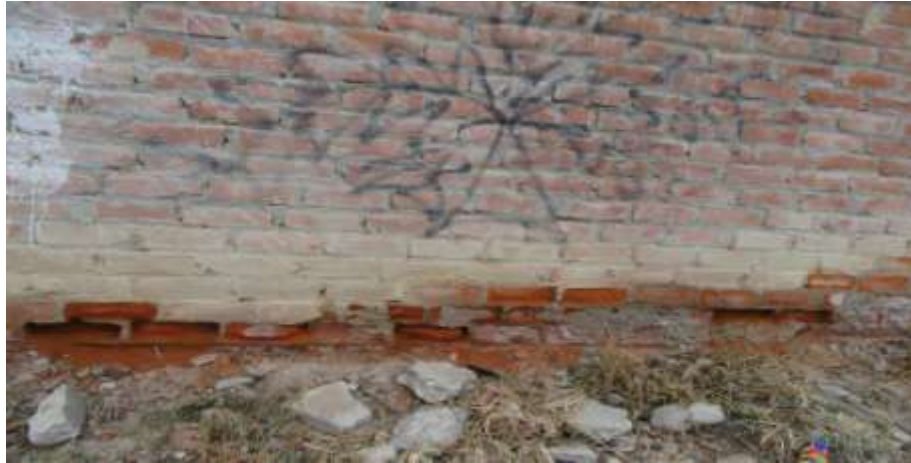
Gráfico 08: Desintegración en muros de albañilería
