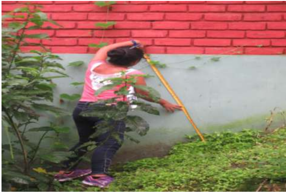
Gráfico 119: Fisuras en sobrecimientos del cerco perimétrico. Fuente: Elaboración propia.
