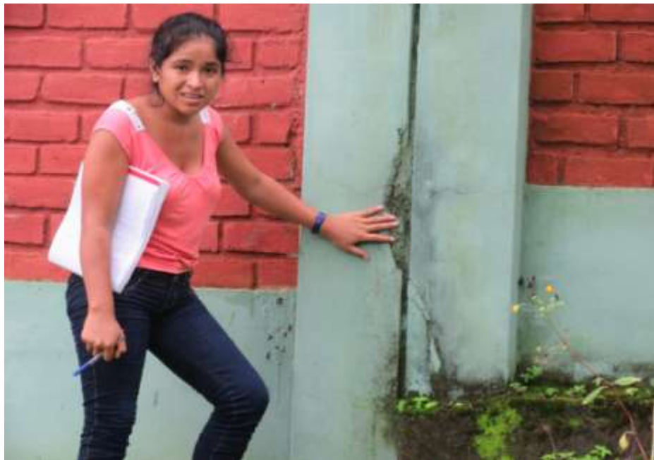
Gráfico 118: Grieta en columnas del cerco perimétrico. Fuente: Elaboración propia.
