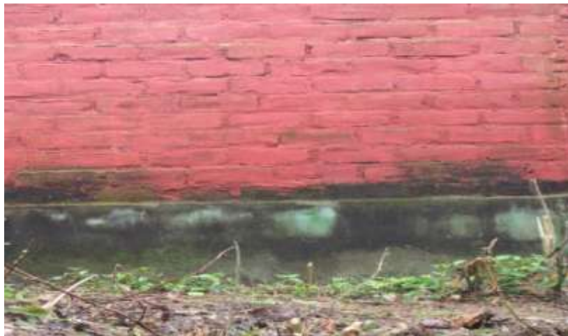
Gráfico 11: Moho en sobrecimientos y muros.
