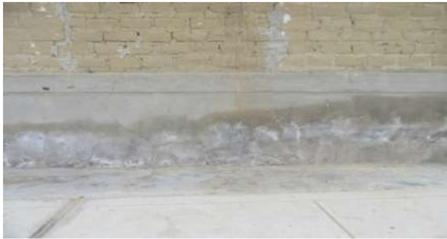
Gráfico 07: Eflorescencia en sobrecimiento
