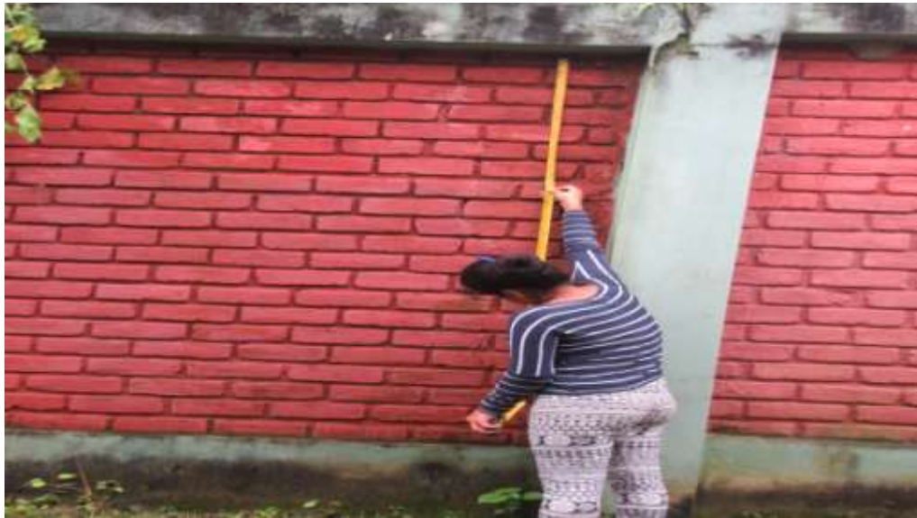
Gráfico 115: Fisura en muros del cerco perimétrico. Fuente: Elaboración propia.
