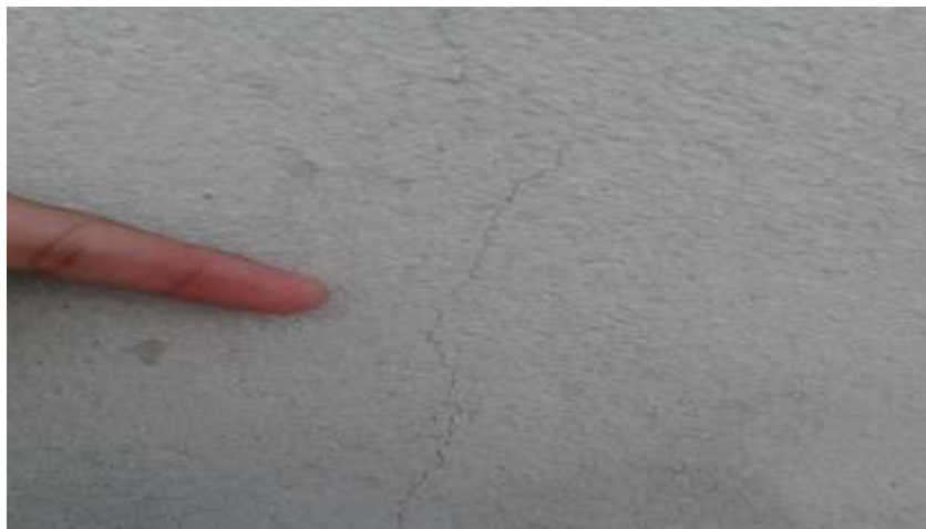
Gráfico 05: Fisura en columnas
