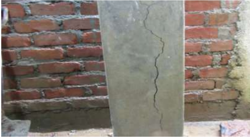
Gráfico 06: Grieta en columnas
