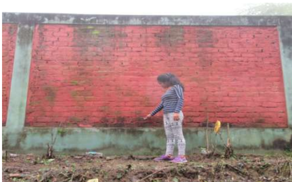
Gráfico 114: Humedad y moho en muros del cerco perimétrico. Fuente: Elaboración propia.
