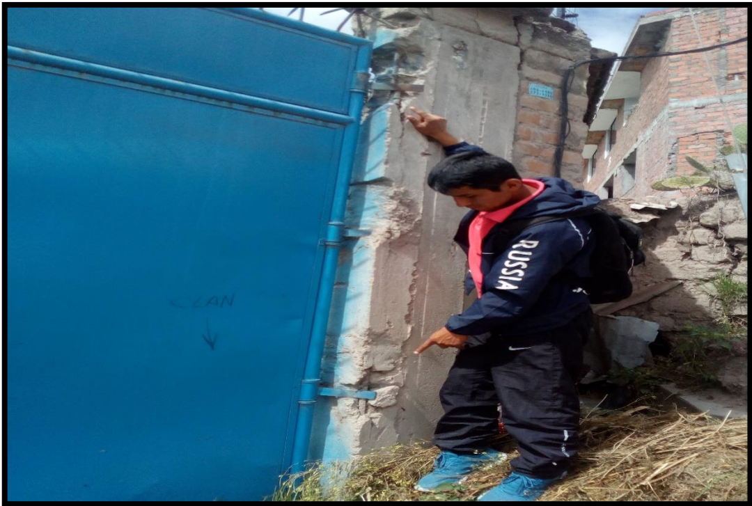
Fotografía 05: OXIDACIÓN en el acero de la columna del cerco perimétrico, en la unidad de muestra 07.
