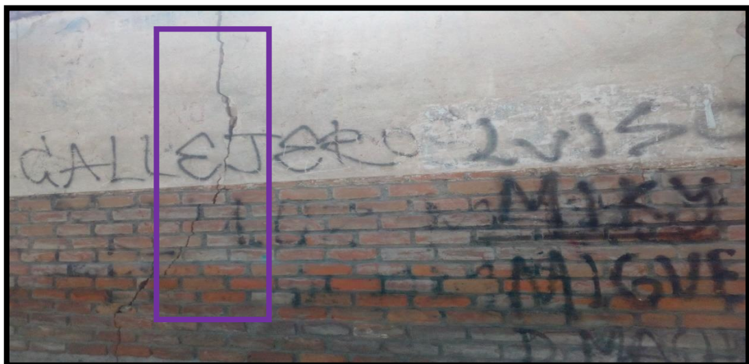
Fotografía 01: Grieta en muro, en la unidad de muestra 01.
