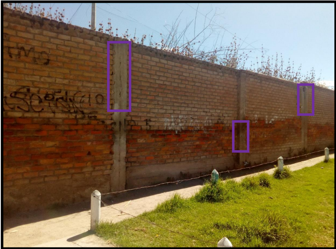
Fotografía 03: FISURA en columna del cerco perimétrico, en las unid. de muestra
