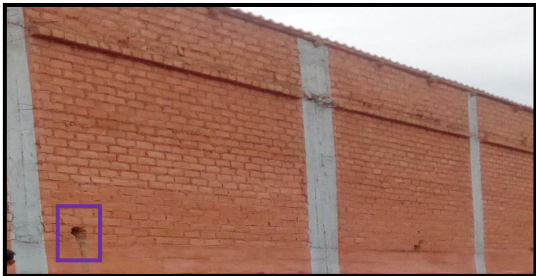
Fotografía 02: Picadura en muro, en la unidad de muestra 07.
