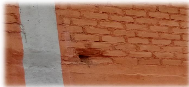
Figura 04: Picadura en muro
