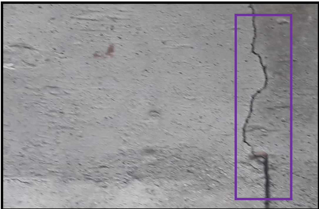
Fotografía 02: GRIETAS en columnas del cerco perimétrico, en las unidad de muestra 02.
