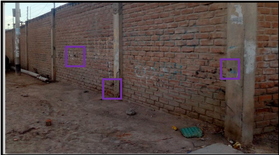
Fotografía 04: PICADURA en muro del cerco perimétrico, en las unid. de muestra.
