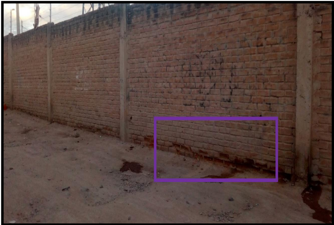
Fotografía 03: Erosión en muro, en la unidad de muestra 02.
