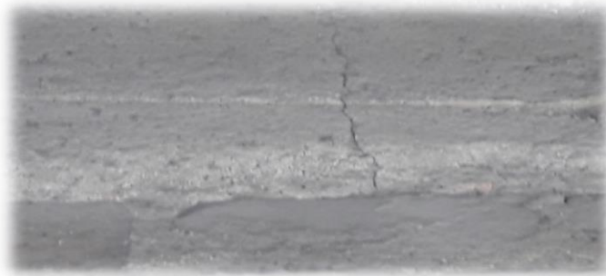
Figura 02. Fisuras en sobrecimiento
