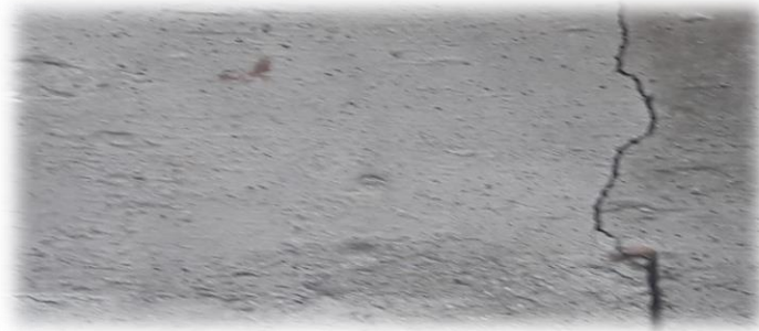
Figura 03. Grieta en muros
