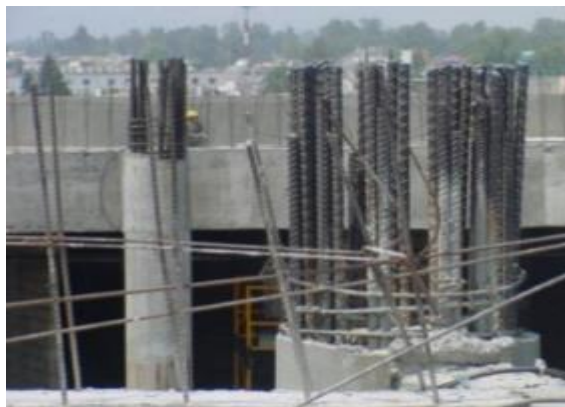
Figura 05: Oxidación en el acero de columna.
