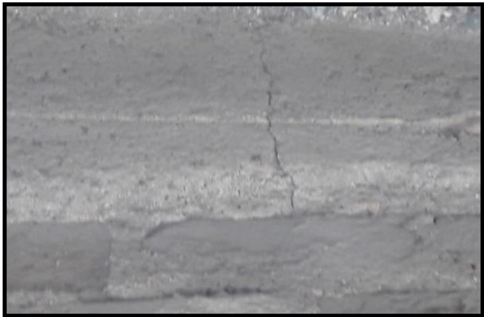
Fotografía 05: Fisura en tarrajeos, en la unidad de muestra 09.
