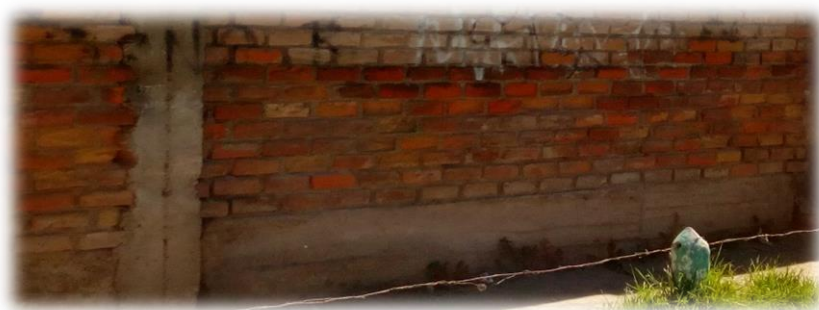
Figura 01: Erosión. Fuente: Elaboración propia (2017)
