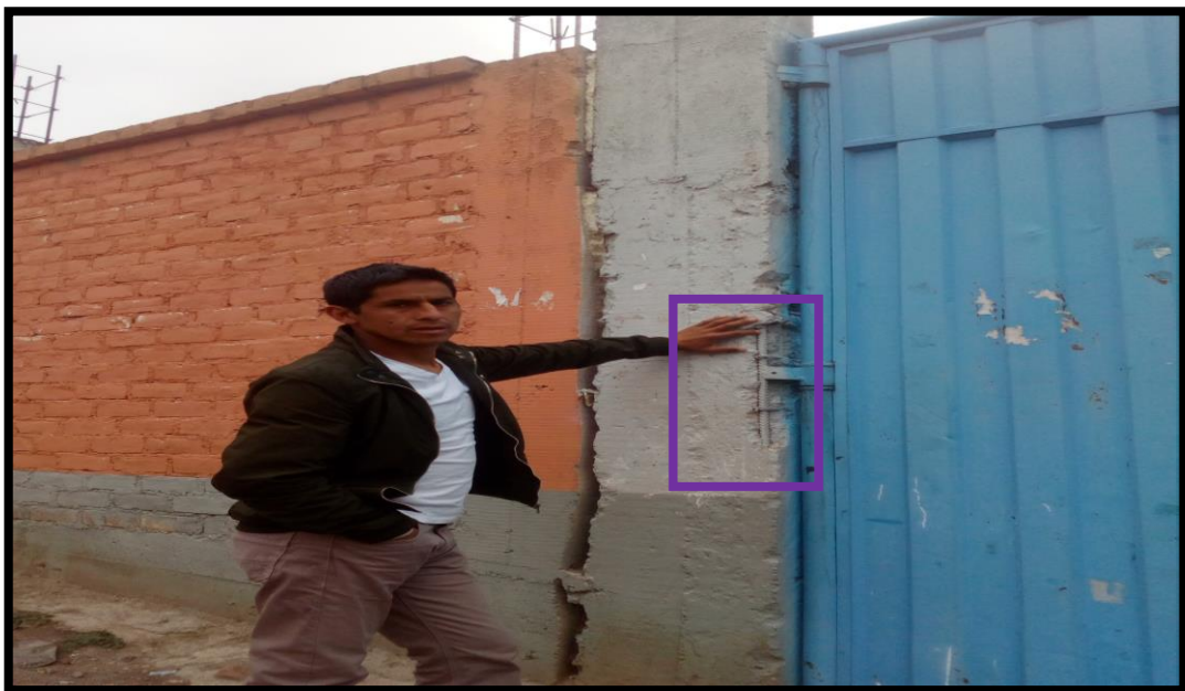
Fotografía 04: Oxidación, en la unidad de muestra 07.
