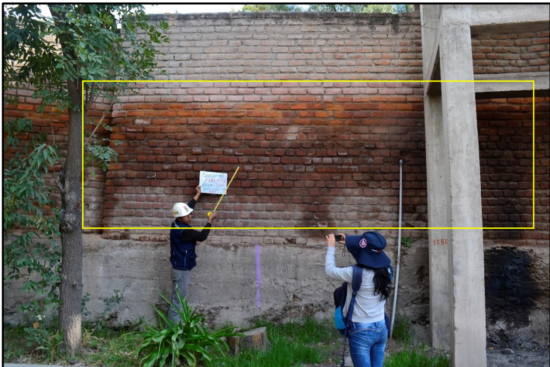
Fotografía 05: Eflorescencia del muro del cerco perimétrico del centro de salud de la Policía Nacional del Perú.
