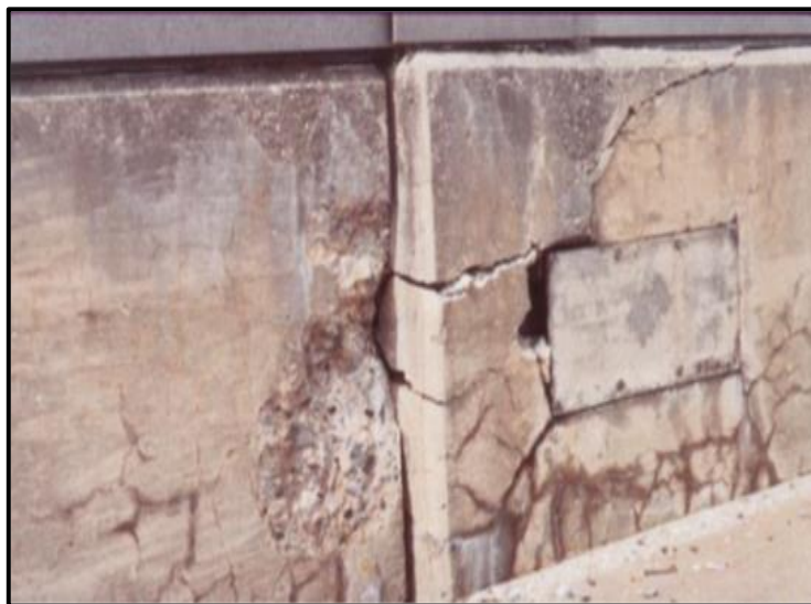
Imagen 23. Desprendimiento del concreto. Fuente: (Marza K 2016)
