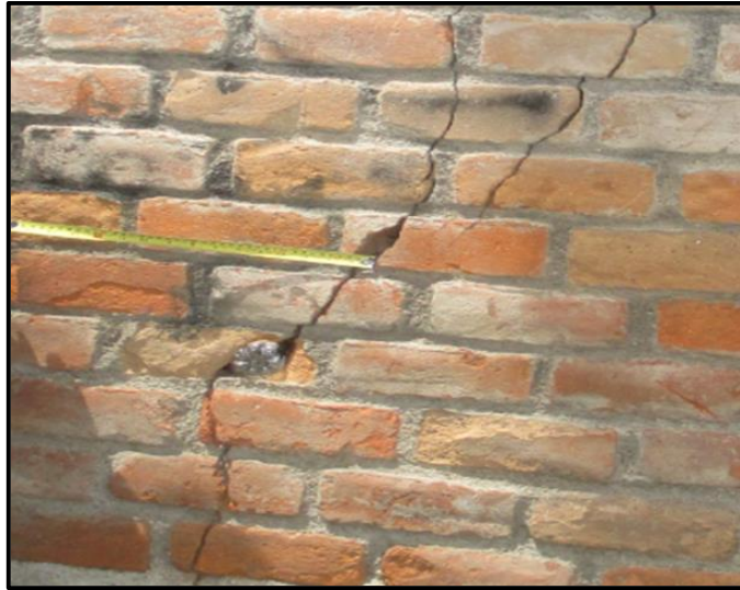
Imagen 21. Grieta en muro. Fuente: Elaboración propia (2018).
