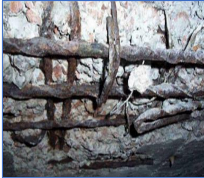
Imagen 22. Desprendimiento del concreto.
