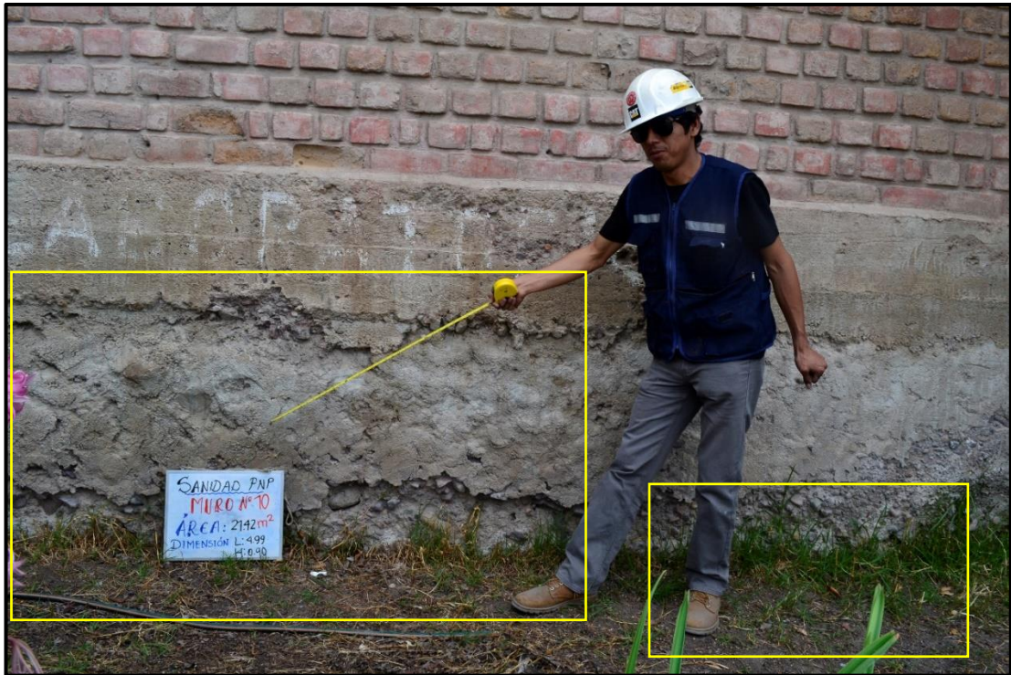
Fotografía 06: Desprendimiento del Sobrecimiento del cerco perimétrico del centro de salud de la Policía Nacional del Perú.
