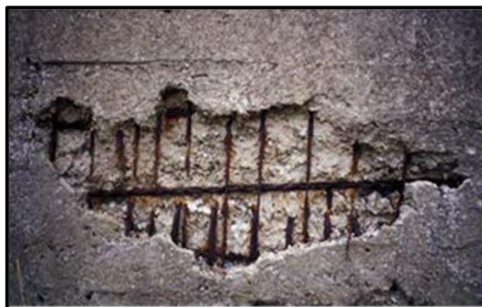
Imagen 24. Corrosión de acero. Fuente: (Stuardo K. 2008)
