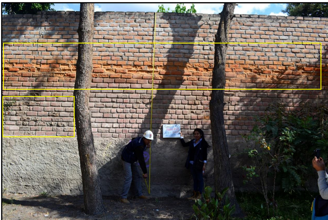
Fotografía 07: Erosión del muro del cerco perimétrico del centro de salud de la Policía Nacional del Perú.
