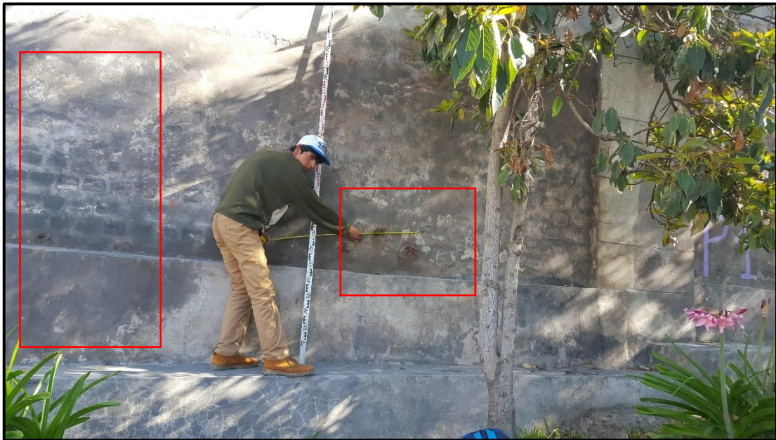
Fotografía 04: Desintegración del muro de la unidad muestral 03 del cerco perimétrico del centro de salud de la policía nacional del Perú.
