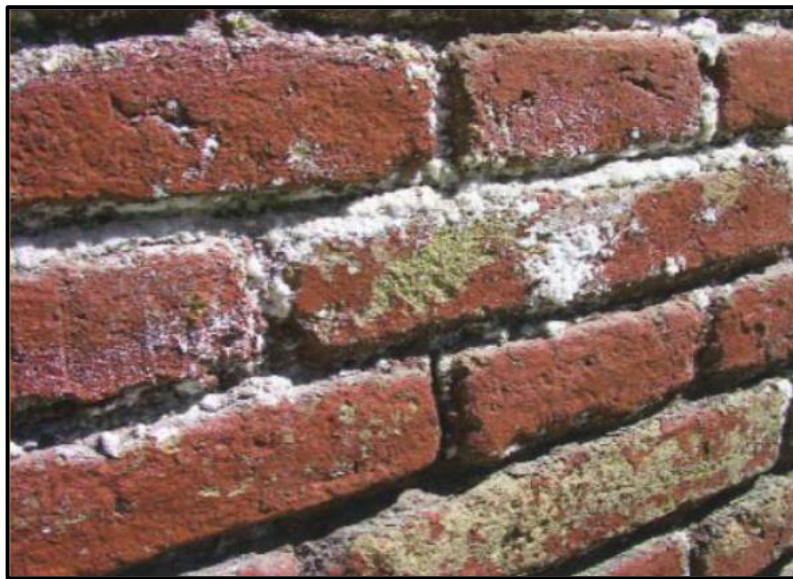
Imagen 25. Eflorescencia del muro.
