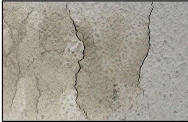
Imagen 19. Fisura en muro.
