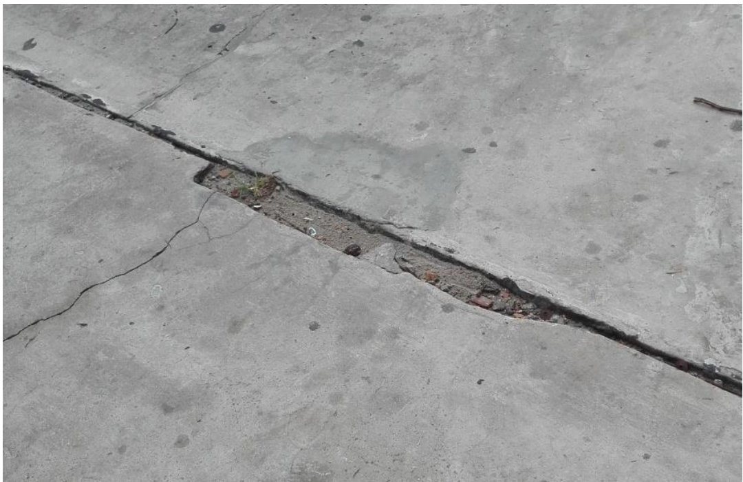
Figura N° 39: notésé el pavimento con la patología que presenta grietas lineales.
