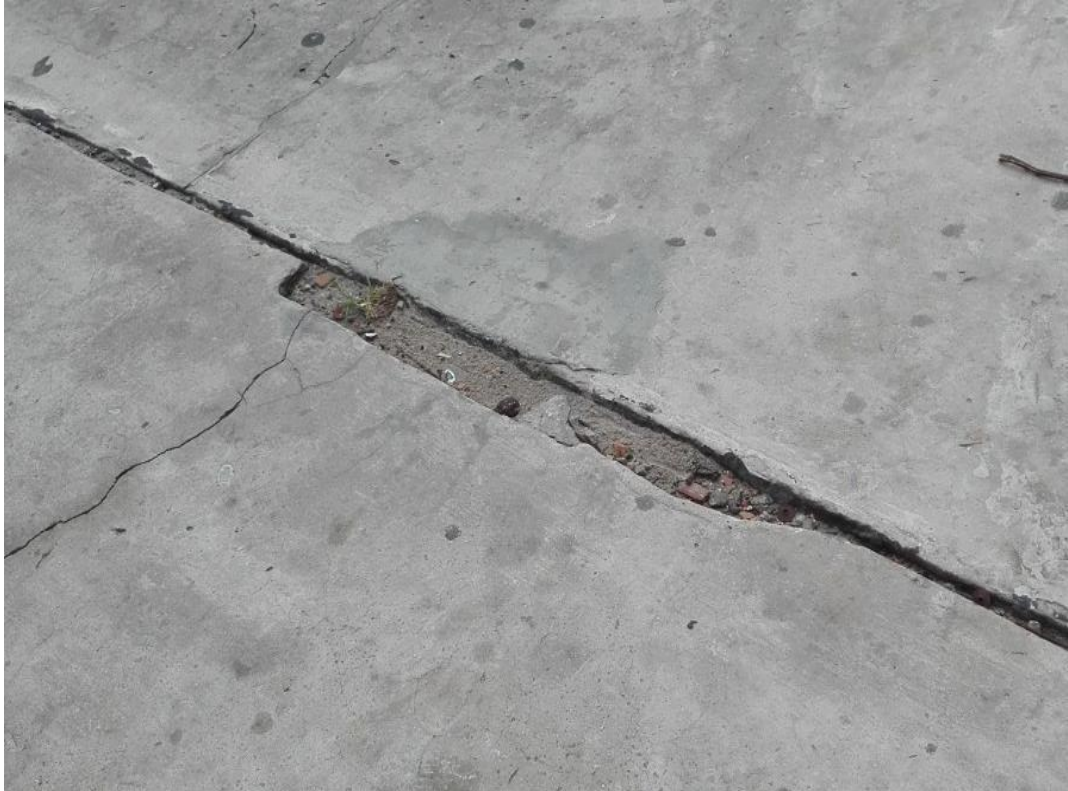
Descascaramiento. De junta
