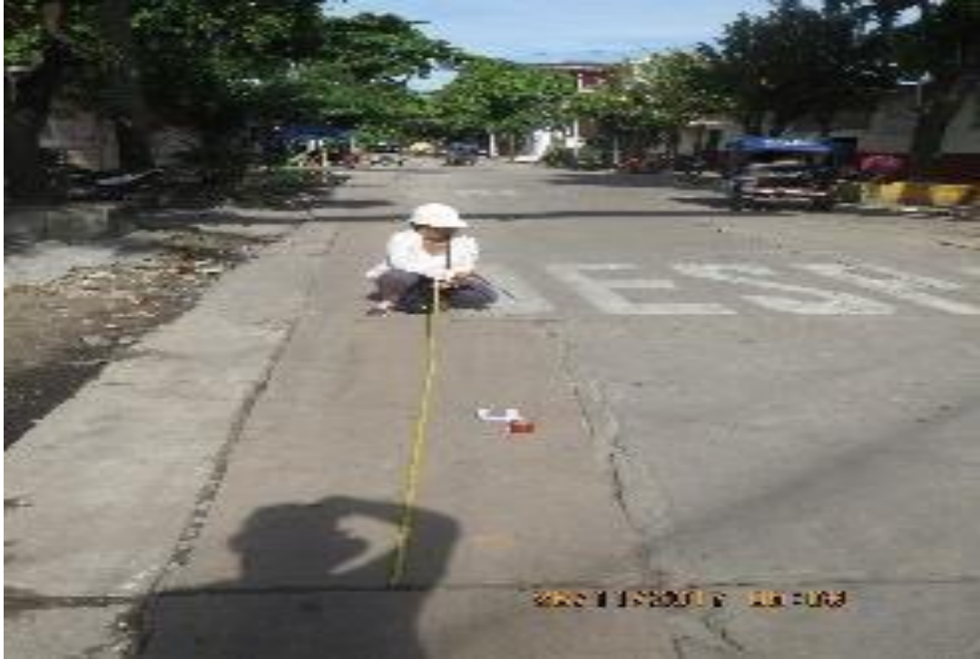
Figura N° 38: notésé el pavimento con la patología que presenta grietas lineales.
