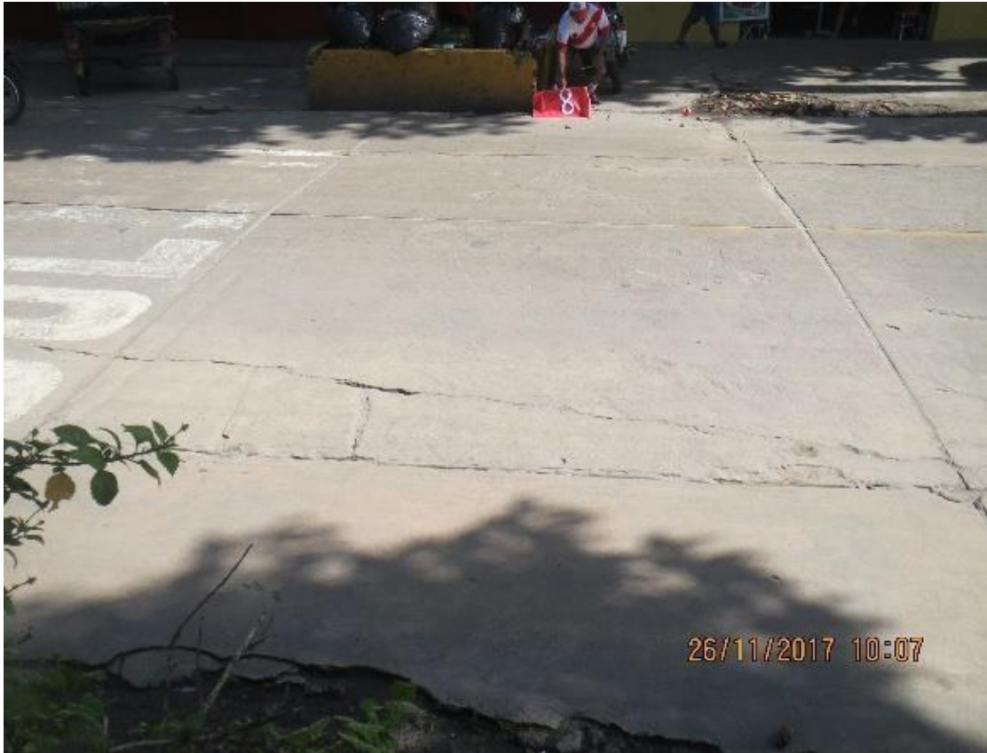
Figura N° 37: notese el pavimento con la patologia que presenta grietas lineales.
