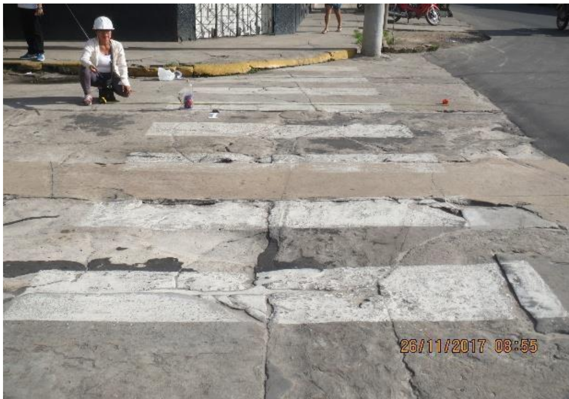
Figura N° 40: notese el pavimento con la patologia que presenta grietas desconchamiento.
