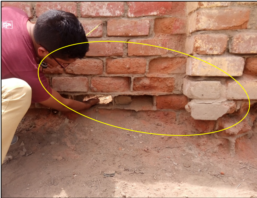
Fotografía 8: Muro de albañilería atacada de manera severa por la erosión (físico-química) en la zona inferior del cerco perimétrico de la UM-13.
