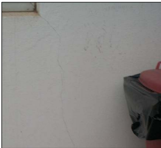
Figura 11. Fisura en muro de albañilería de edificio. Nota. Fuente: Caroca H. (2012).
