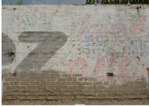
Figura 16. Erosión química en muro de albañilería. Nota. Fuente: Juárez W. (2017).
