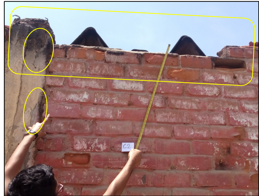
Fotografía 15: Área afectada por las erosiones, grietas y corrosión en la zona superior provocando después su desprendimiento del concreto en el muro albañilería confinada del cerco perimétrico de la UM-10.
