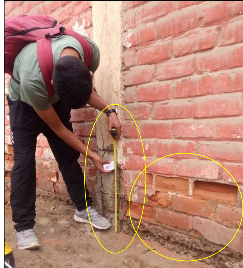
Fotografía 13: Área afectada por corrosión y erosión (físico-química) en zona baja provocando luego su desprendimiento del concreto en la estructura de albañilería confinada del cerco perimétrico de la UM-8.
