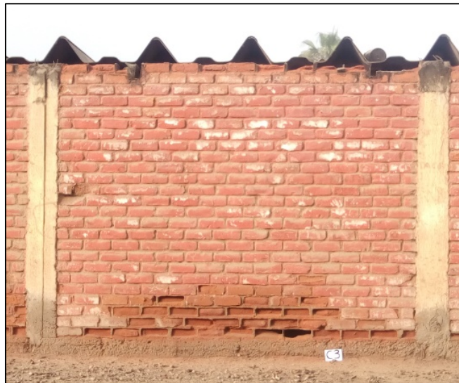
Figura 9. Erosión física en muro de albañilería. Nota. Fuente: Elaboración propia (2018).
