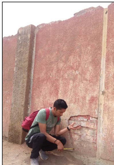
Figura 10. Desprendimiento en muro de albañilería. Nota. Fuente: Elaboración propia (2018).
