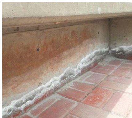
Figura 14. Estructura de concreto con presencia de eflorescencia. Nota. Fuente: Juárez W. (2017).
