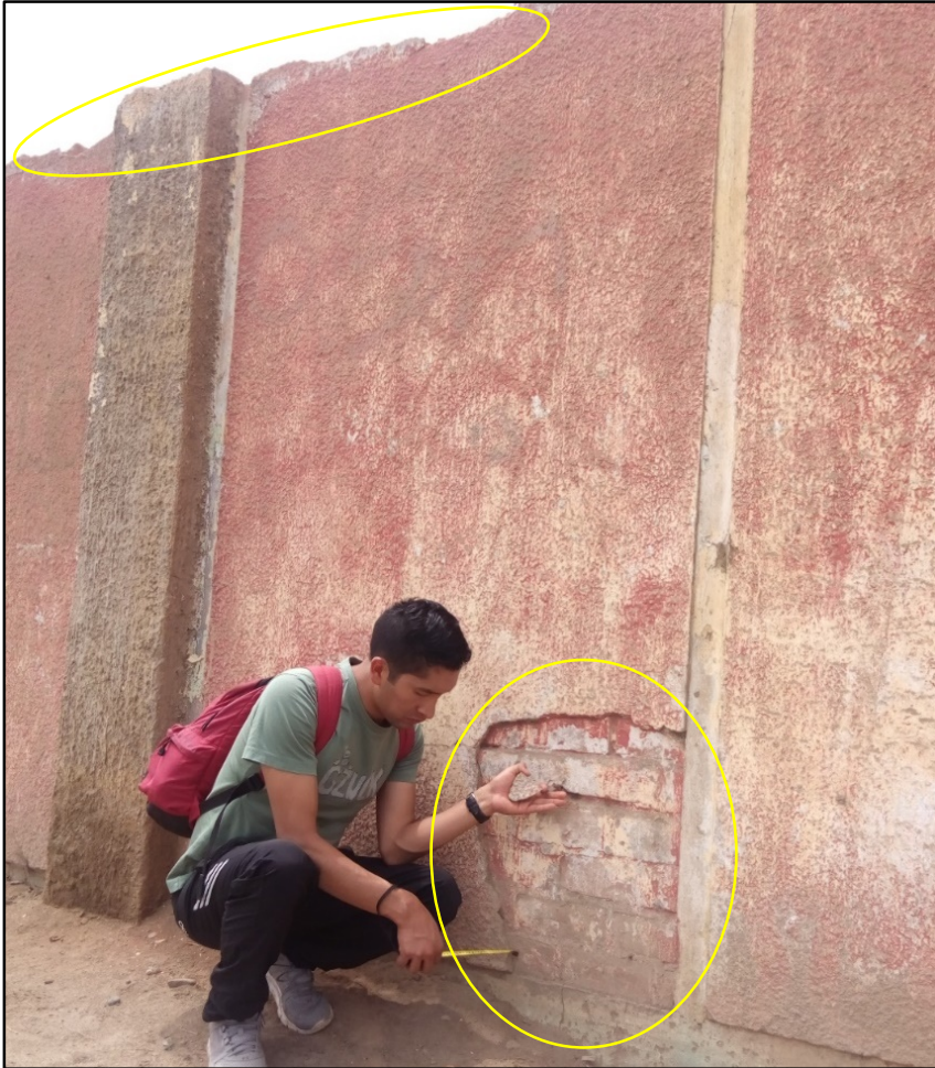
Fotografía 12: Área afectada por desprendimiento en la zona baja y alta en la estructura de albañilería simple del cerco perimétrico de la UM-23.
