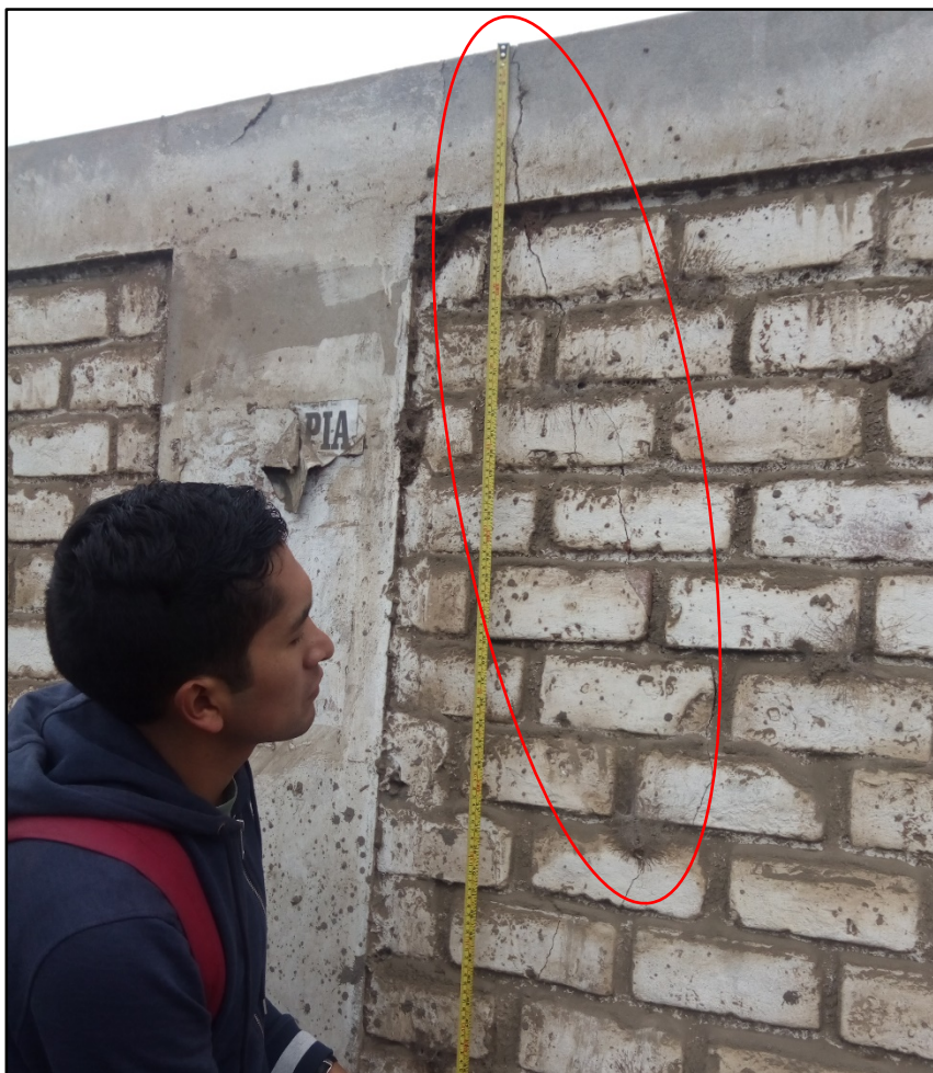
Fotografía 10: Muro de albañilería y viga afectada por las grietas en la zona superior en el muro albañilería confinada del cerco perimétrico de la UM-24.
