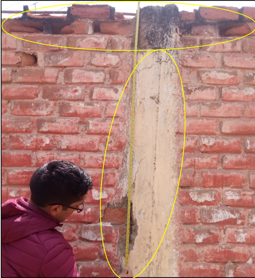
Fotografía 14: Área afectada por las erosiones, grietas y corrosión en la zona superior provocando después su desprendimiento del concreto en el muro albañilería confinada del cerco perimétrico de la UM-7.
