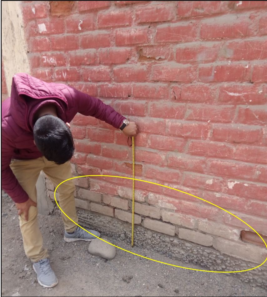
Fotografía 6: Medición del área afectada por erosión (físico-química) en la estructura de albañilería confinada (muro de albañilería y sobrecimiento) del cerco perimétrico de la UM-6.
