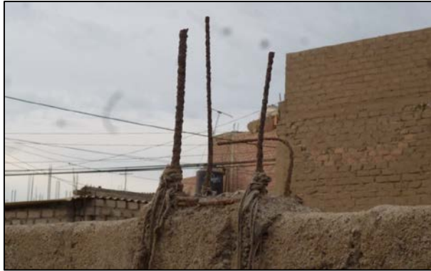
Figura 15. Oxidación y corrosión afectada severamente a la columna. Nota. Fuente: Juárez W. (2017).
