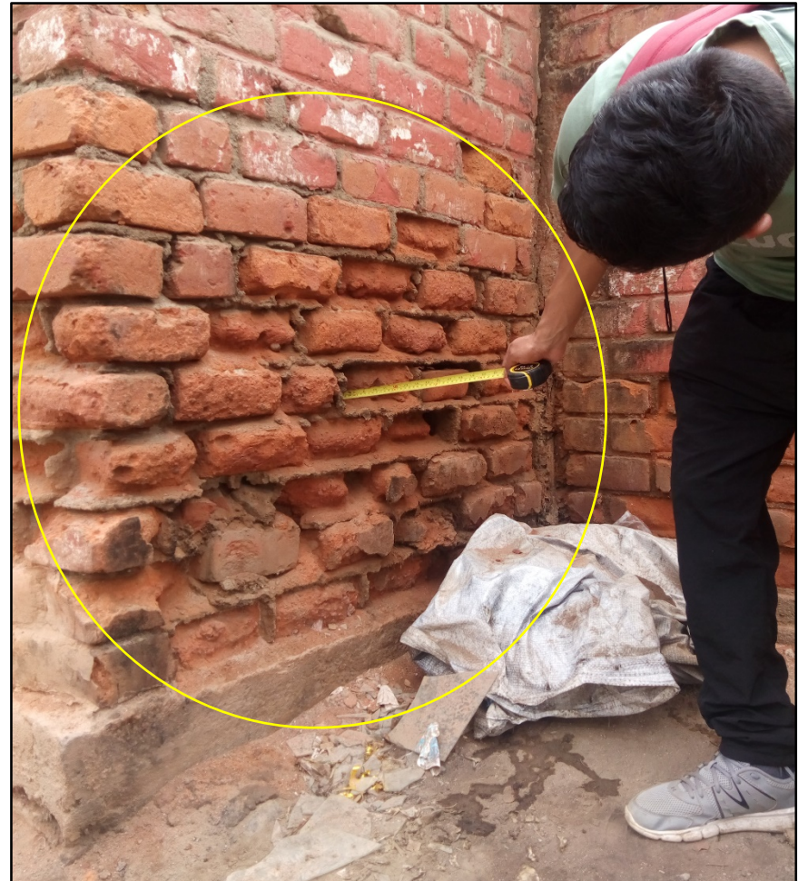
Fotografía 9: Muro de albañilería y sobrecimiento atacada de manera severa por la erosión (físico-química) en la zona inferior del cerco perimétrico de la UM-12.
