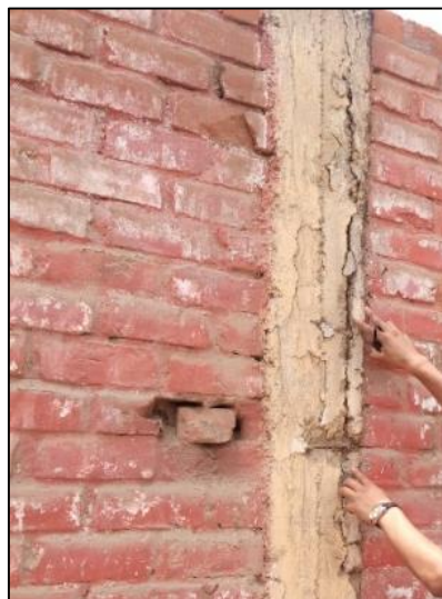
Figura 12. Grieta en columna severamente afectada. Nota. Fuente: Elaboración propia (2018).
