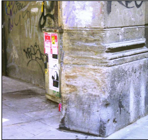
Figura 13. Erosión mecánica por roce permanente de peatones y vehículos. Nota. Fuente: Broto (2006).
