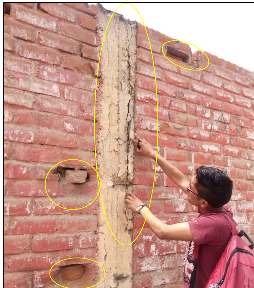
Fotografía 11: Área afectada por las grietas y erosiones en la zona superior provocando después su desprendiendo del concreto en el muro albañilería confinada del cerco perimétrico de la UM-10.
