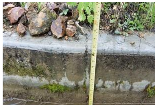
Fotografía 9: Grieta – UM-24, Margen izquierdo.
