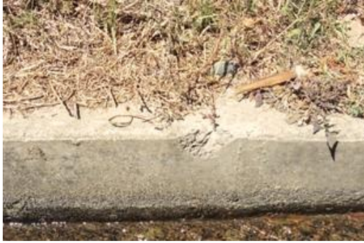
Fotografía 18: Impacto – UM-18, Margen izquierdo.
