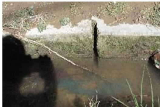
Fotografía 15: Daño al sello de junta – UM- 22, Margen derecho.
