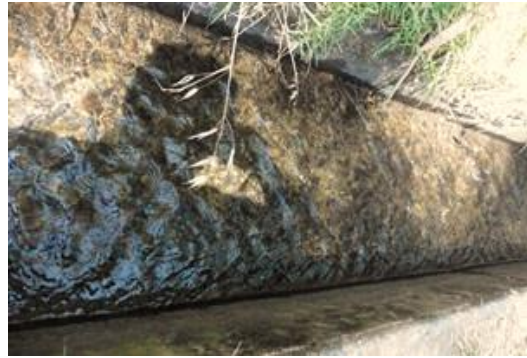
Fotografía 13: Erosión – UM-13, Fondo.
