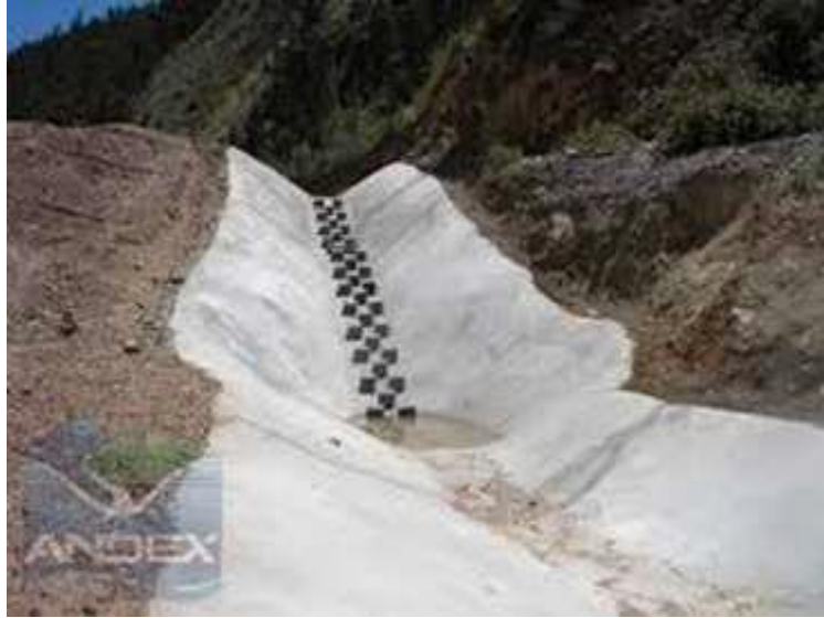
Imagen 06: Canal revestido con mortero.
