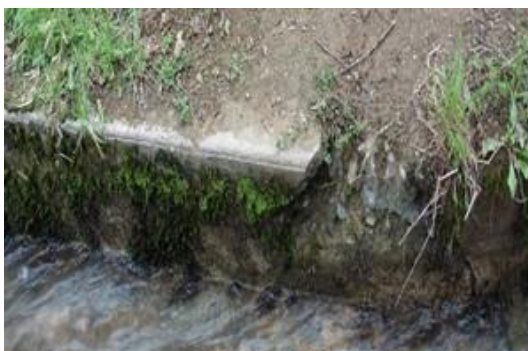
Fotografía 10: Desprendimiento – UM-18, Margen izquierdo.
