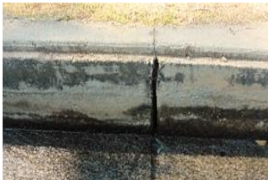
Fotografía 14: Daño al sello de junta – UM-21, Margen derecho.
