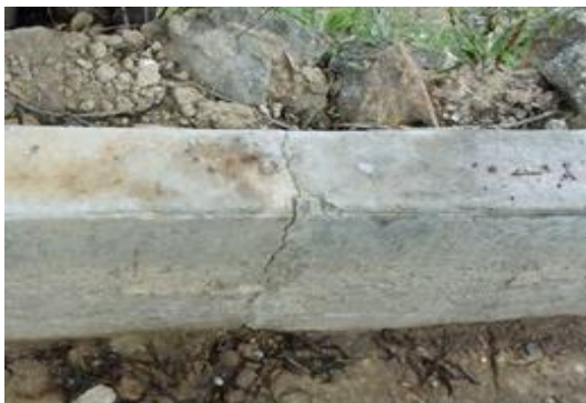
Fotografía 8: Grieta – UM-09, Margen izquierdo.
