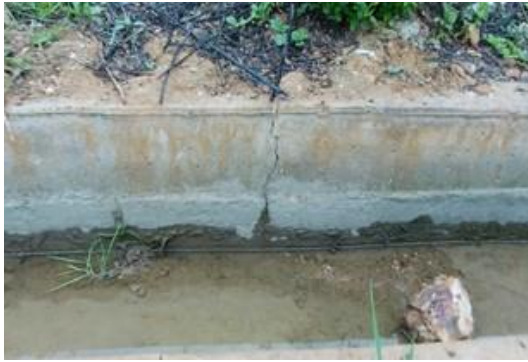
Fotografía 6: Fisura – UM-11, Margen izquierdo.
