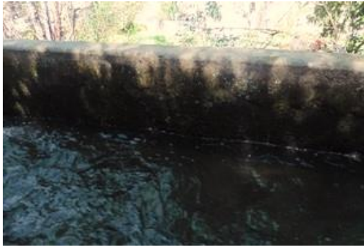
Fotografía 12: Erosión – UM-04, Margen derecha.
