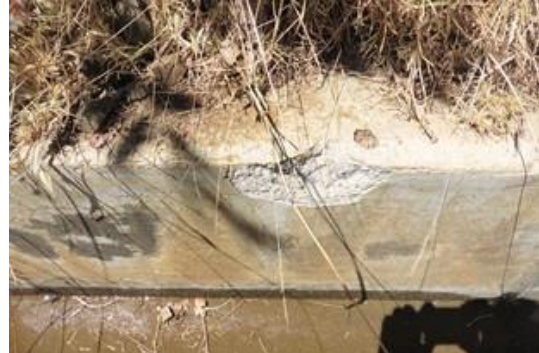
Fotografía 19: Impacto – UM- 16, Margen derecho.
