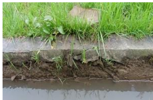
Fotografía 11: Desprendimiento – UM-11, Margen derecho.
