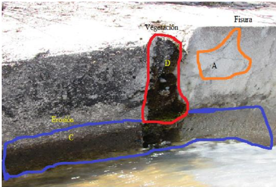
Figura 119: Identificación de patologías fisuras, erosión y vegetación margen
