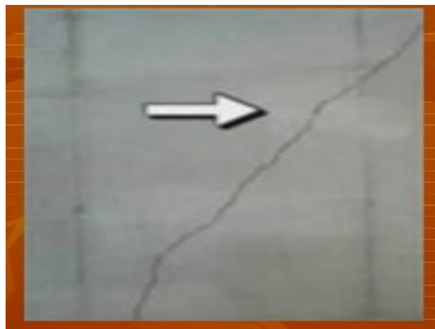
Figura 6: Evidencias de fallas estructurales.
