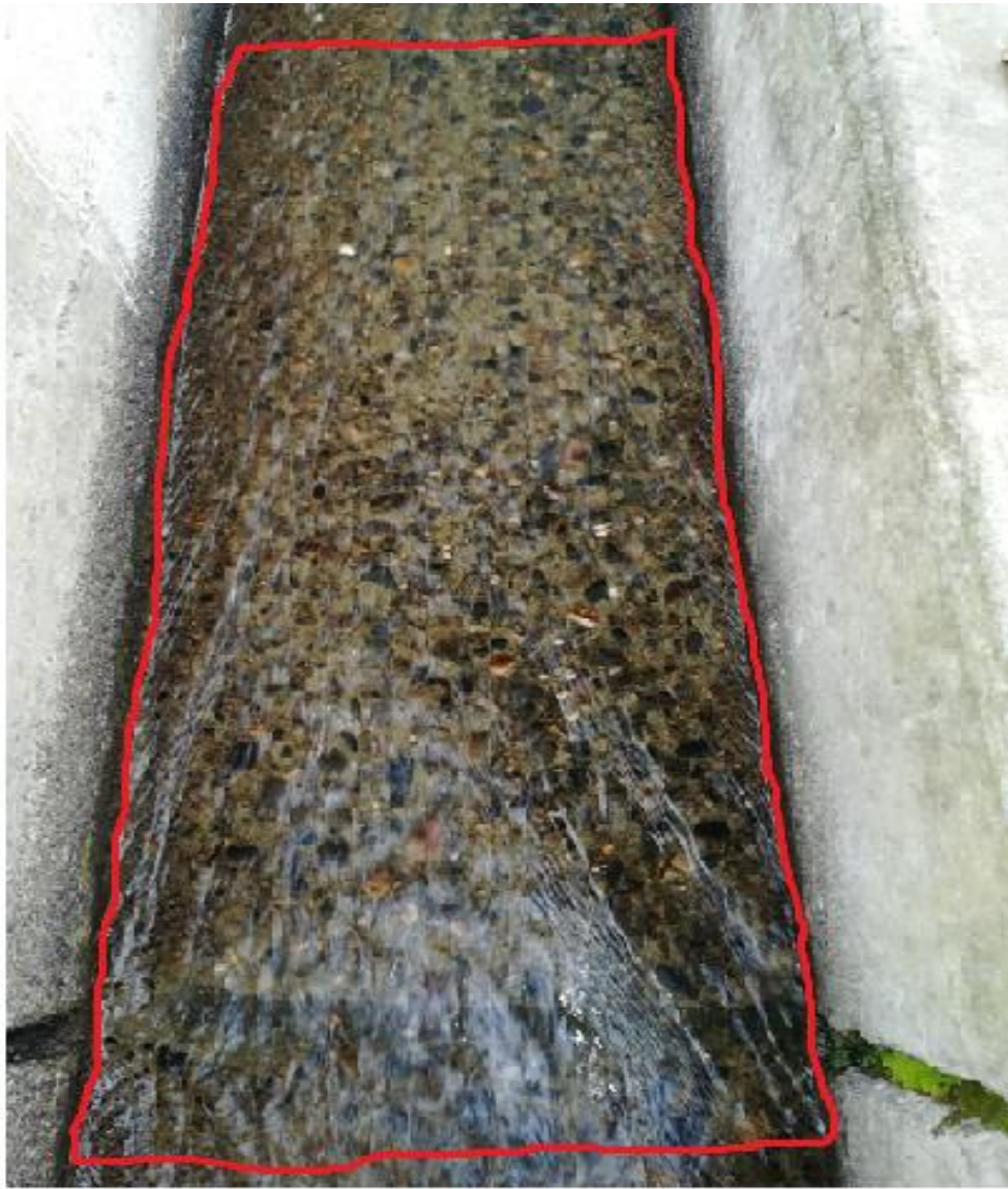
Figura 127: Identificación de patología erosión en el fondo del canal.
