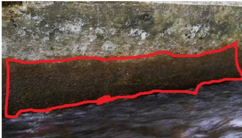
Figura 7: Identificación de erosión en el canal.
