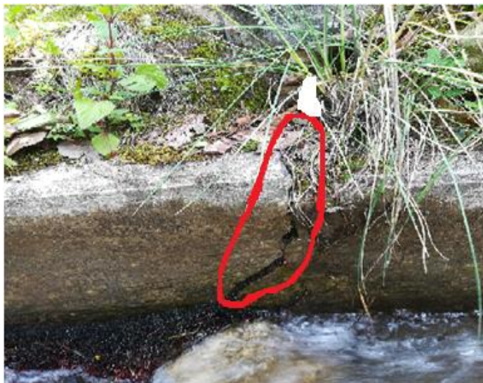
Figura 8: Identificación de la grieta en el canal.
