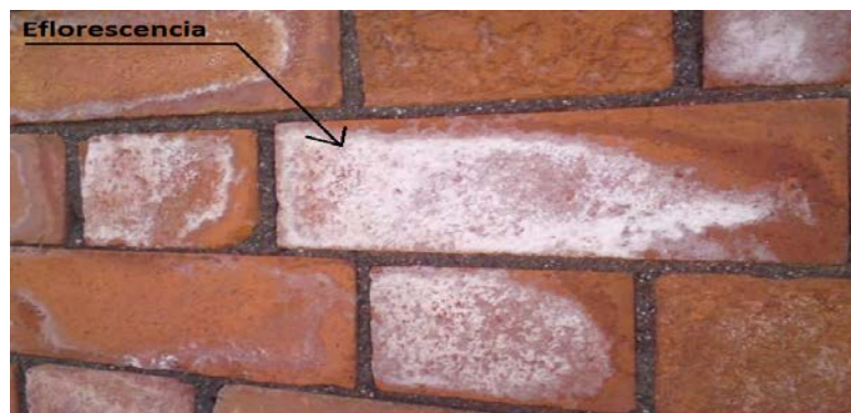
Figura 20. Eflorescencia en unidades de albañilería.
