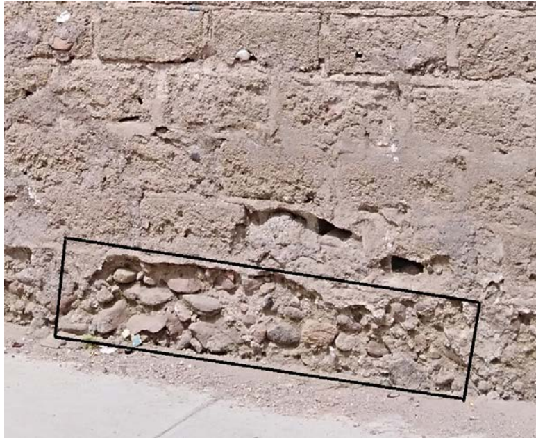
Fotografía 18: Presencia de erosión en sobrecimiento – Muestra 10.
