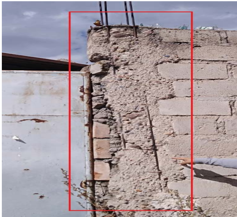
Fotografía 17: Oxidacion de acero de refuerzo en columna de Muestra 15.
