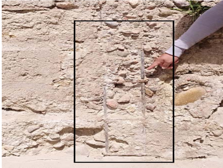
Fotografía 15: Oxidación de acero de refuerzo en columna de Muestra 12.
