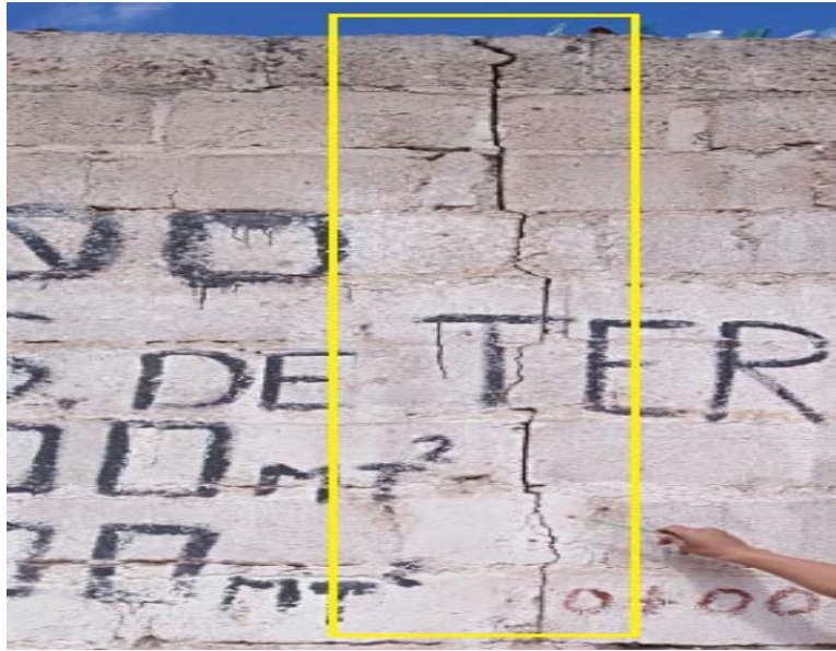
Fotografía 08: Presencia de grieta vertical en muro de albañilería del cerco perimetrico – Muestra 13.
