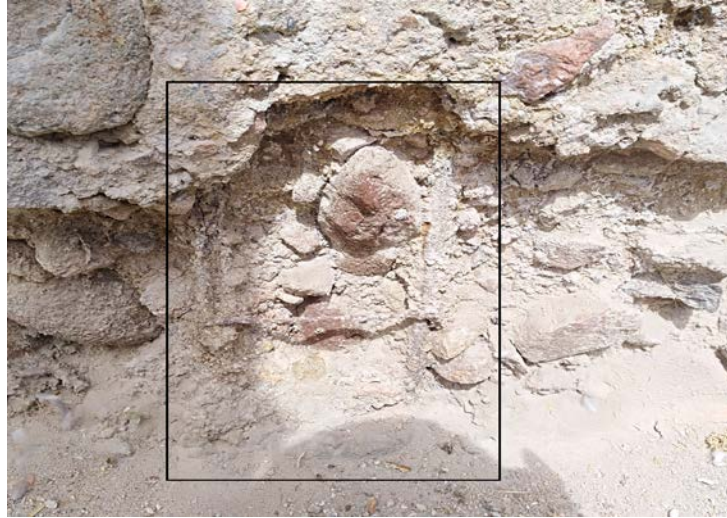
Fotografía 16: Oxidacion de acero de refuerzo en columna de Muestra 13.
