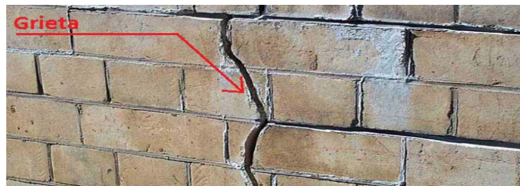
Figura 17. Grieta en muro de albañilería.
