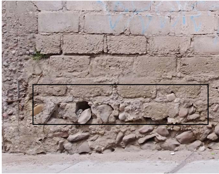
Fotografía 20: Presencia de erosion en muro de albañileria confinada del cerco perimetrico – Muestra 12.
