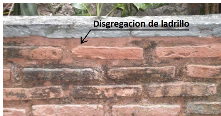
Figura 18. Disgregacion de unidades de albañilería.
