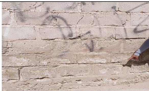
Foto 04: Eflorescencia en muro de albañilería confinada.
