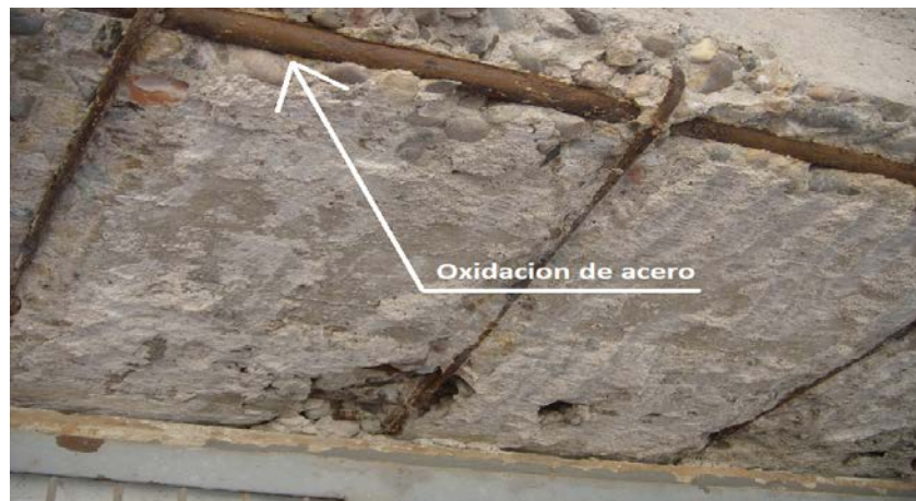
Figura 21. Oxidación de acero de viga.
