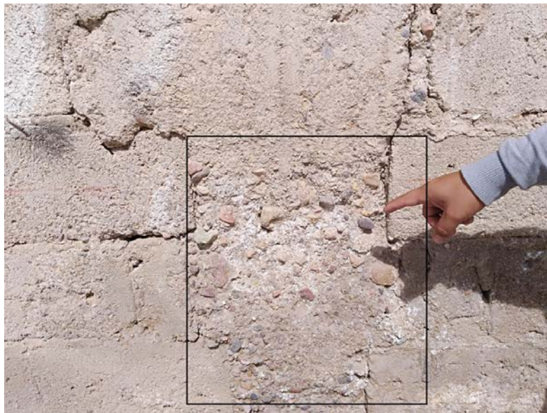
Fotografía 13: Presencia de eflorescencia en columna – Muestra 07.
