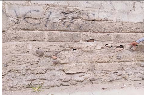
Foto 02: Erosión de sobrecimientos y muro de albañilería confinada.
