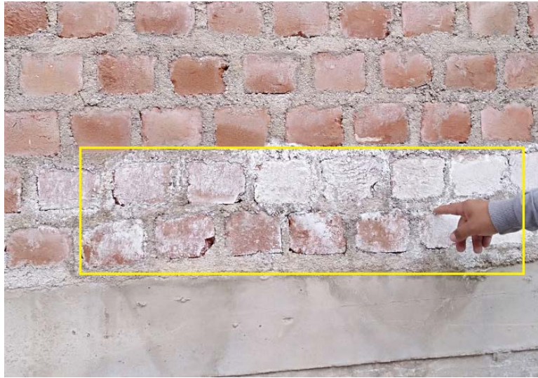
Fotografía 12: Presencia de eflorescencia en muro de albañilería confinada del cerco perimetrico – Muestra 02.
