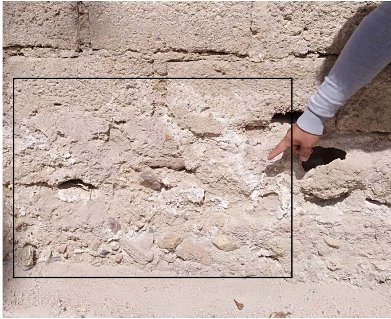
Fotografía 14: Presencia de eflorescencia en sobrecimiento – Muestra 10.
