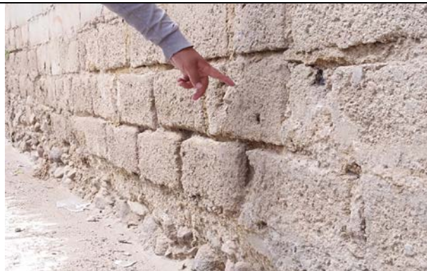
Foto 03: Picadura de muro de albañilería confinada.
