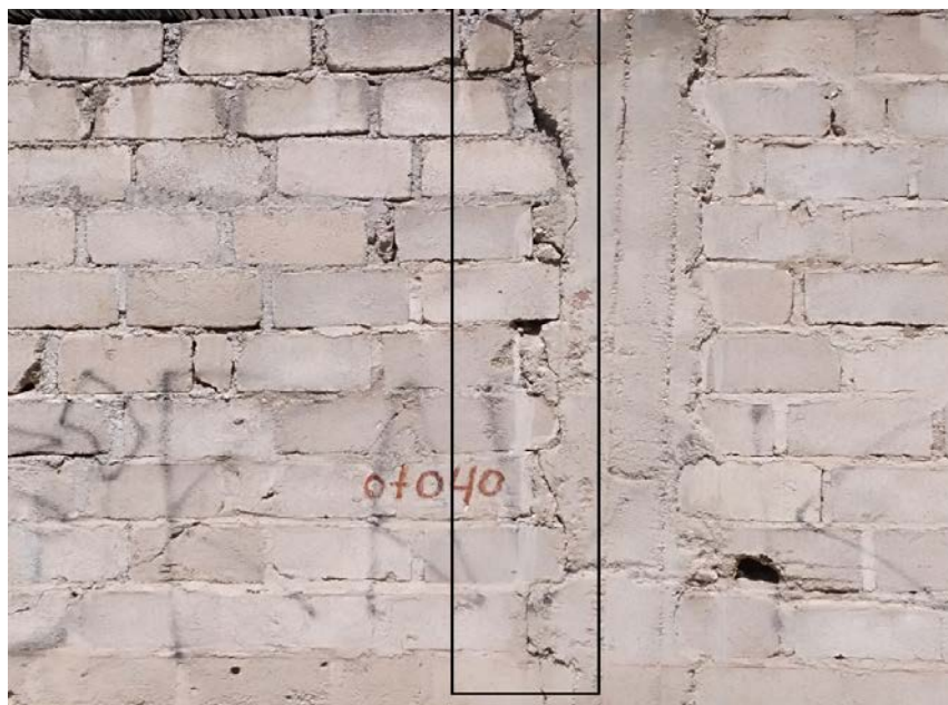
Fotografía 06: Presencia de grieta en union columna-muro - Muestra 08.
