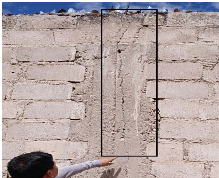
Fotografía 07: Presencia de grieta vertical en columna de Muestra 12
