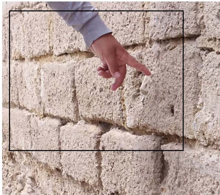
Fotografía 11: Presencia de picaduras en muro de albañilería confinada del cerco perimetrico – Muestra 13.
