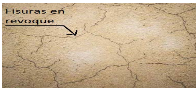
Figura 16. Fisura en revoques de muro.
