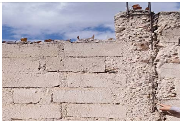
Foto 05: Oxidación de acero de refuerzo de columna.
