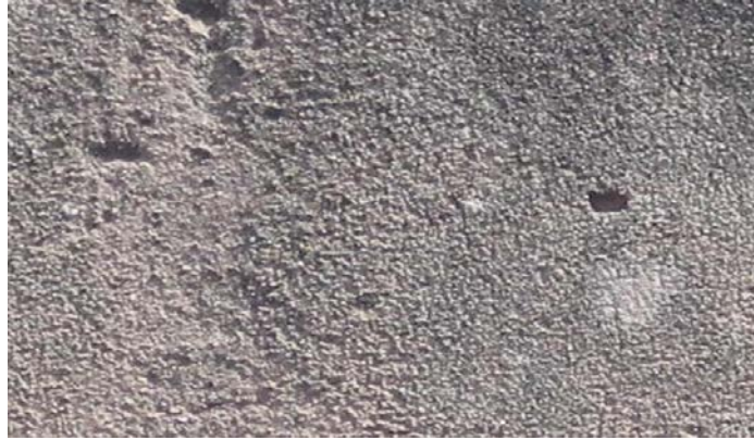
Figura 19. Picadura en concreto.
