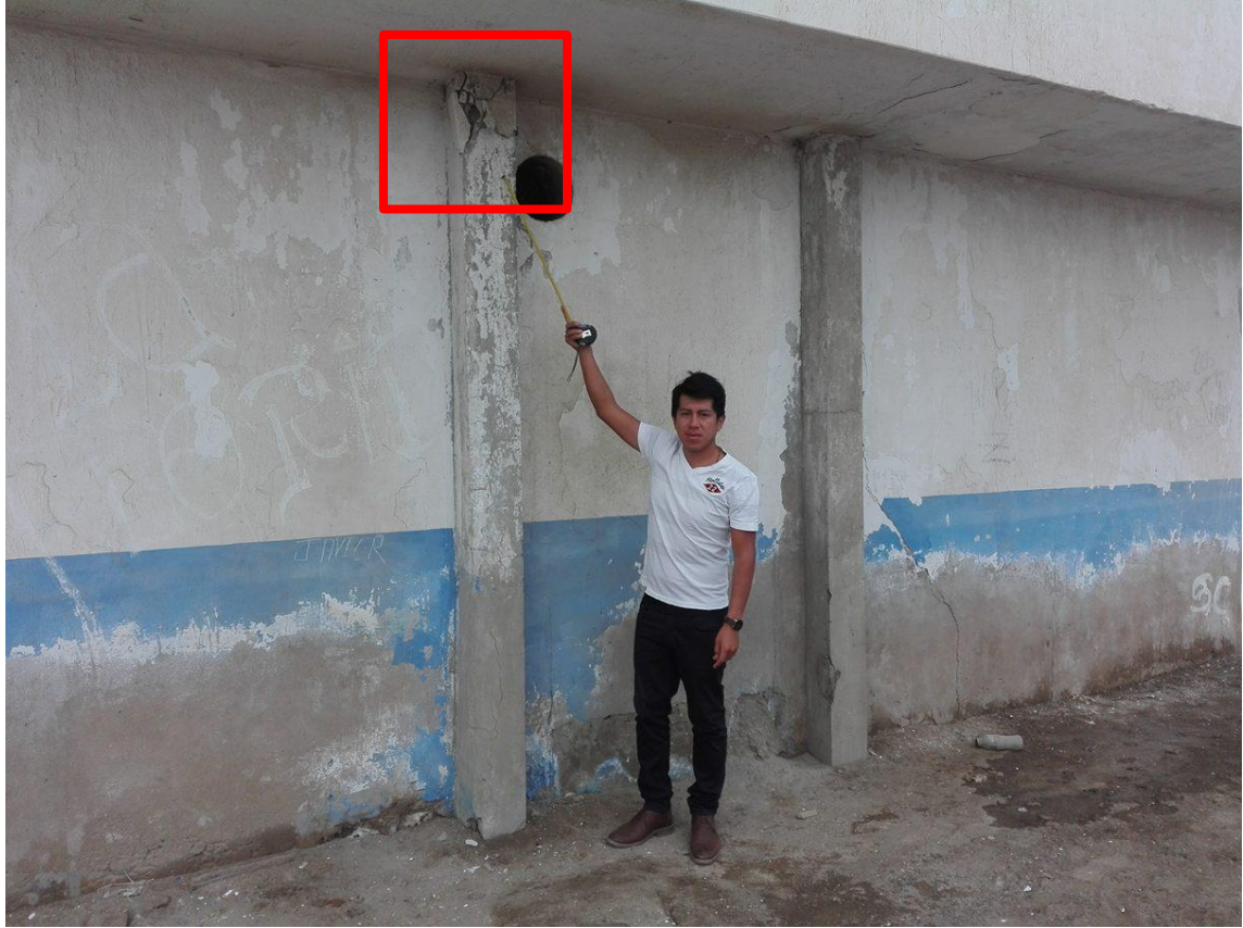
Fotografía 19: Columna reventada a causa de corrosión del fierro, es en la unidad de muestra 2.
