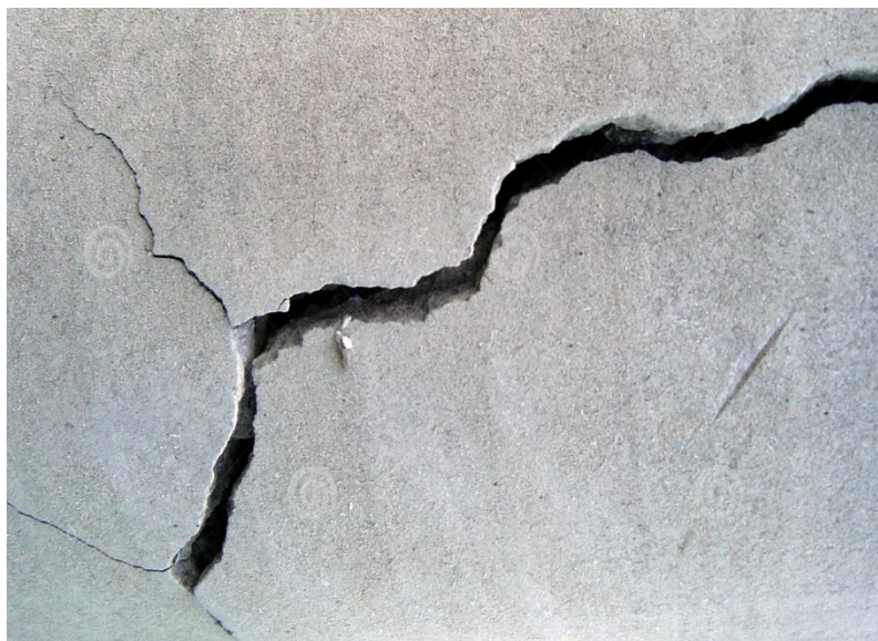
Imagen 7: Grieta en muro de albañilería.
