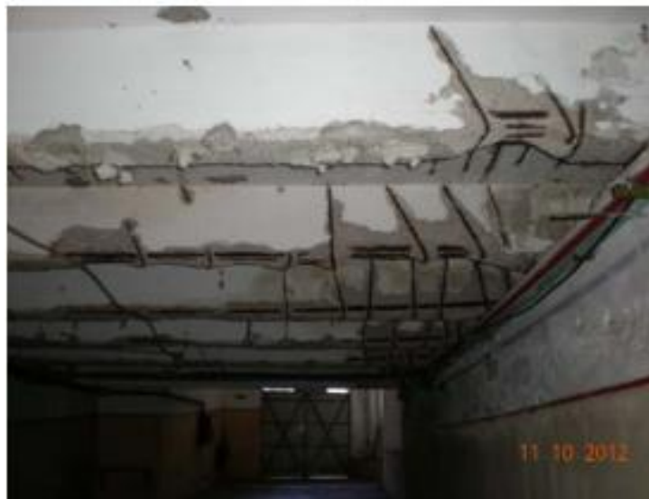
Imagen 01: Estado de la estructura de techo y viga. Nota. Fuente: Loustaunau S. y Poppolo T. (2013)
