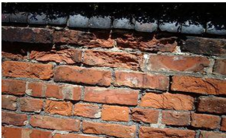
Imagen 04: Erosión en muro de albañilería. Nota. Fuente: Construmáticas.
