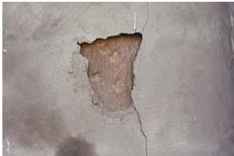
Imagen 6: Desprendimiento en muro de albañilería.
