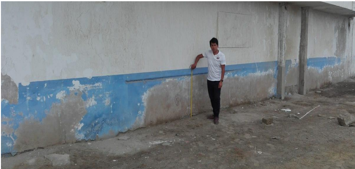
Fotografía 20: Muro con eflorescencia, se detectó en la unidad de muestra 2.
