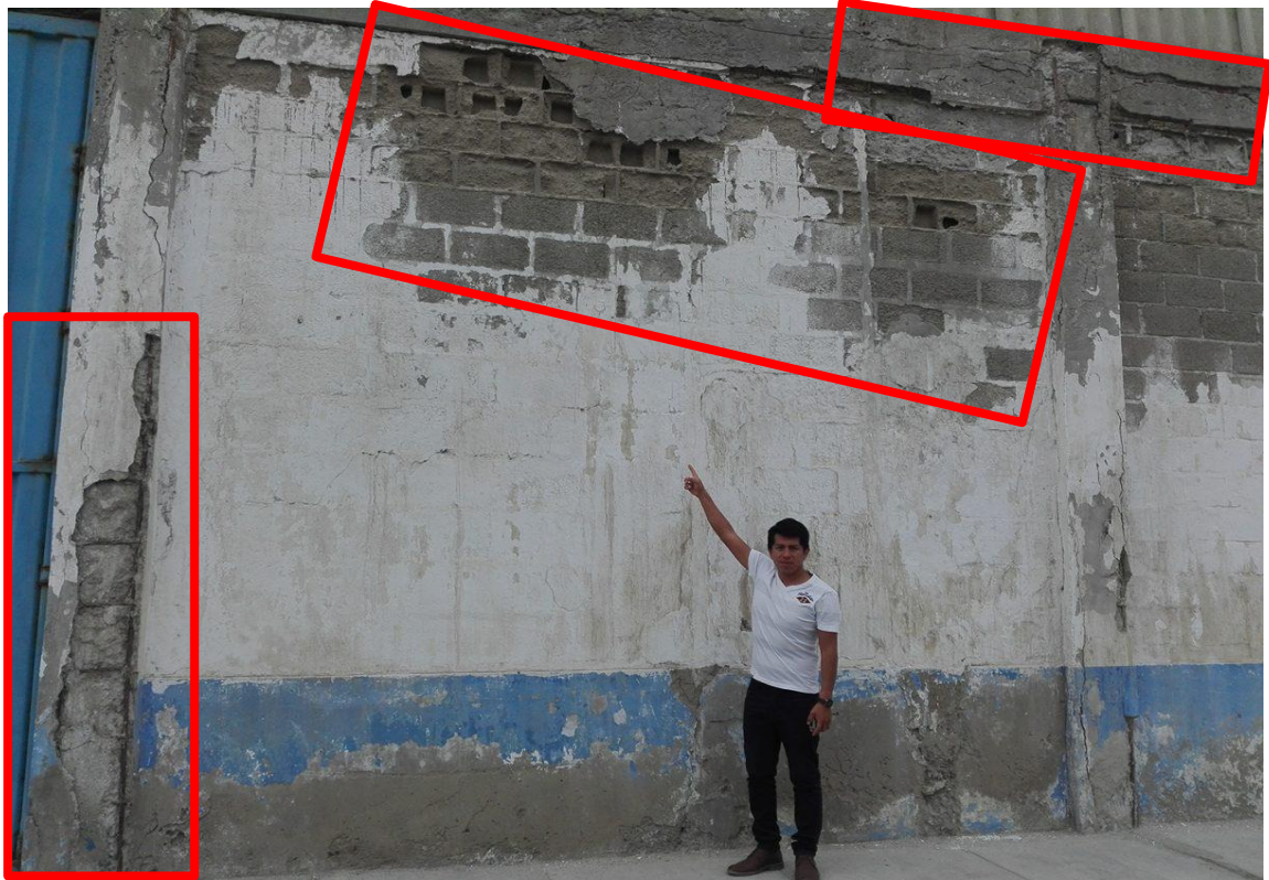
Fotografía 21: Viga, columna y muro en estado severo, se encuentra en la unidad e muestra 5.
