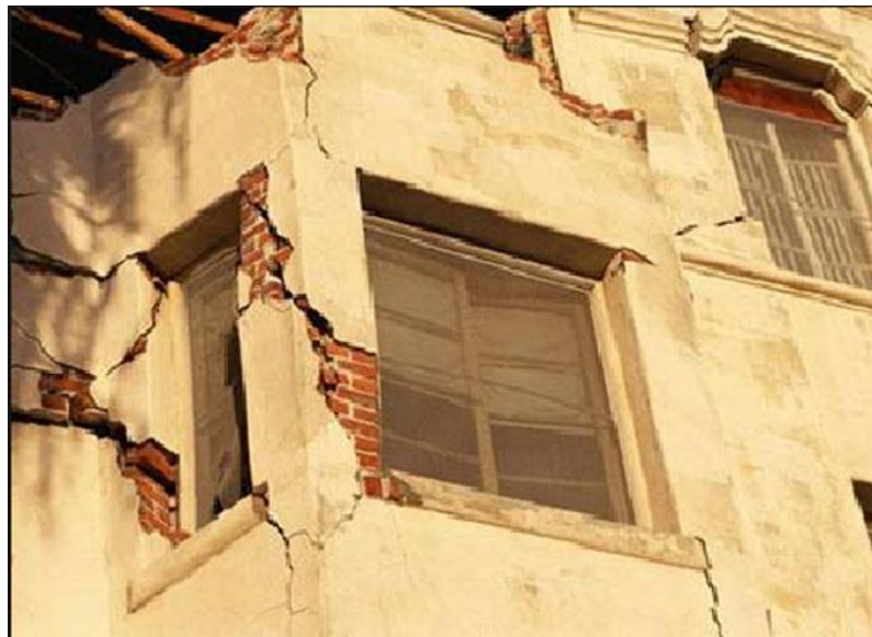
Imagen 03: Patología del concreto. Nota. Fuente: 360° en concreto
