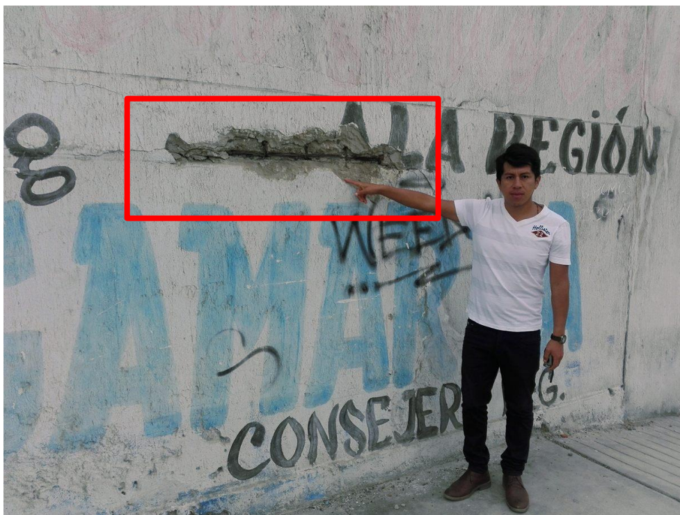
Fotografía 22: Viga en mal estado, causado por la corrosión del fierro, se unidad de muestra 11.
