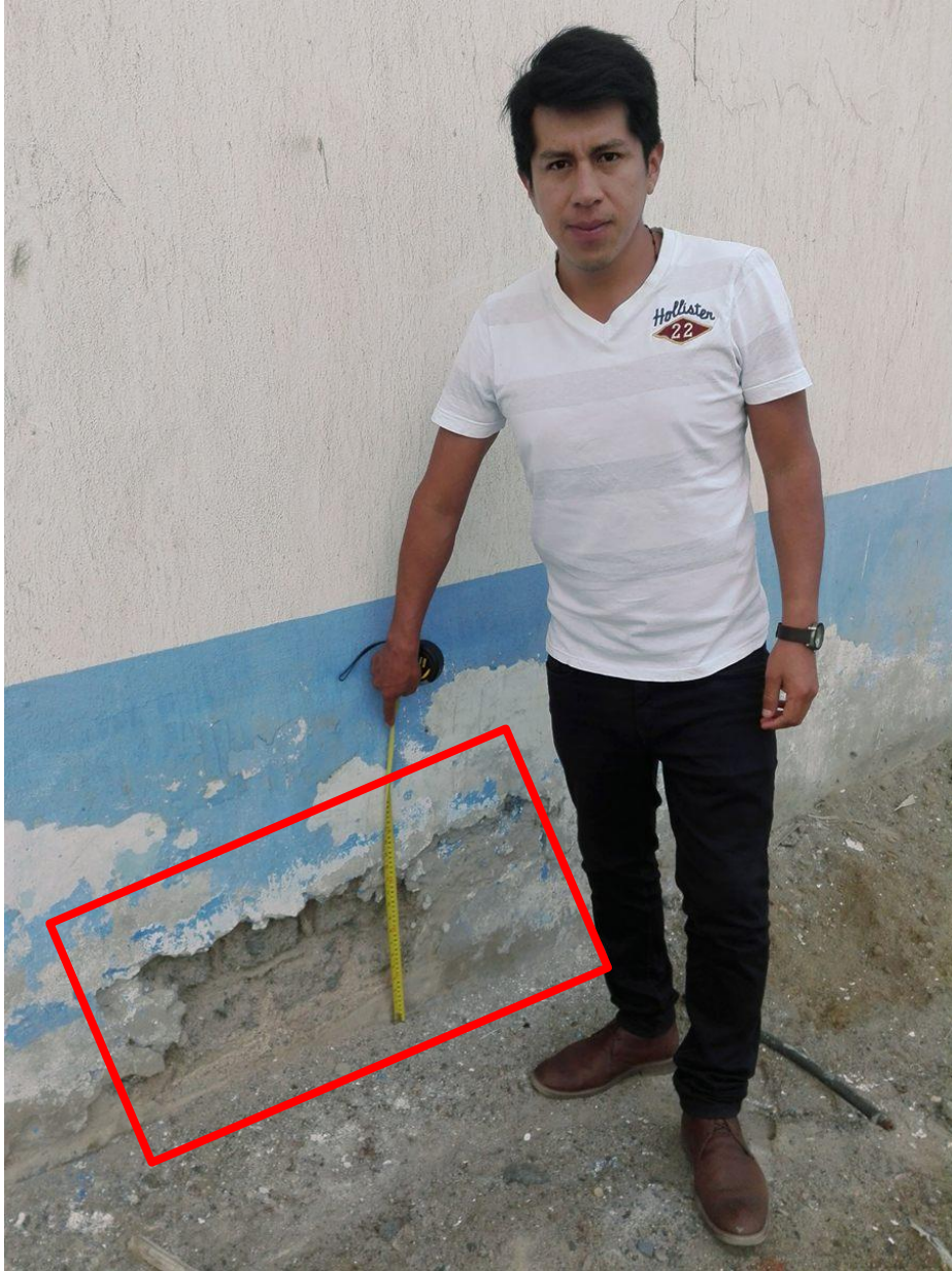
Fotografía 18: Muro en mal estado, afectado con la patología de erosión en la unidad de muestra 1.
