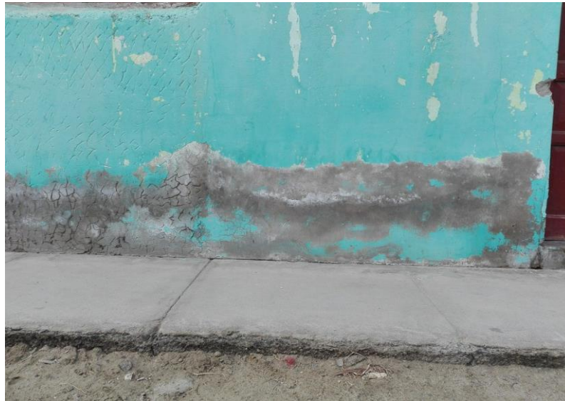
Imagen 8: Eflorescencia en muro de albañilería. Nota. Fuente propia. (2018)
