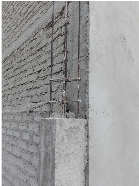
Imagen 9: Corrosión en columna de albañilería confinada. Nota. Fuente propia (2018)
