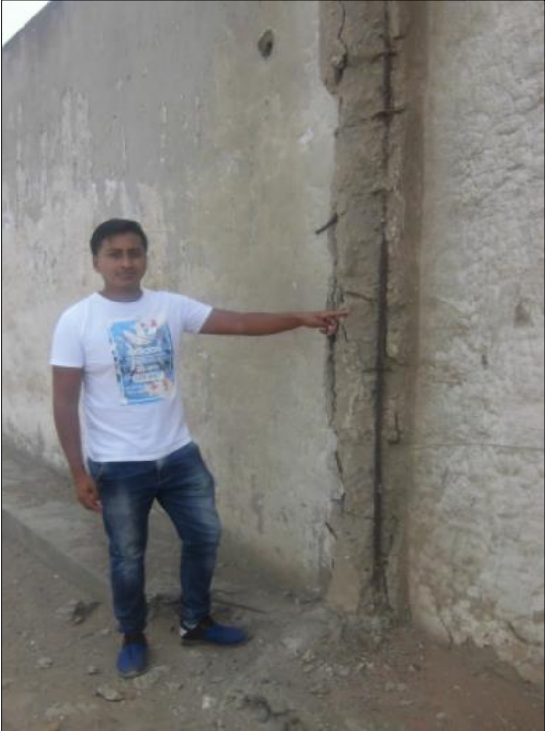
Foto 3: Acero de la columna afectado por la corrosión en la Unidad de Muestra 06.
