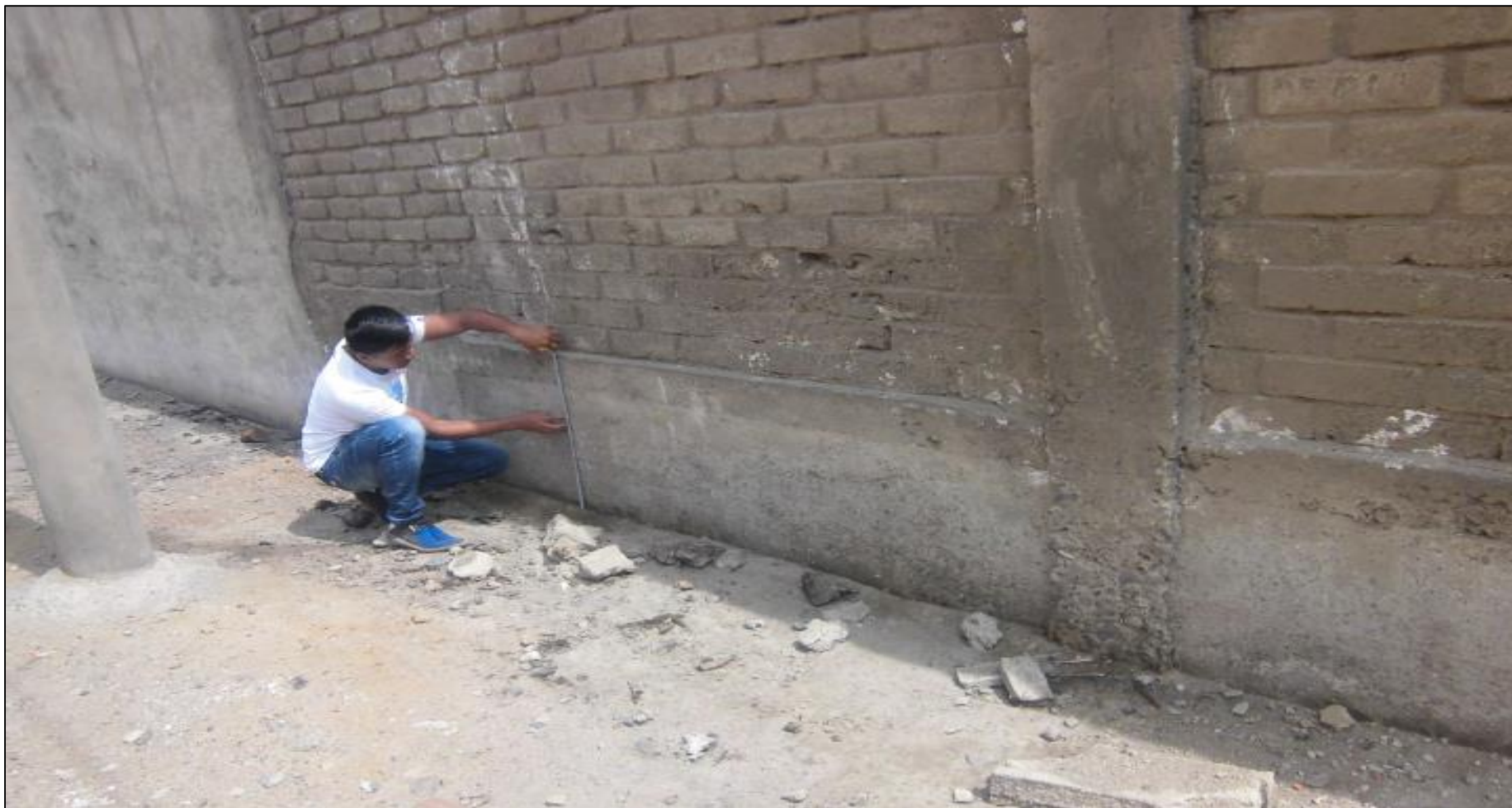
Foto 5: Sobrecimiento y albañilería afectada por la erosión en la Unidad de Muestra 09.
