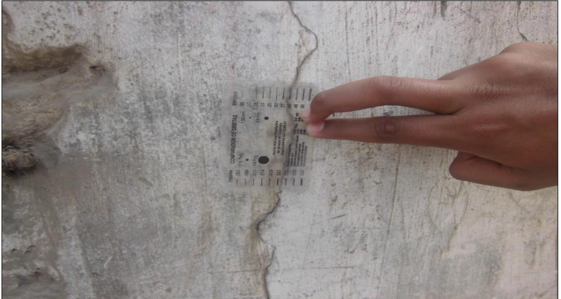
Foto 4: Determinación de fisura vertical en la Unidad de Muestra 07.
