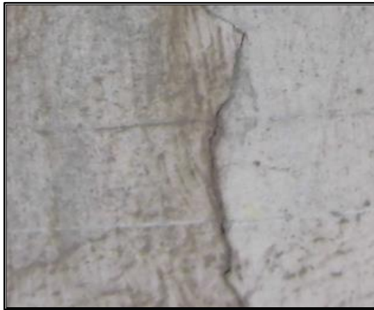
Imagen 26. Fisura Nota. Fuente: Elaboración propia
