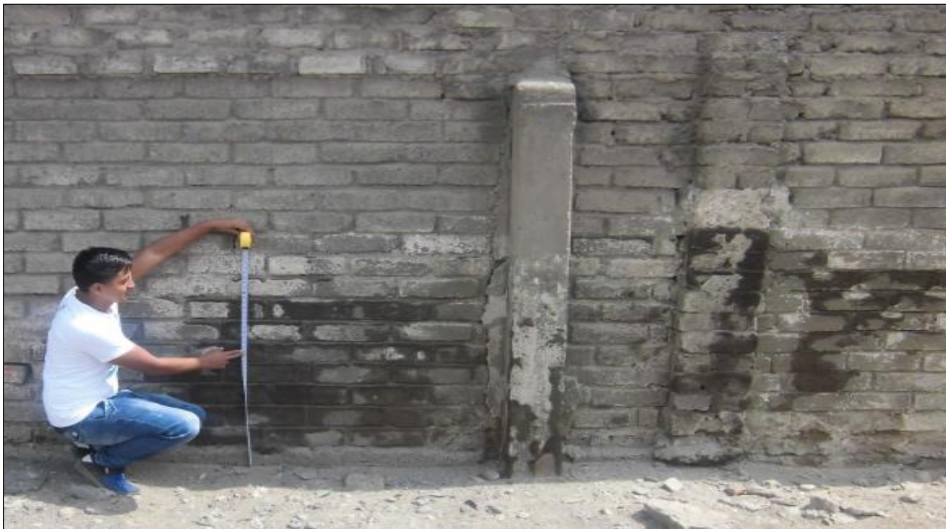
Foto 6: Albañilería y columna afectada por la eflorescencia en la Unidad de Muestra 14.
