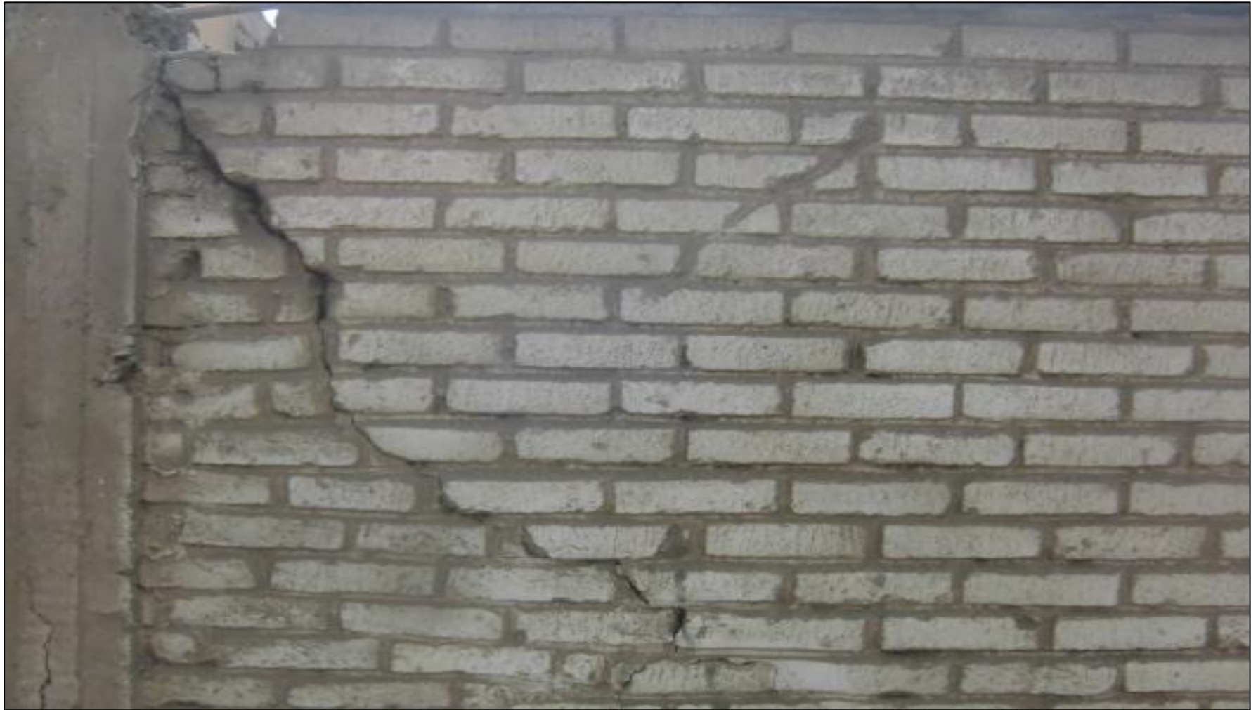
Foto 7: Albañilería afectada por una grieta producida por un asentamiento diferencial en la Unidad de Muestra 1.
